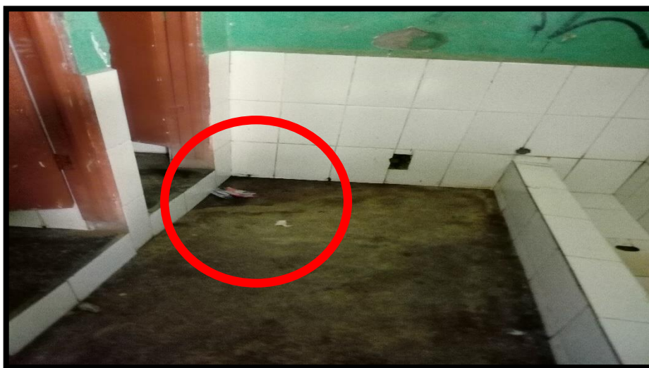
FOTOGRAFIA 5. ESTADO SITUACIONAL DE SERVICIOS HIGIENICOS
