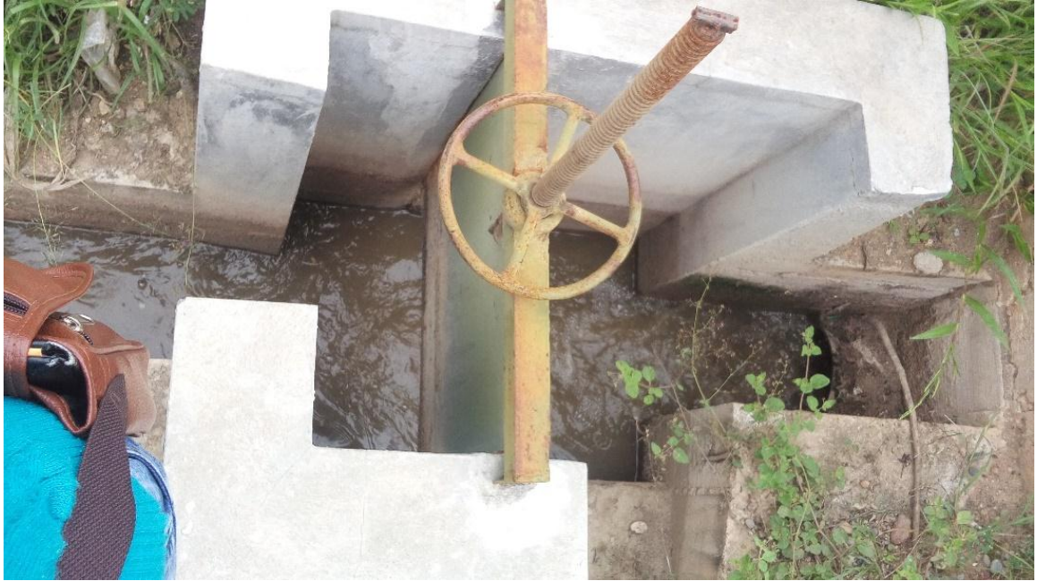
FOTOGRAFÍA 01: CRIBADO UBICADO AL INGRESO DE LA PLANTA DE TRATAMIENTO.
