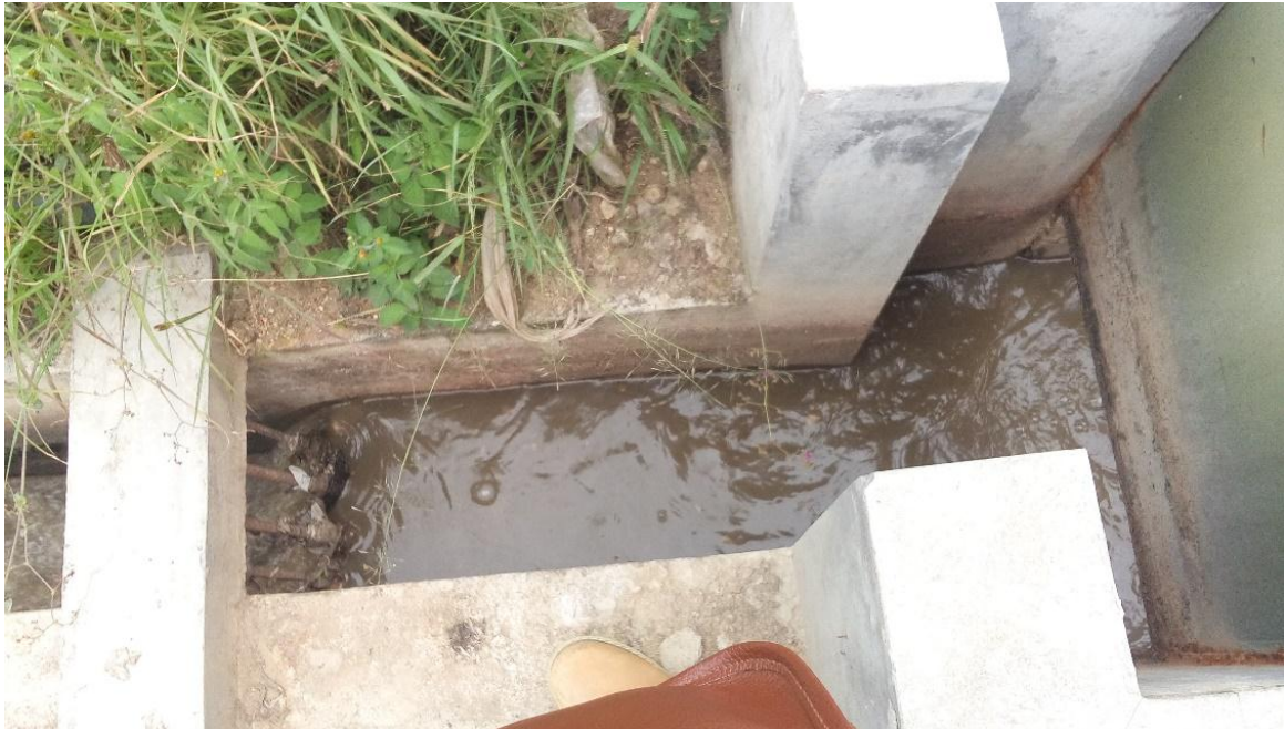
FOTOGRAFÍA 02: CRIBADO UBICADO AL INGRESO DE LA PLANTA DE TRATAMIENTO
