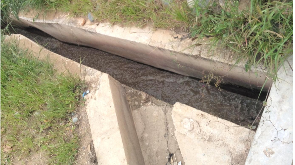
FOTOGRAFÍA 03: LÍNEA DE CONDUCCIÓN DEL AGUA CRUDA A LA PLANTA DE TRATAMIENTO
