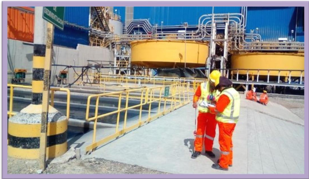
IMAGEN 32.AÑO 2017, Construcción Monorriel para puente Grúa en Cochas de Plomo y Zinc de la planta Concentradora de la Compañía Minera Alpamarca SA.
