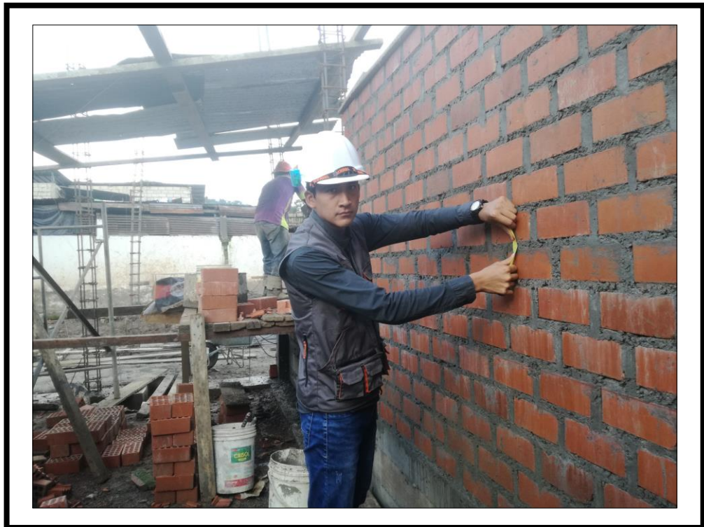
FOTOGRAFIA N° 12: Se puede observar en la fotografía tomando las dimensiones de la junta horizontal del muro (M-43).
