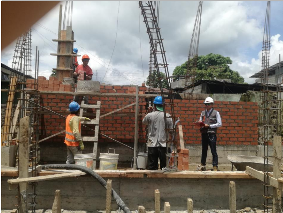
FOTOGRAFIA N° 09: Se puede observar en la fotografía la ejecución del muro (M-39) con la cuadrilla operario – peón, ejecutando la partida estudiada construcción de muro de albañilería con ladrillo King Kong 18H de arcilla colocado de saga.
