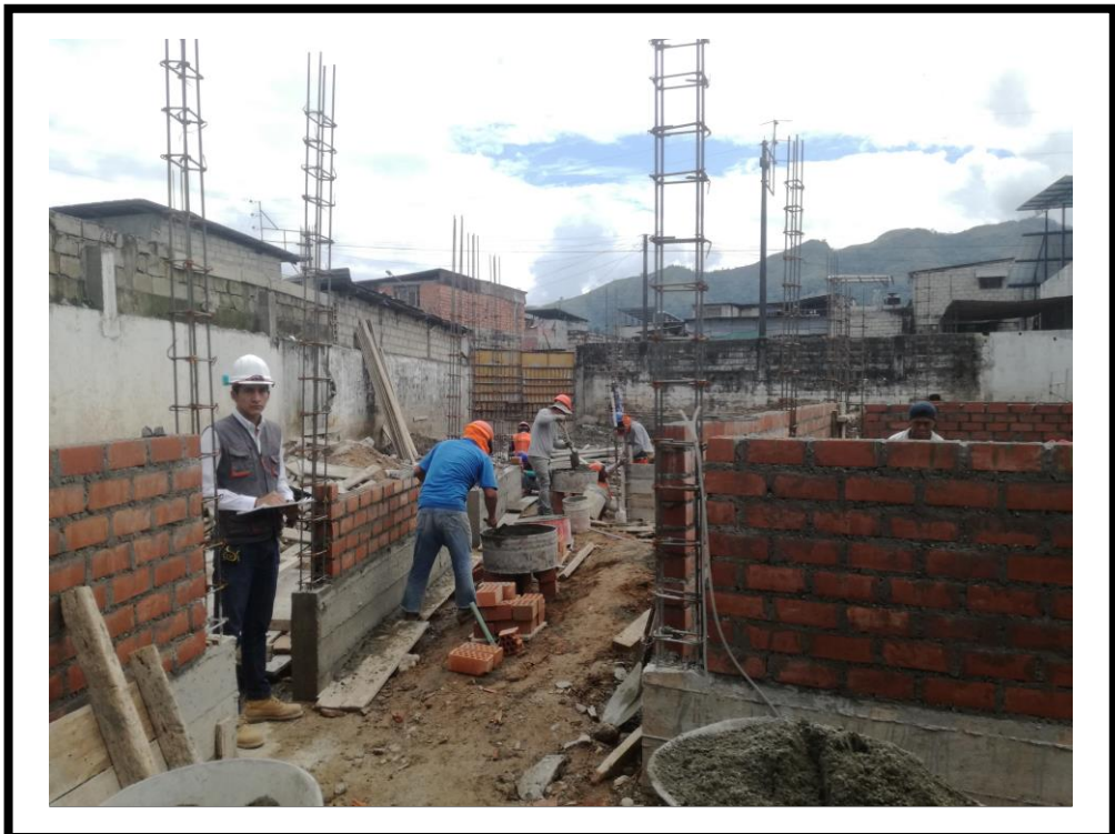
FOTOGRAFIA N° 20: Se puede observar en la fotografía la ejecución del muro (M-96) con la cuadrilla operario – peón, ejecutando la partida estudiada construcción de muro de albañilería con ladrillo King Kong 18H de arcilla colocado de saga.
