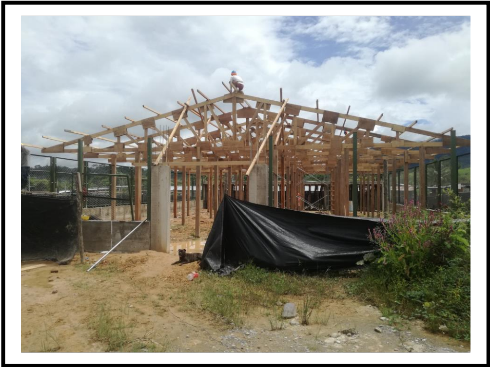
FOTOGRAFIA N° 25: Se puede observar en la fotografía la ejecución de las partidas predecesoras a las investigadas.
