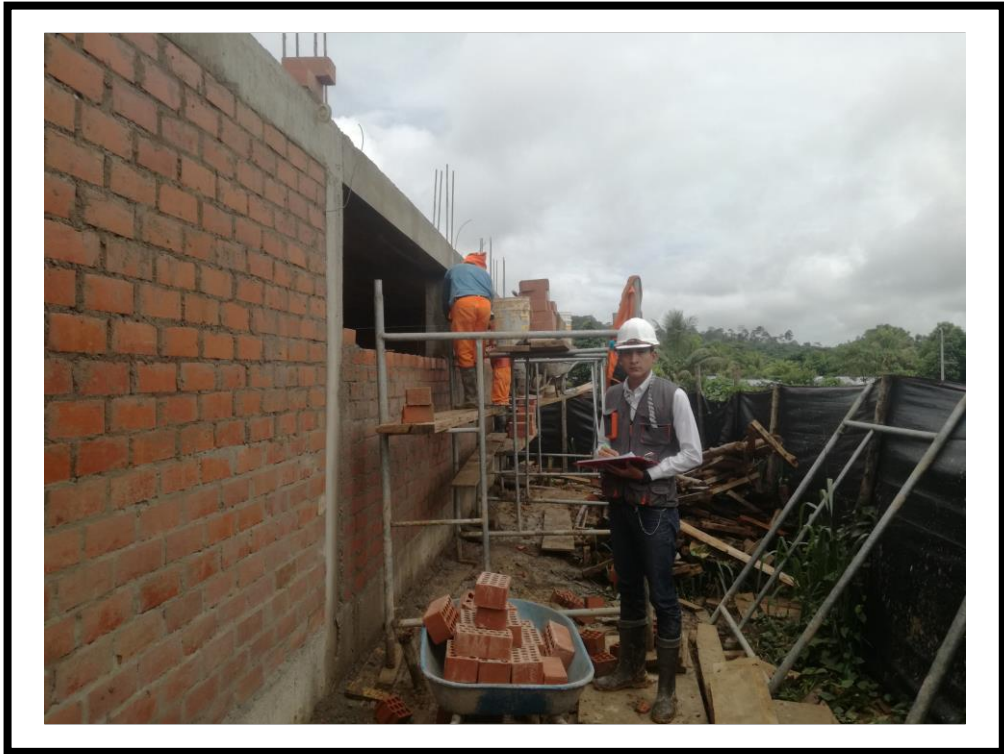
FOTOGRAFIA N° 33: Se puede observar en la fotografía la ejecución del muro (M-35, M-36, M-37) con las cuadrillas operario – peón, ejecutando la partida estudiada construcción de muro de albañilería con ladrillo King Kong 18H de arcilla colocado de soga.
