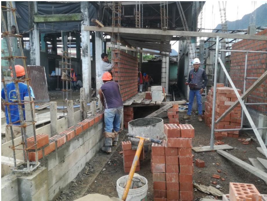
FOTOGRAFIA N° 10: Se puede observar en la fotografía la ejecución del muro (M-43) con la cuadrilla operario – peón, ejecutando la partida estudiada construcción de muro de albañilería con ladrillo King Kong 18H de arcilla colocado de saga.
