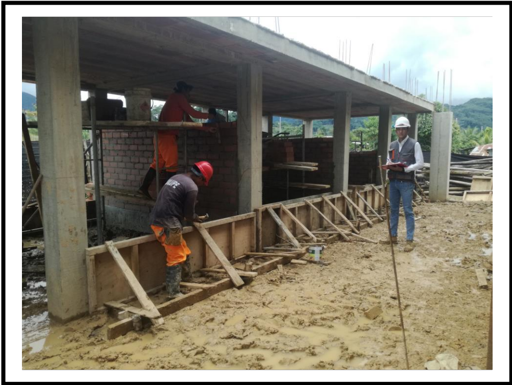
FOTOGRAFIA N° 27: Se puede observar en la fotografía la ejecución del muro (M-07) con la cuadrilla operario – peón, ejecutando la partida estudiada construcción de muro de albañilería con ladrillo King Kong 18H de arcilla colocado de soga.
