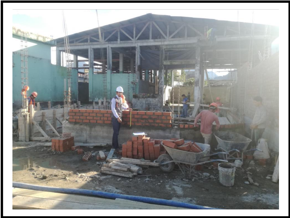
FOTOGRAFIA N° 13: Se puede observar en la fotografía la ejecución del muro (M-52, M-53) con la cuadrilla operario – peón, ejecutando la partida estudiada construcción de muro de albañilería con ladrillo King Kong 18H de arcilla colocado de soga.
