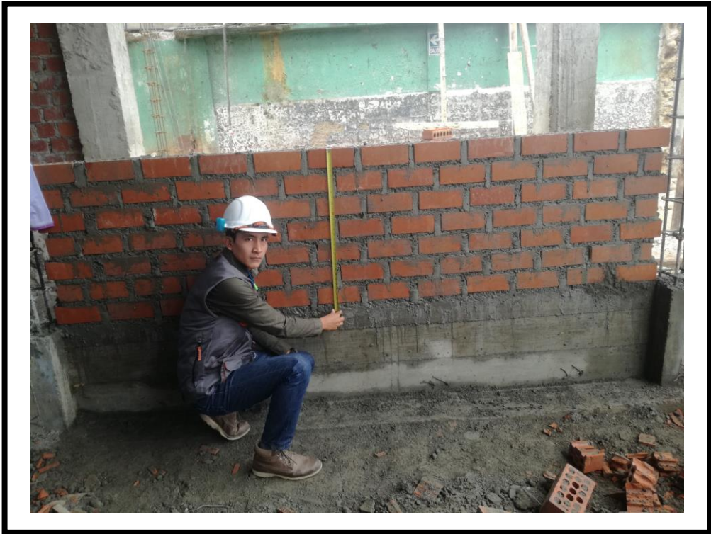
FOTOGRAFIA N° 07: Se puede observar en la fotografía tomando las dimensiones del muro (M-31) para medir el avance diario del personal.
