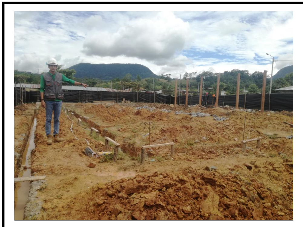
FOTOGRAFIA N° 24: Se puede observar en la fotografía la ejecución de las partidas predecesoras a las investigadas.
