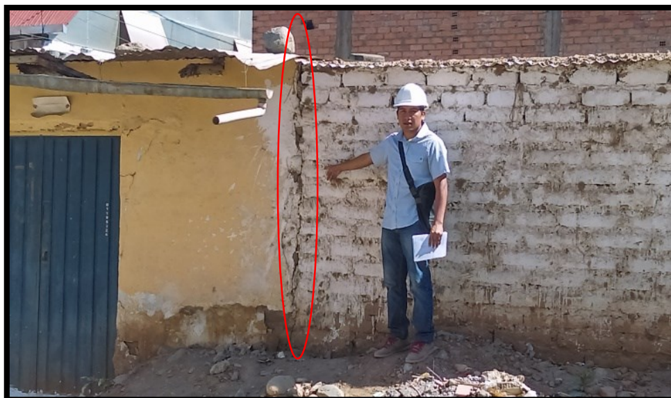
Agrietamiento producido por el mal confinamiento de los muros.
