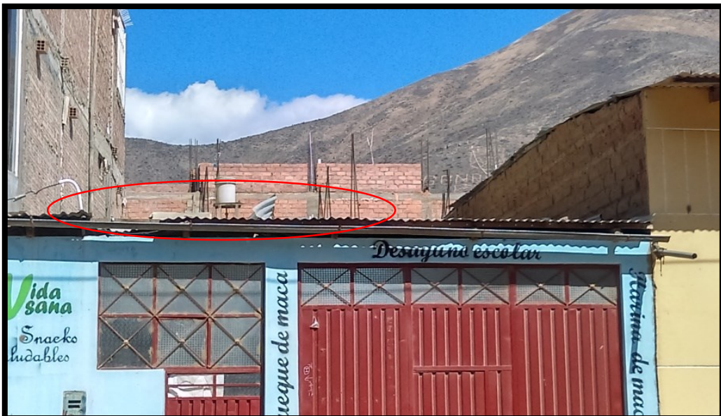
Calamina en mal estado de conservación, desprendiéndose una parte de ella.
