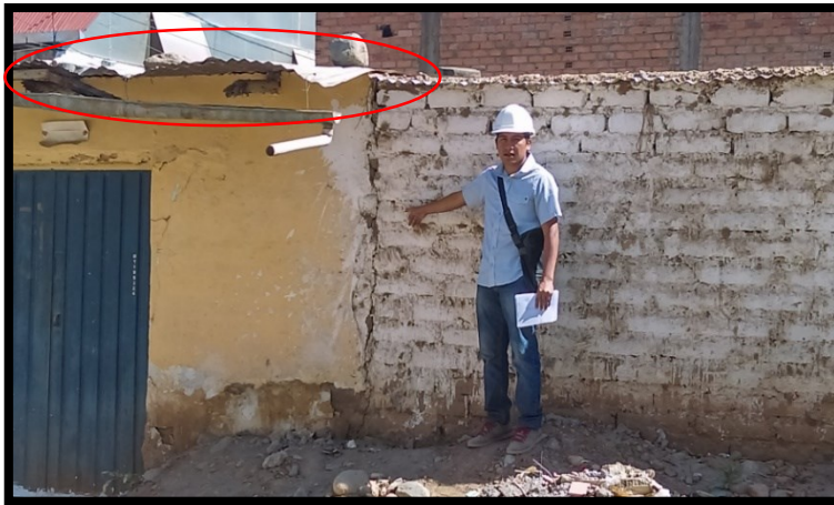
Cubierta de calamina deteriorada y mal confinamiento de muros.
