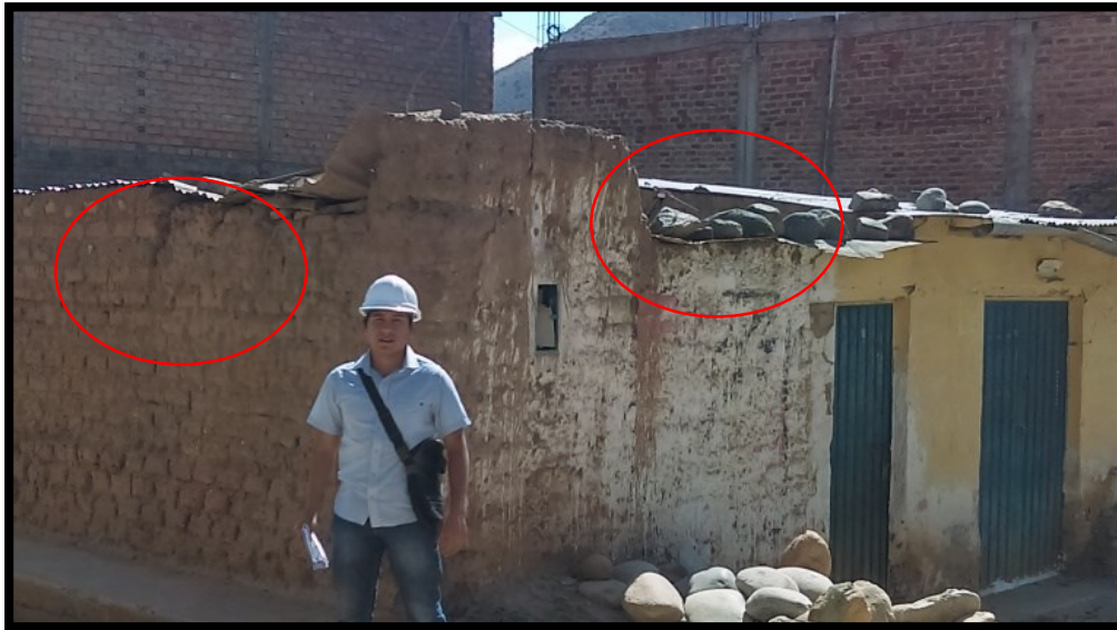
Mampostería de Adobe de mala calidad, susceptible al agrietamiento
