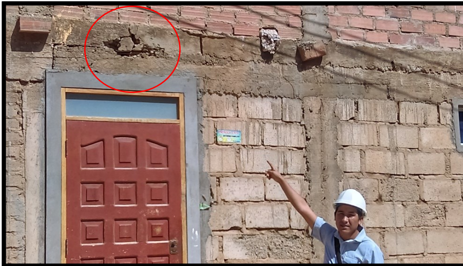
Presencia de cangrejas en la vida de refuerzo.
