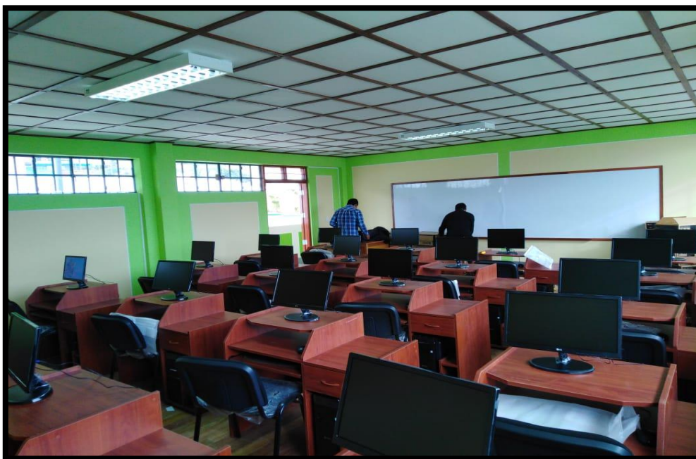
Fotografía N°5: Se observa la instalación de las computadoras para la sala de cómputo ubicados en el segundo nivel del Pabellón N°1.
