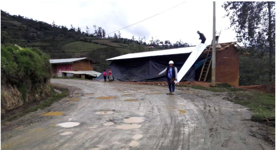
Figura 8. Presencia de Baches con profundidades de 0.10 m.
