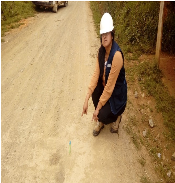
Figura 88 M-03 Fisura longitudinal leve 1.80m y Desprendimiento de finos 4.80%.
