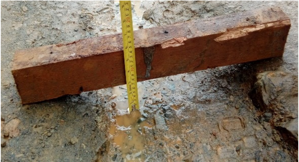
Figura 5. Erosión de la Carretera
