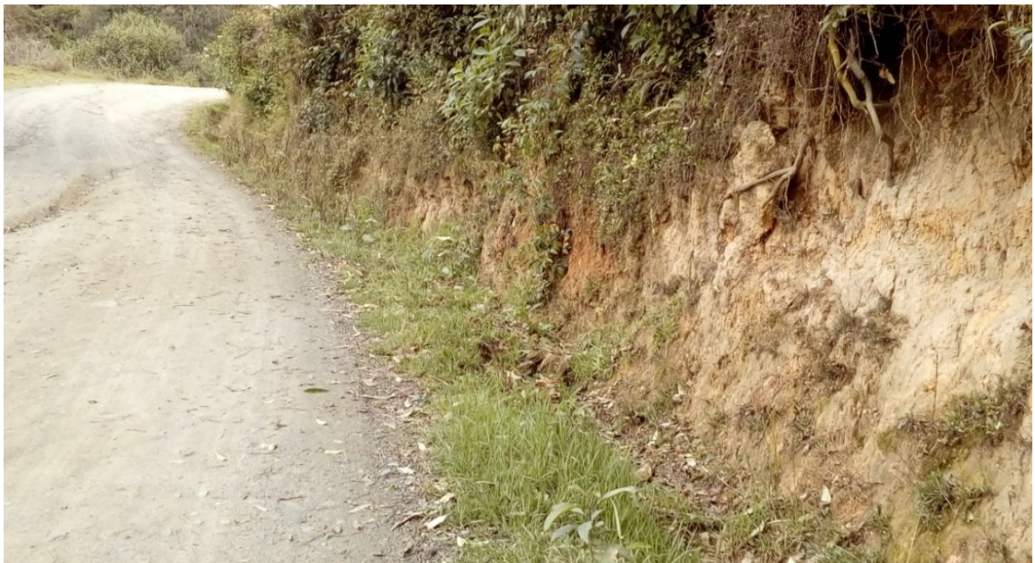
Figura 6. Erosión Tipo 2, Profundidad 7 cm
