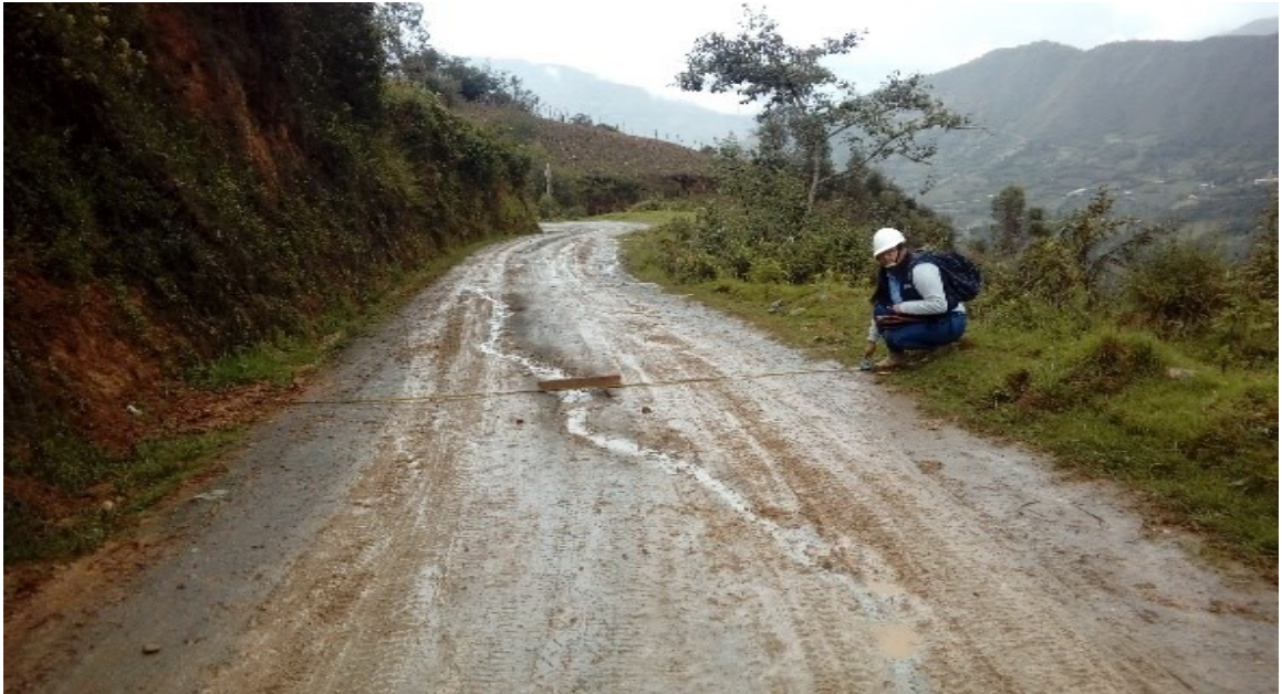
Figura 7. Colmatación de Cunetas
