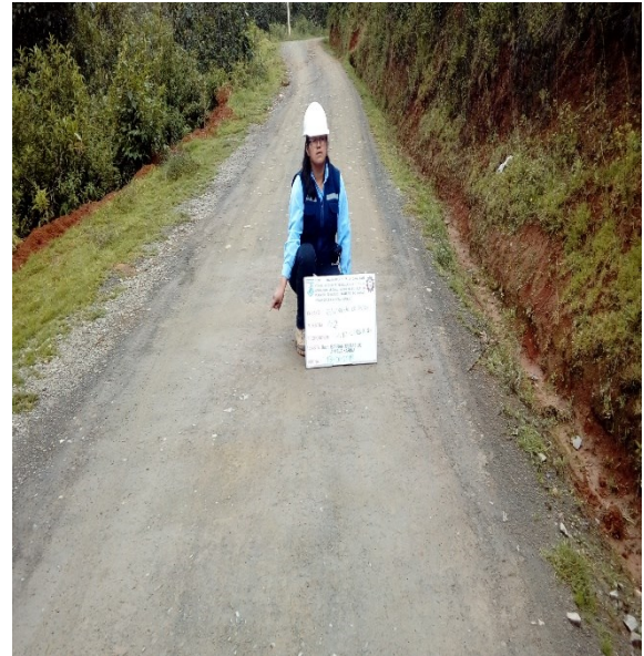
Figura 91 M-02 Fisura longitudinal leve 1.70m, fisura transversal leve 0.35m y Desprendimiento de finos 20.06%.
