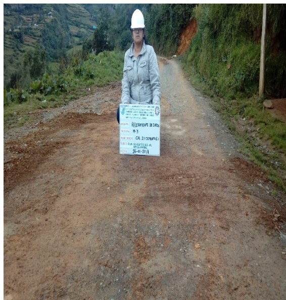
Figura 100 M-03 Fisura longitudinal leve 4.10m, fisura transversal leve 0.30m y Desprendimiento de finos 23.68%.
