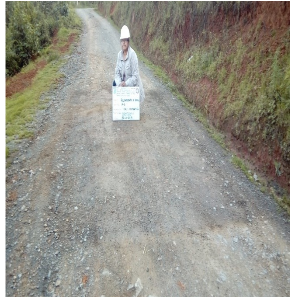
Figura 99 M-02 Fisura longitudinal leve 6.50m, fisura transversal leve 1.65m y Desprendimiento de finos 46.08%.
