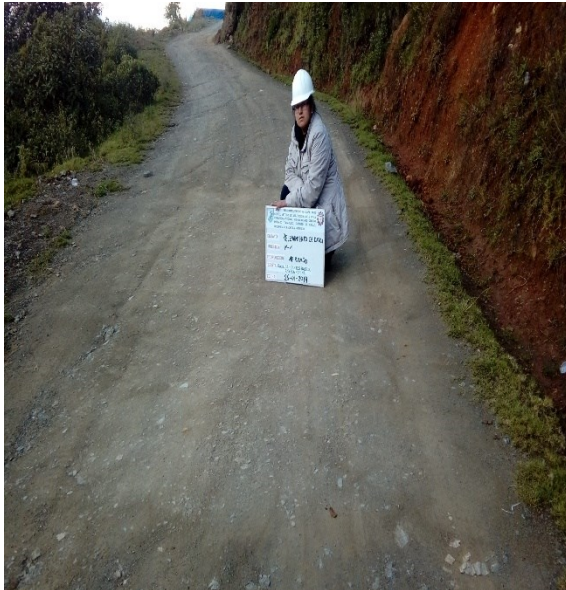
Figura 98 M-01 Fisura longitudinal leve 13.80m, fisura transversal leve 5.60m y Desprendimiento de finos 60.80%.
