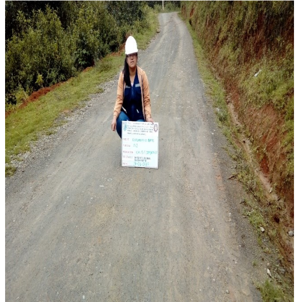
Figura 95 M-02 Fisura longitudinal leve 1.95m, fisura transversal leve 0.50m y Desprendimiento de finos 44.24%.
