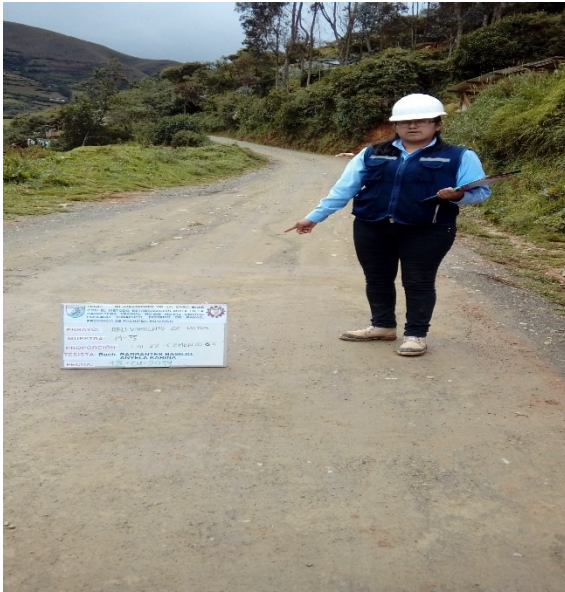
Figura 90 M-01 Fisura longitudinal leve 12.50m, fisura transversal leve 5.05m y Desprendimiento de finos 35.68%.
