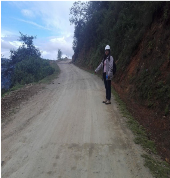
Figura 82 M-01 Fisura longitudinal leve 6.80m, fisura transversal leve 2.70m y Desprendimiento de finos 19.20%
