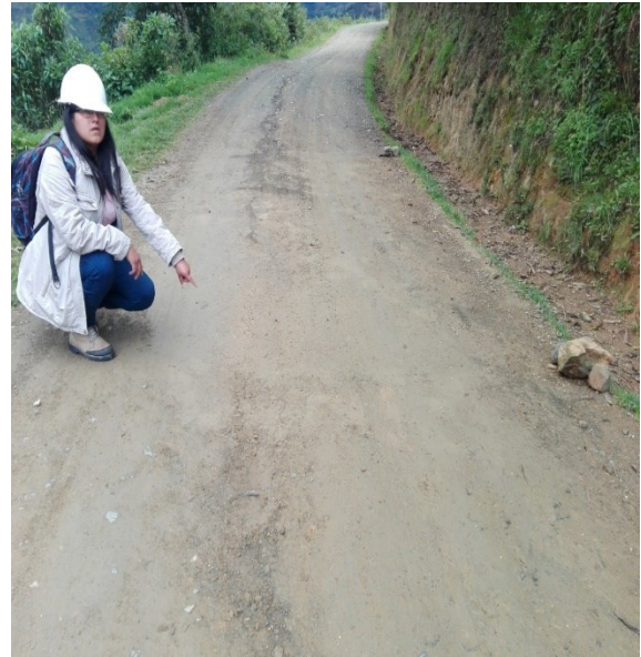
Figura 83 M-02 Desprendimiento de finos 14.64%
