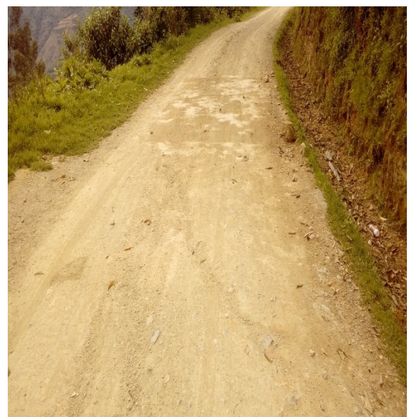
Figura 89 M-04 Fisura longitudinal leve 0.70m, fisura transversal leve 0.15m y Desprendimiento de finos 5.68%.
