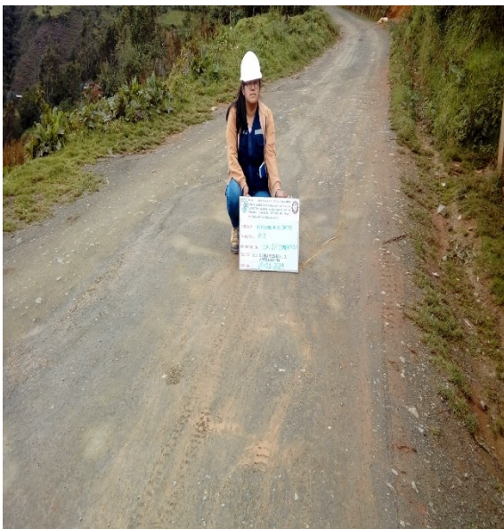
Figura 96 M-03 Fisura longitudinal leve 2.10m, fisura transversal leve 0.30m y Desprendimiento de finos 13.66%.
