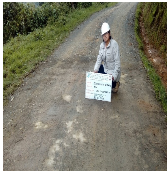
Figura 101 M-04 Fisura longitudinal leve 2.50m, fisura transversal leve 0.40m y Desprendimiento de finos 22.00%.
