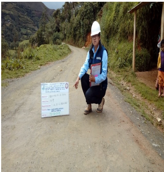
Figura 92 M-03 Fisura longitudinal leve 1.95m, fisura transversal leve 0.30m y Desprendimiento de finos 6.94%.
