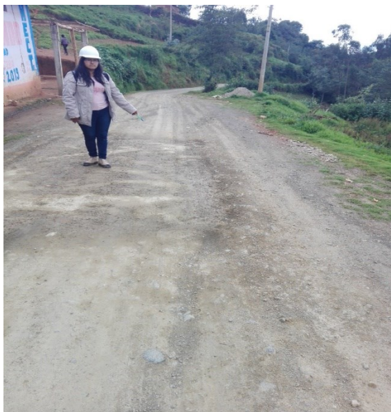
Figura 84 M-03 Desprendimiento de finos 0.96%
