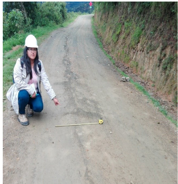
Figura 85 M-04 Desprendimiento de finos 1.44%
