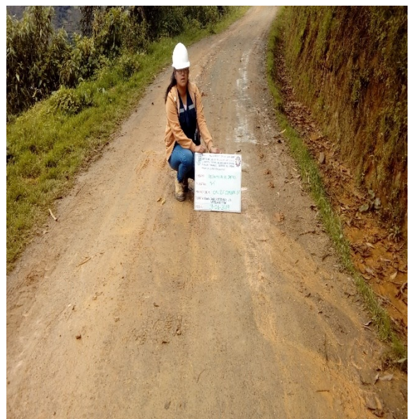
Figura 97 M-04 Fisura longitudinal leve 0.90m, fisura transversal leve 0.20m y Desprendimiento de finos 12.64%.
