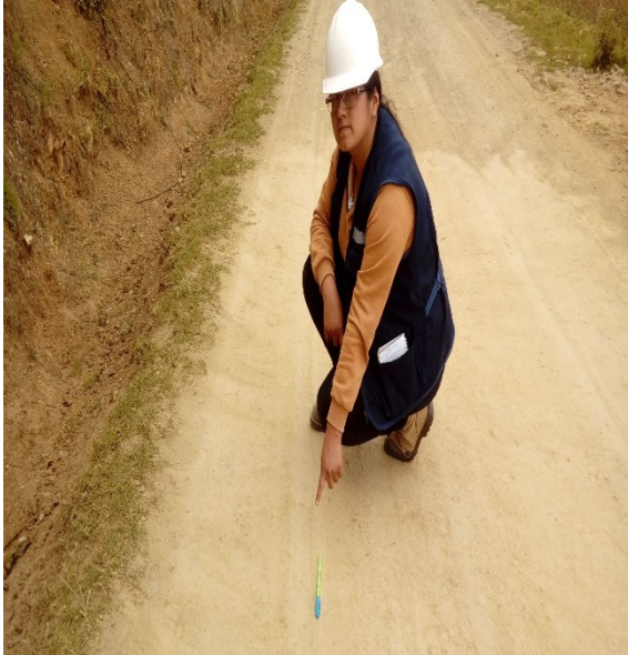
Figura 86 M-01 Fisura longitudinal leve 10m, fisura transversal leve 4.30m y Desprendimiento de finos 25.20%
