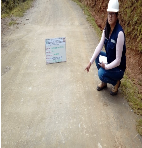
Figura 94 M-01 Fisura longitudinal leve 13.20m, fisura transversal leve 5.60m y Desprendimiento de finos 47.36%.
