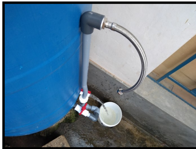
Figura 53: Instalación en campo de nuestro sistema - experimentación
