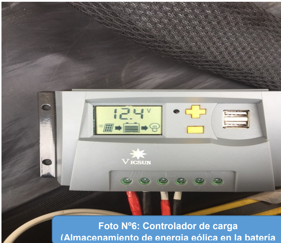
Foto N°5: Monitoreo y toma de datos del almacenamiento de energía
