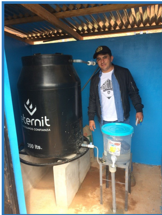
Tanque elevado con su balde para la cloración por goteo del reservorio 01 zona A.
