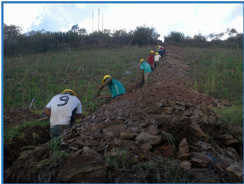
Personal obrero en excavación manual de zanjas para las redes de agua potable.
