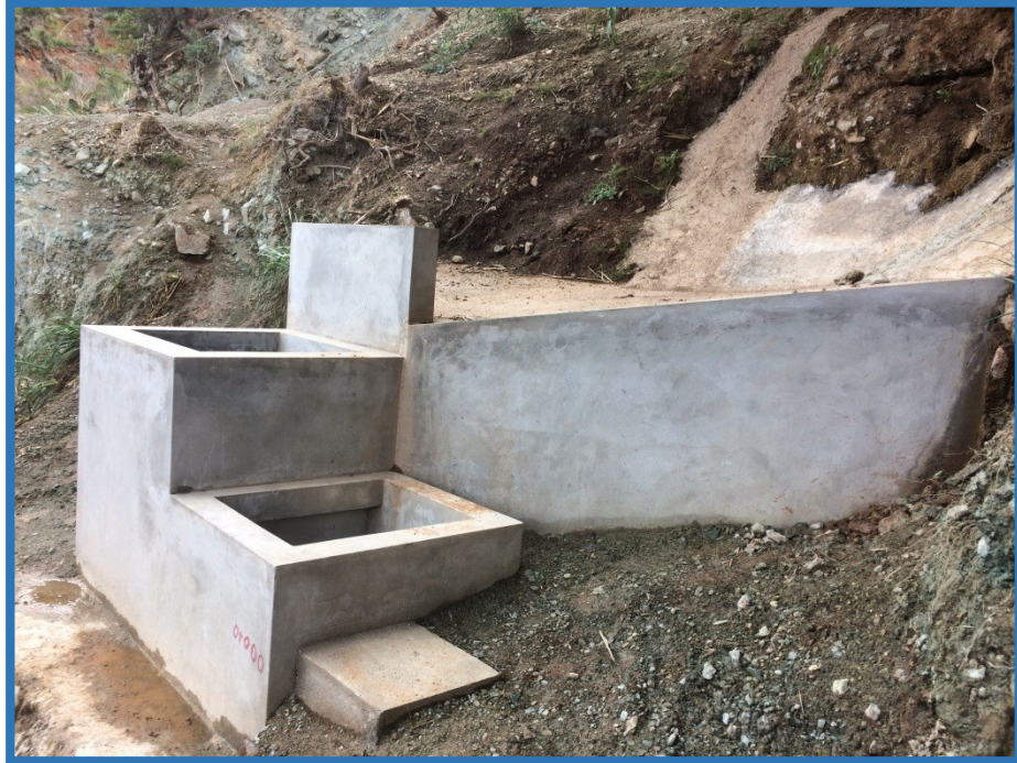
Captación 03 zona B.
