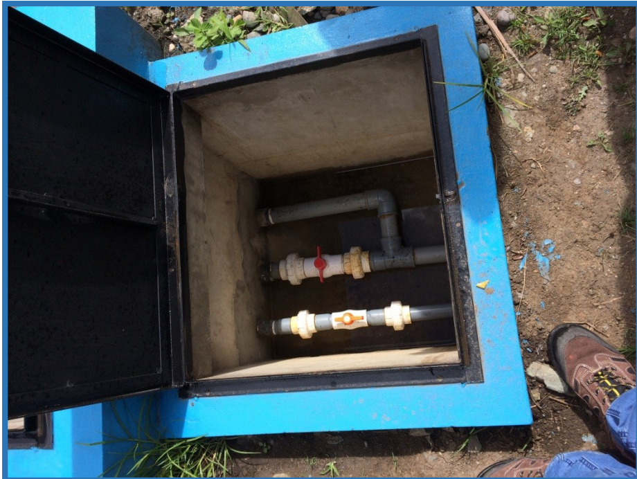
Verificación de las válvulas de PVC en las cajas distribuidoras de las captaciones.
