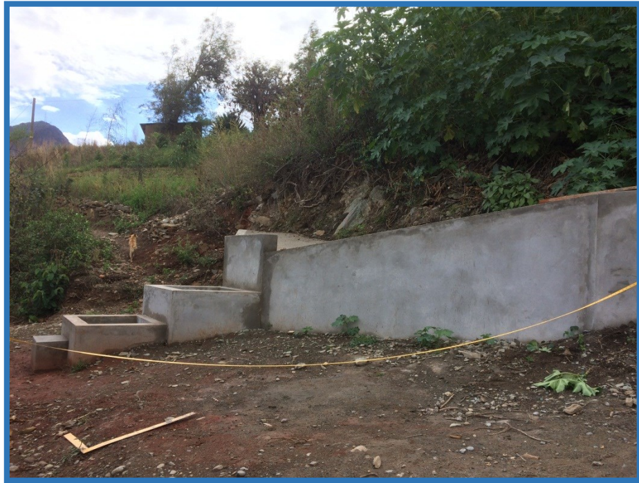
Captación 02 zona A.
