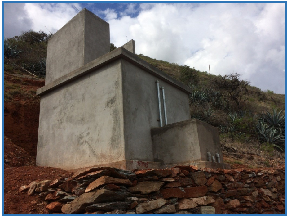
Reservorio 01 zona A.
