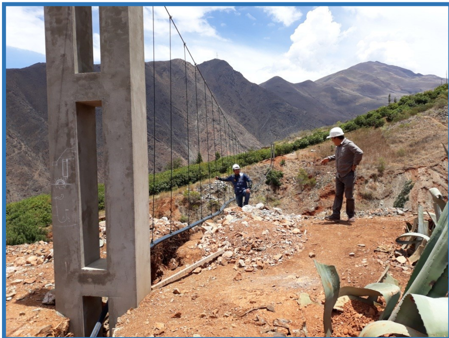
Presencia del residente y asistente viendo como quedo el tendido de péndolas en los pases aéreos.
