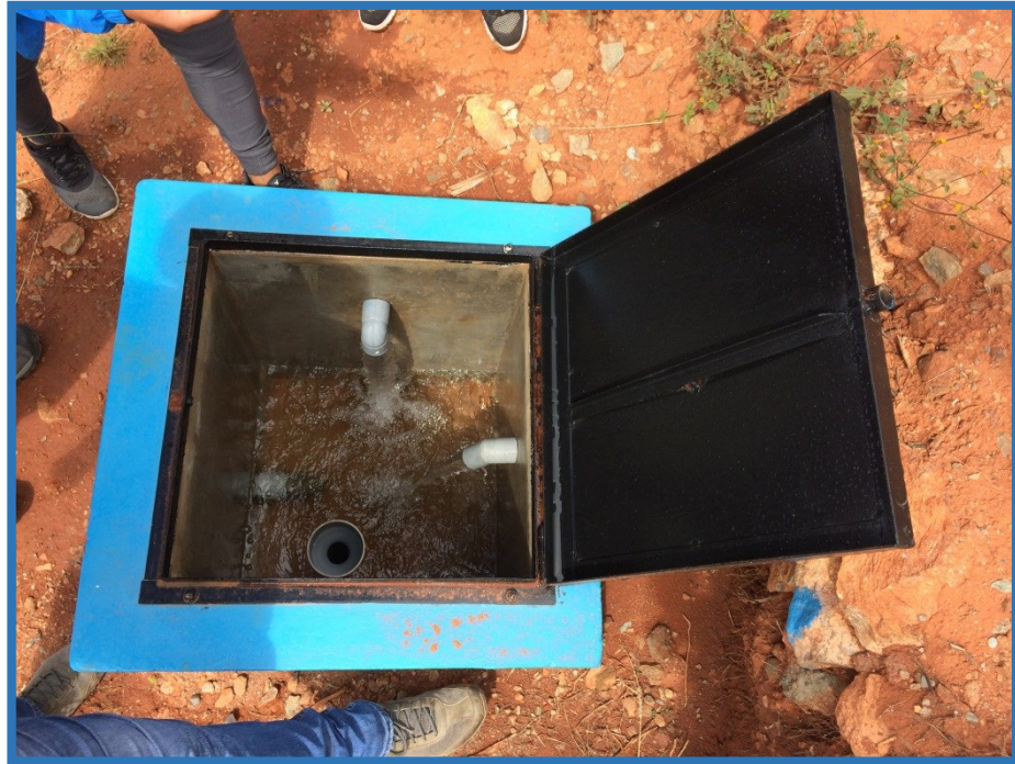
Caja de reunión de agua de captación 01 y 02 que llevara al reservorio 01 de la zona A.
