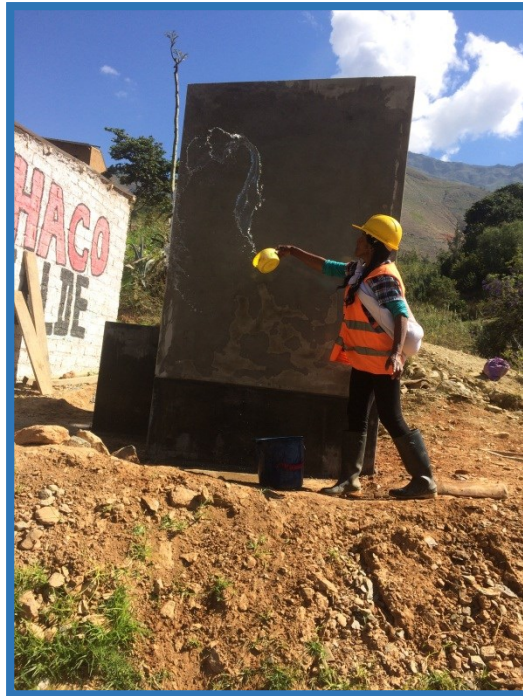
Curado con agua al Tarrajeo de Muros y lavaderos en los respectivos UBS.
