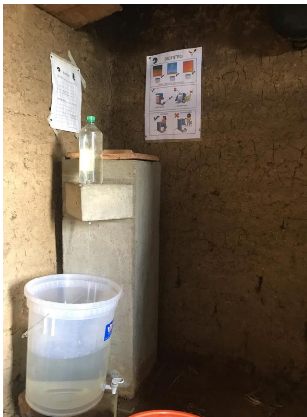
Figura 22. Filtro de Bioarena instalada
