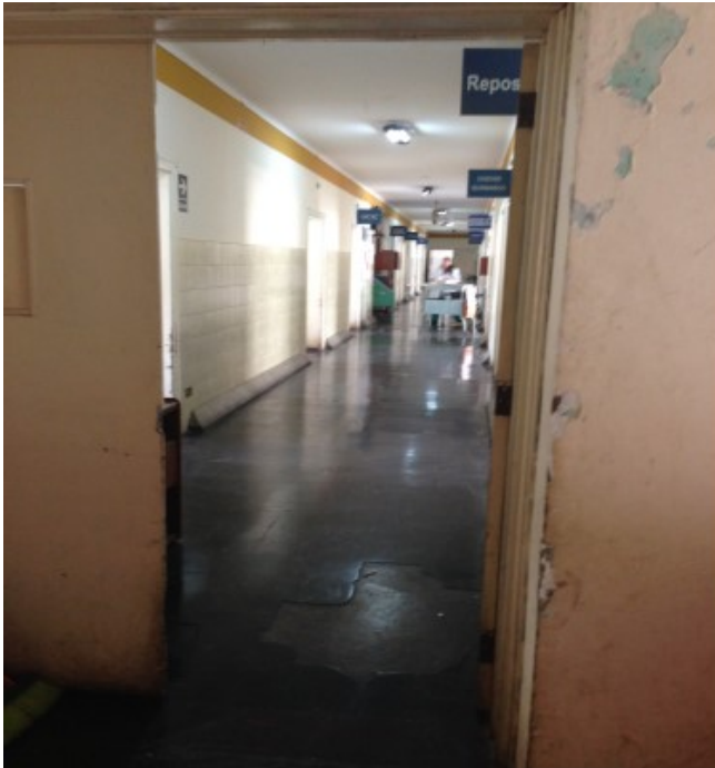
Fig.1. Pasillo del Servicio de Cirugía, Ambiente con infraestructura dañada
