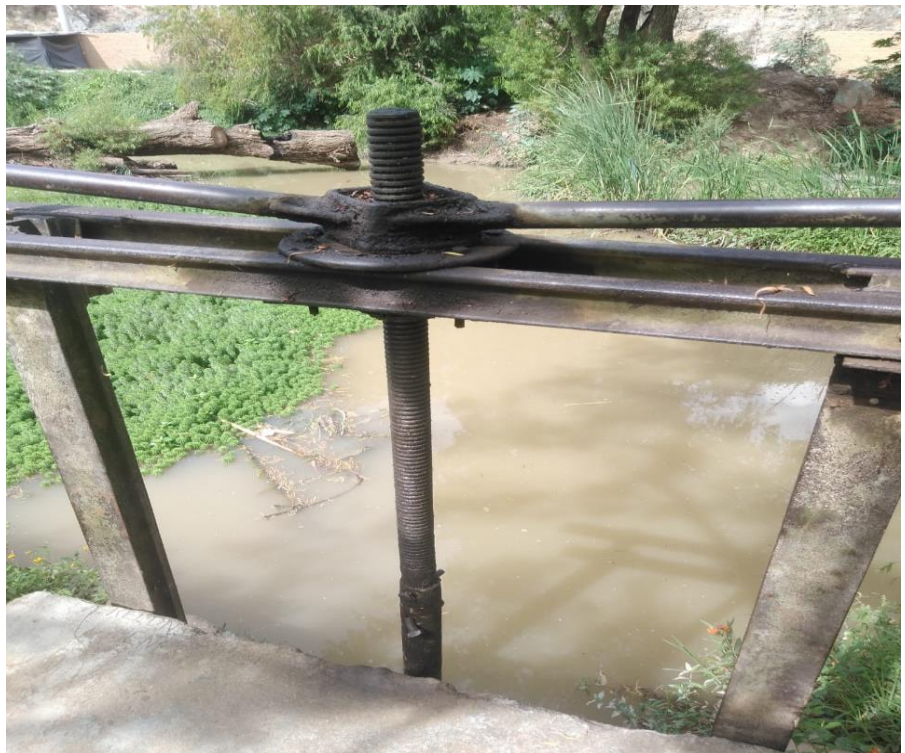
Figura 17: Compuerta de ingreso de agua del río Huallaga al canal de riego.
