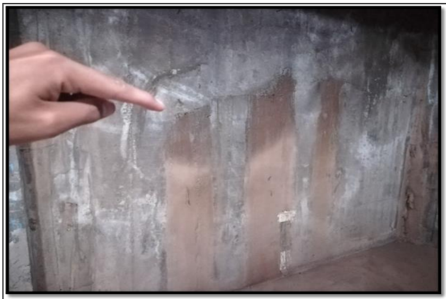
Foto n° 3 Muro de sótano con presencia de filtración
