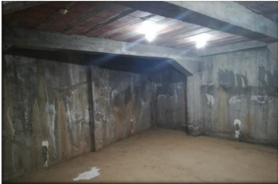
Foto n° 1 Muros de sótano debilitado por filtraciones
