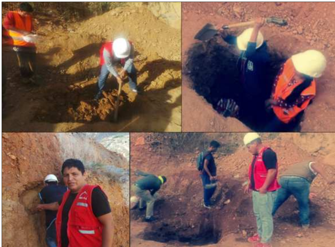
Fotografía 3: Extracción de muestras de suelo alteradas e inalteradas del punto de exploración del área delimita en la parte alta del A.A.H.H. la Florida – Huánuco.
