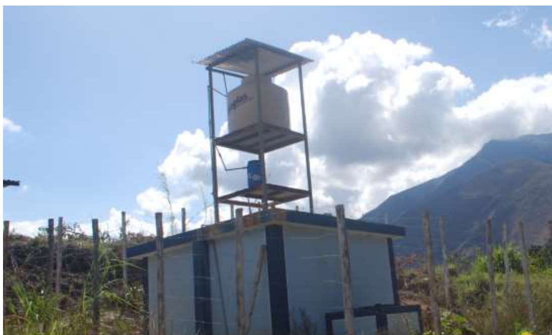
Figura 17. Vista fotográfica del Sistema de Cloración del Centro Poblado Las Palmeras.
