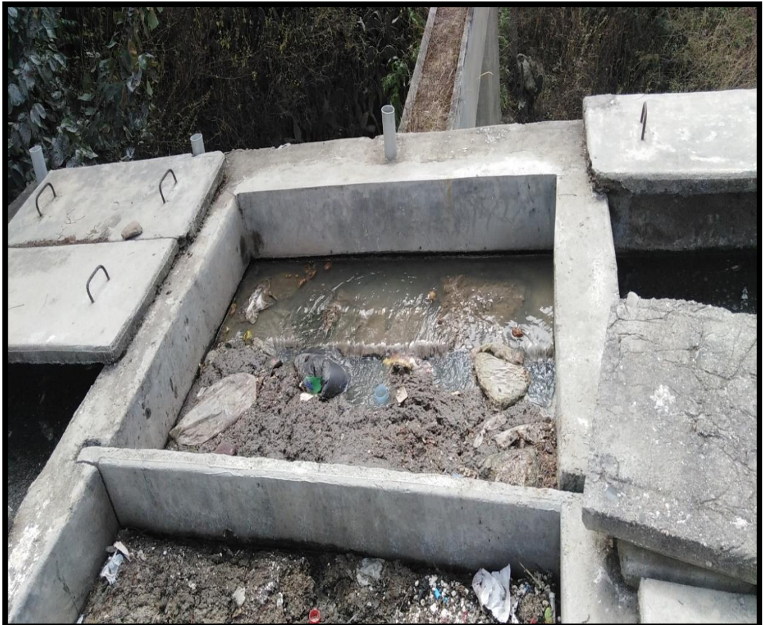
Fotografía 2 Planta de tratamiento de agua residual en mal estado
