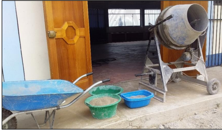
Fotografía 33 Colocación de agua, agregado global y cemento de acuerdo a los pesos determinados en los diseños de mezcla
