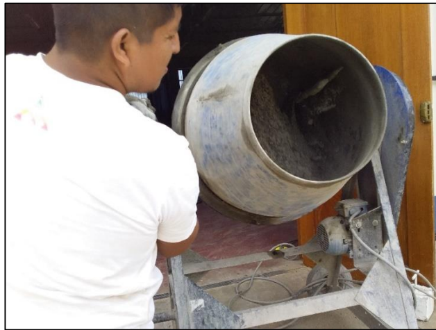
Fotografía 34 Proceso de mezclado de los materiales (agua, cemento y agregado global) para lo cual se utilizó el trompo de la Universidad de Huánuco
