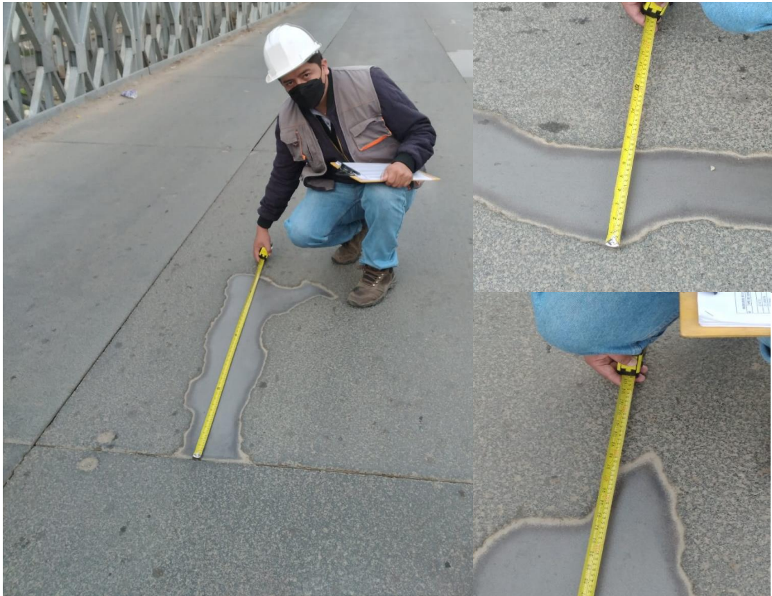
Punto de Referencia 0007-0008, se observa el tipo de deterioro “Peladura y Desprendimiento”, la falla es puntual y desprendimiento del concreto asfáltico de 2.50mx0.18m
