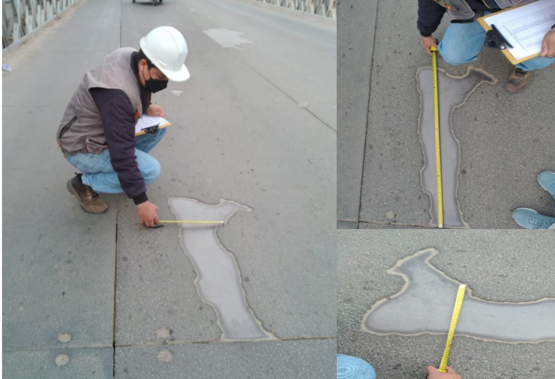
Punto de Referencia 0009-0010, se observa el tipo de deterioro “Peladura y Desprendimiento”, la falla es puntual y desprendimiento del concreto asfáltico de 1.09mx0.25m
