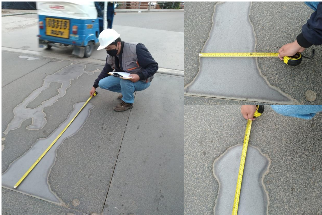
Punto de Referencia 0011-0012, se observa el tipo de deterioro “Peladura y Desprendimiento”, la falla es puntual y desprendimiento del concreto asfáltico de 1.48mx0.33m
