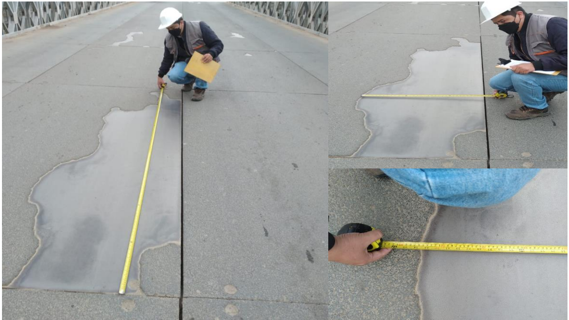
Punto de Referencia 0005-0006, se observa el tipo de deterioro “Peladura y Desprendimiento”, la falla es puntual y desprendimiento del concreto asfáltico de 2.90mx0.86m
