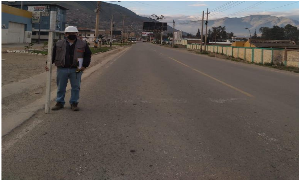
Punto de Referencia 0019-0020, se observa el tipo de deterioro “Peladura y Desprendimiento”, la falla es puntual sin aparición de la base granular (peladura superficial) de 130mx4m
