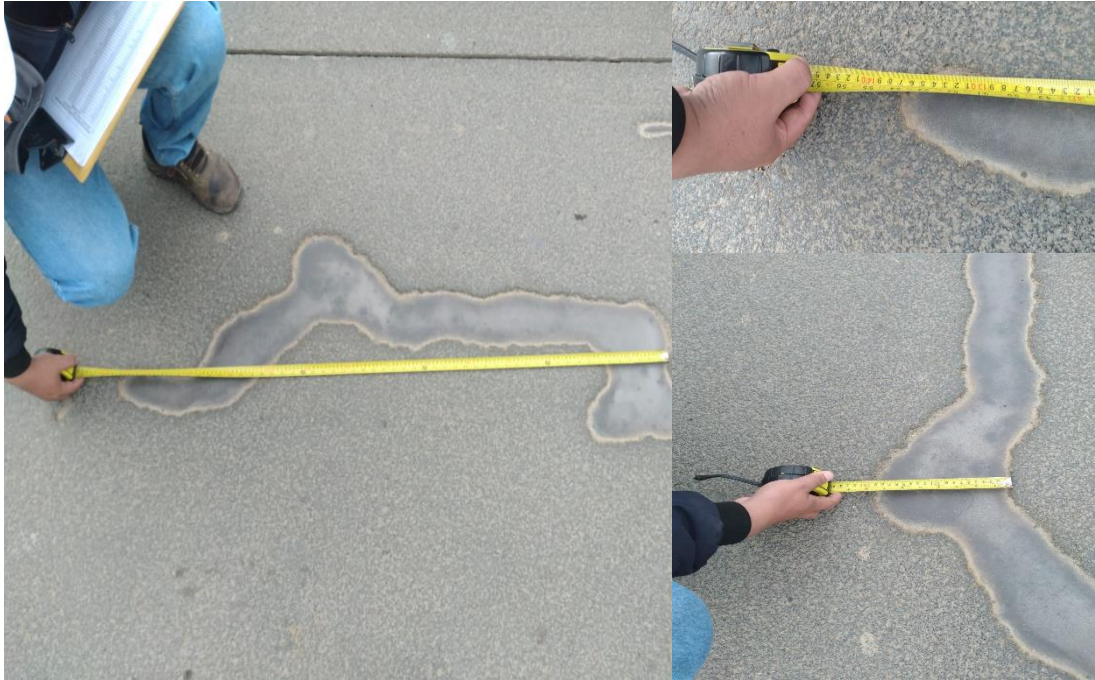
Punto de Referencia 0003-0004, se observa el tipo de deterioro “Peladura y Desprendimiento”, la falla es puntual y desprendimiento del concreto asfáltico de 1.37mx0.19m
