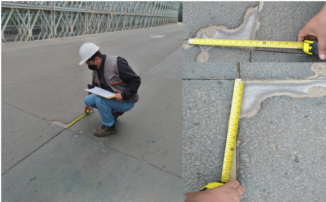
Punto de Referencia 0001-0002, se observa el tipo de deterioro “Peladura y Desprendimiento”, la falla es puntual y desprendimiento del concreto asfáltico de 0.2mx0.17m.
