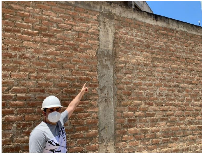
Indicando la patología encontrada en el Jr. Candamo
