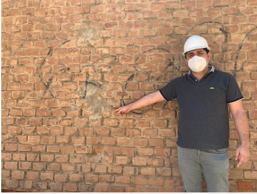
Indicando la patología encontrada en el Jr. Los Naranjos
