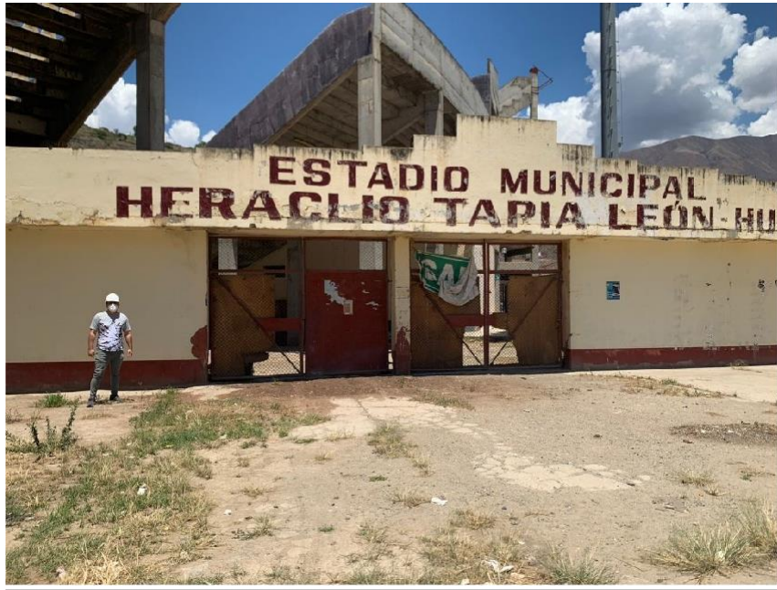
Indicando la patología encontrada en el Jr. León de Huánuco
