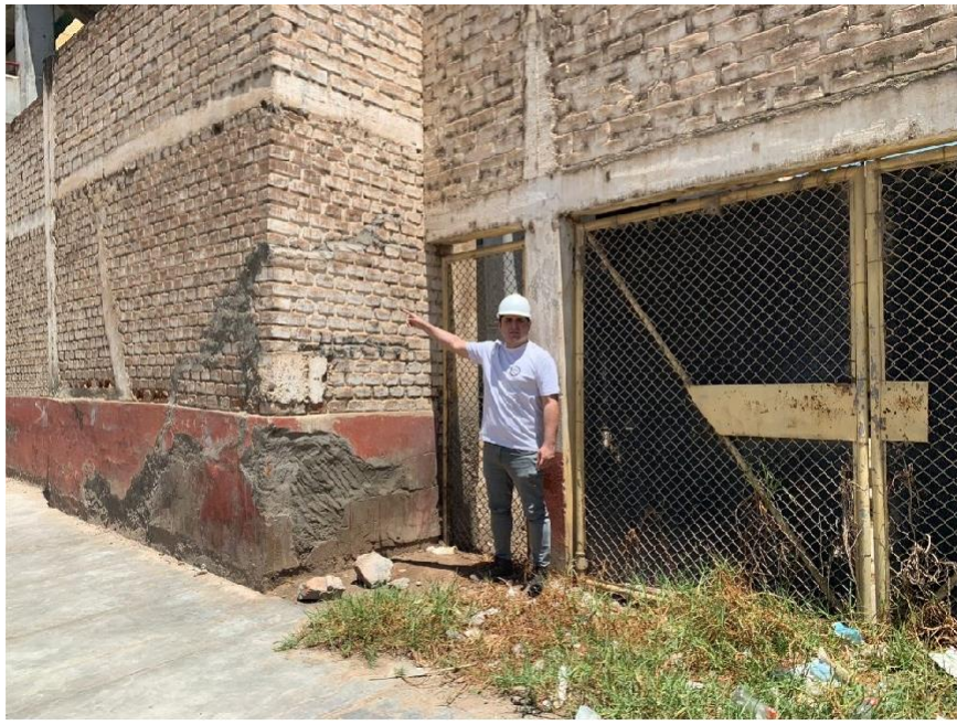
Indicando la patología encontrada en el Jr. Candamo
