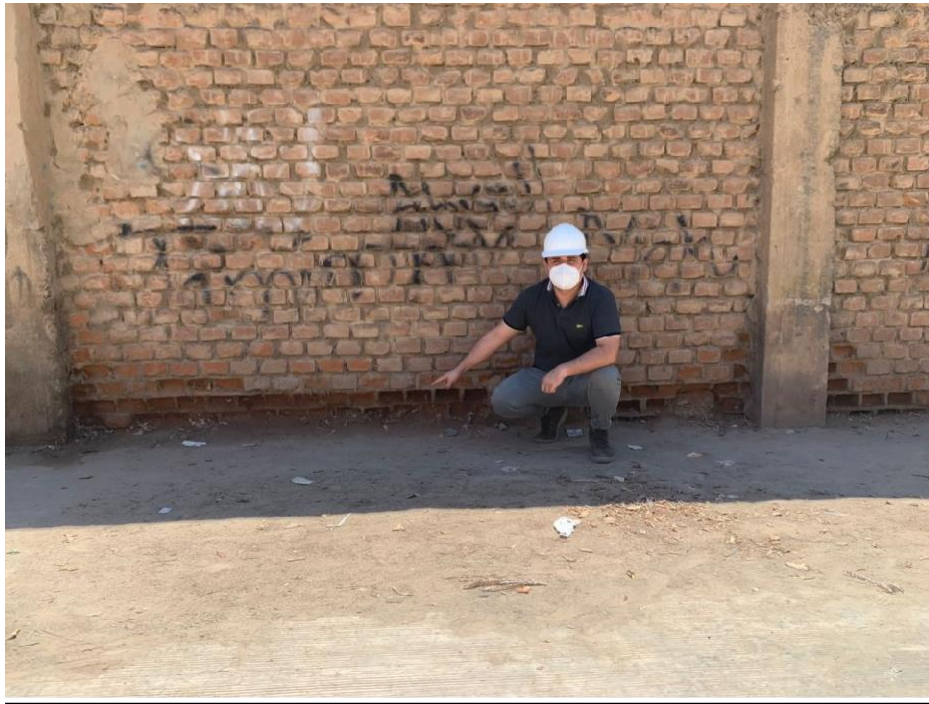
Indicando la patología encontrada en la Av. El Bosque
