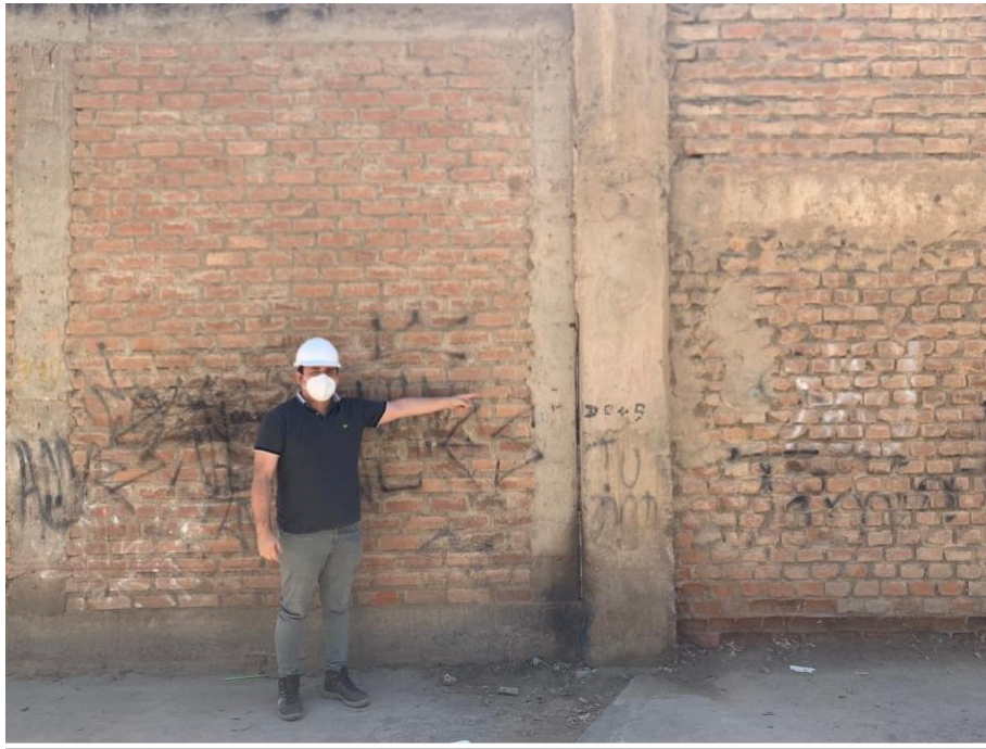
Indicando la patología encontrada en la Av. El Bosque
