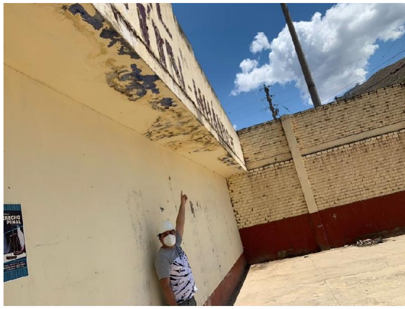
Indicando la patología encontrada en el Jr. León de Huánuco
