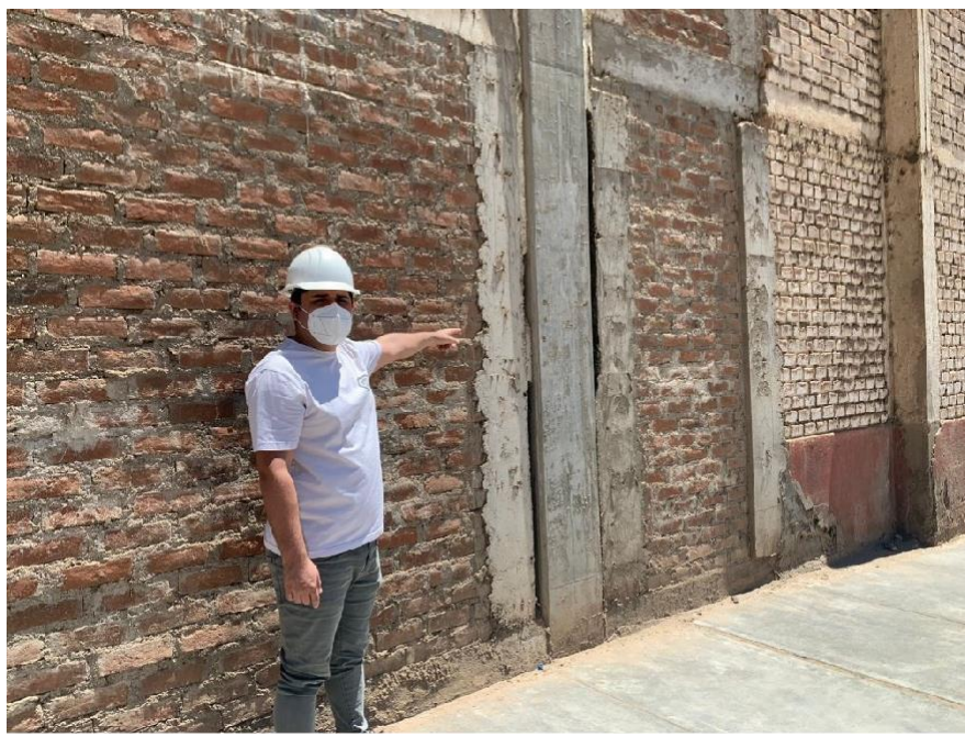
Indicando la patología encontrada en el Jr. Los Naranjos
