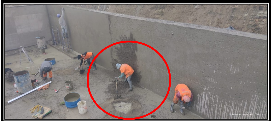
Imagen donde se muestra excesos de material preparado y mala manipulación.
