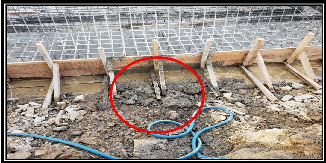
Imagen donde se muestra restos de concreto preparado en excesos.
