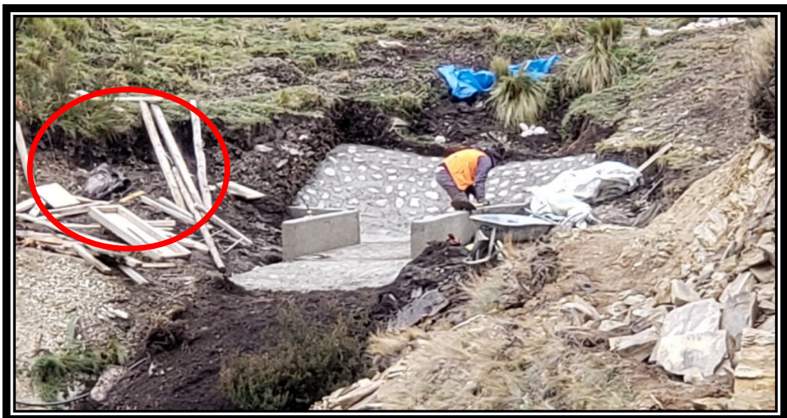
Imagen donde se muestra restos de madera producto de un mal encofrado
