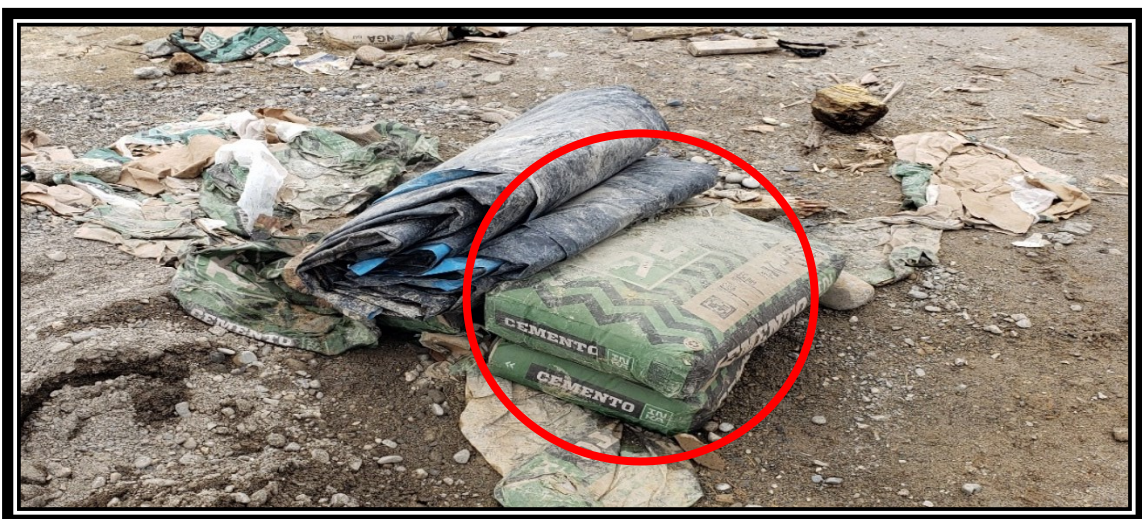
Imagen donde se muestra cemento en estado endurecido por el mal almacenado.
