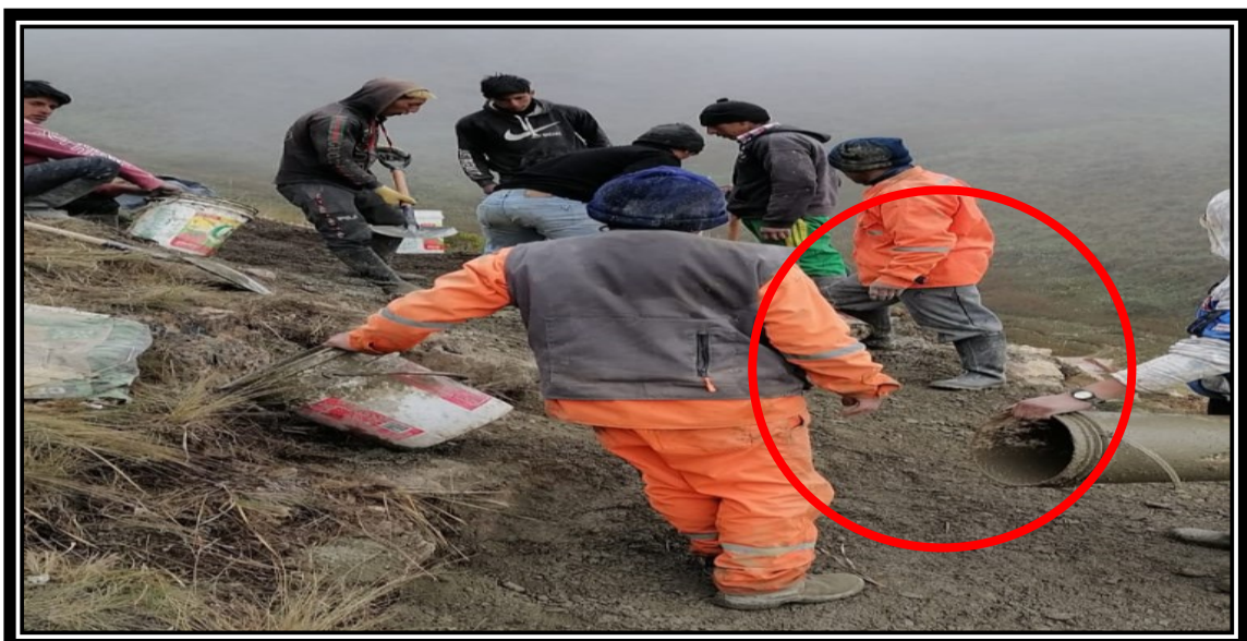
Imagen donde se muestra preparado del concreto en contacto directo con el suelo
