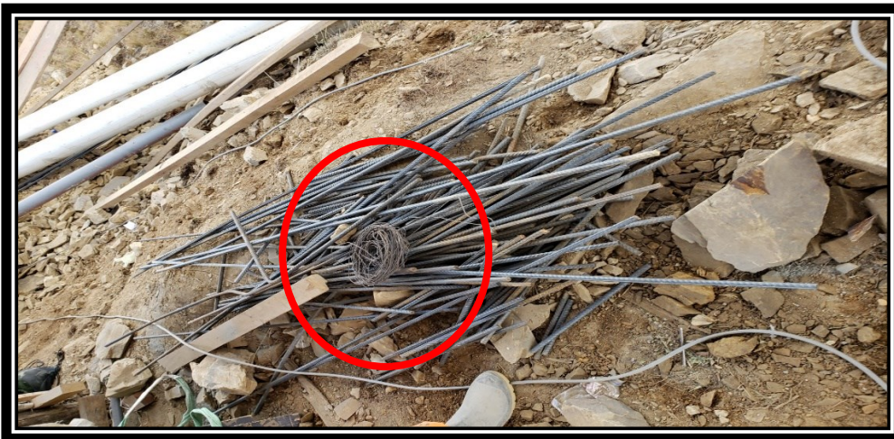
Imagen donde se muestra restos de acero en la intemperie.
