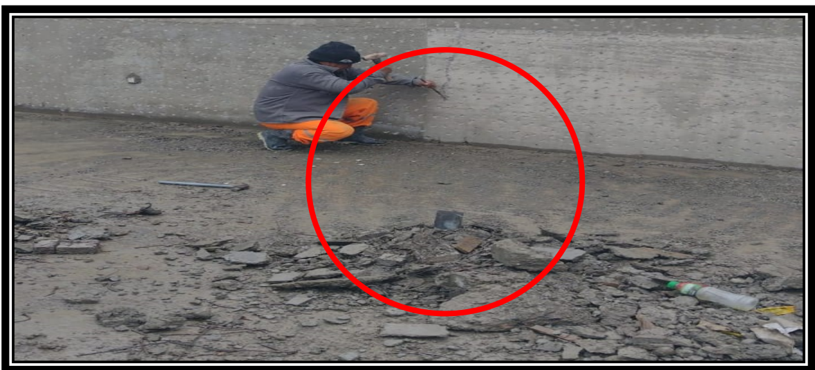
Imagen donde se muestra un mal proceso constructivo el cual al picar genera muchos desperdicios.
