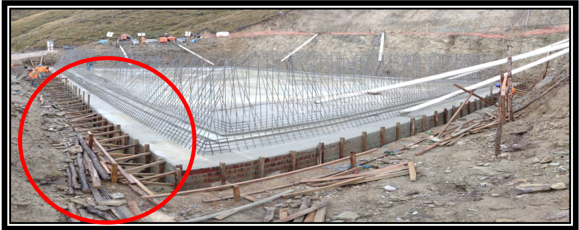
Imagen donde se muestra restos de madera y acero mal almacenados.
