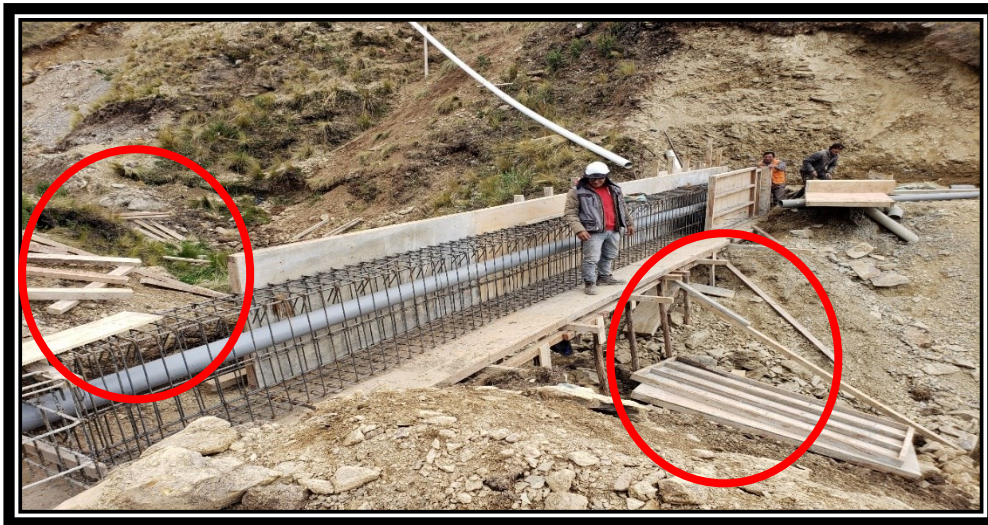
Imagen donde se muestra los residuos alrededor de la estructura.
