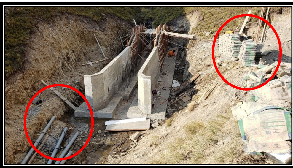
Imagen donde se muestra un inadecuado almacenado del cemento.
