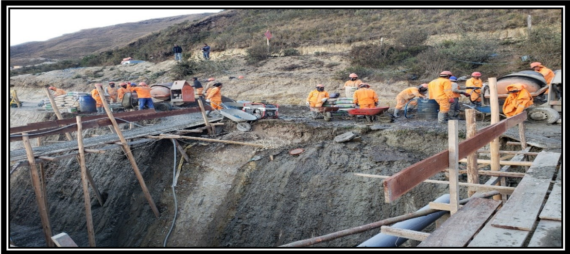
Imagen donde se muestra una mala manipulación de y preparado del concreto.
