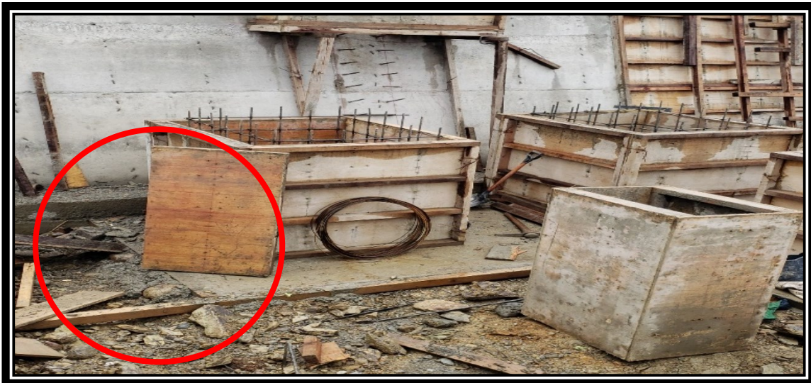
Imagen donde se muestra restos de paneles mal cortados.
