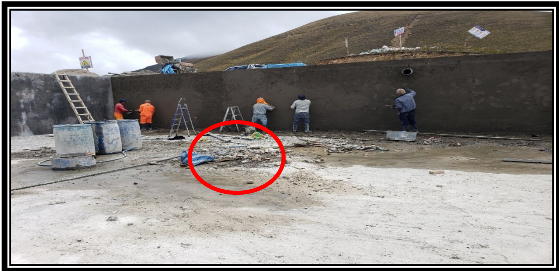
Imagen donde se muestra restos de mezcla de concreto seco en exceso.
