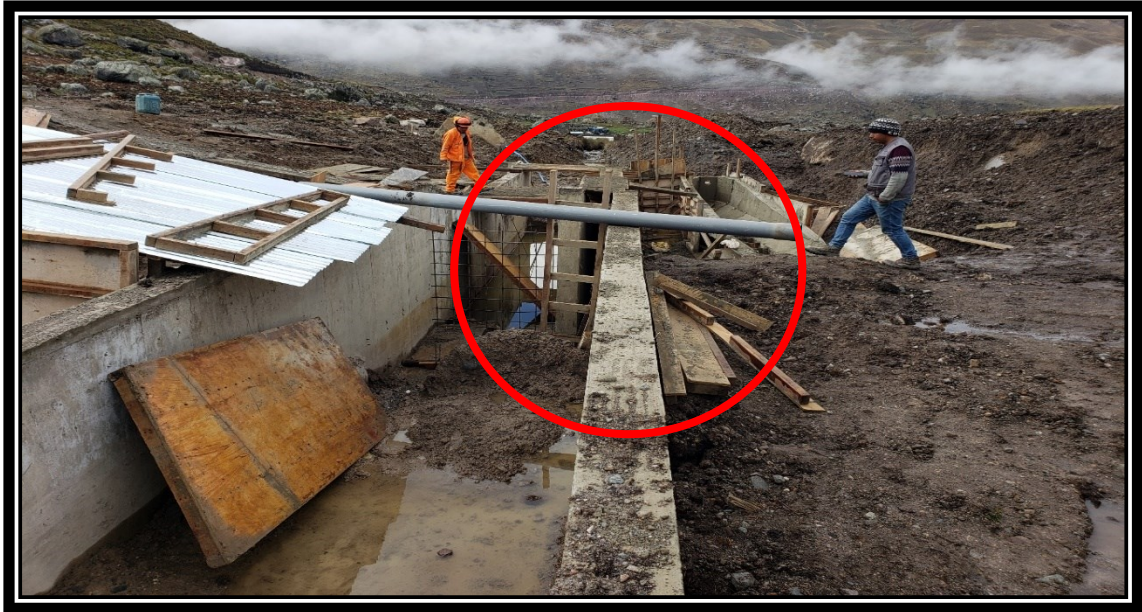
Imagen donde se muestra restos de madera, paneles y tubo mal almacenado.
