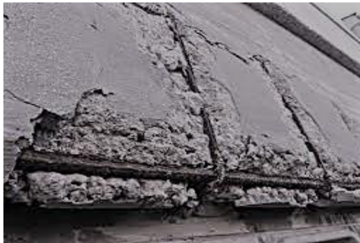
Figura N° 15. Corrosión del acero en el elemento estructural
