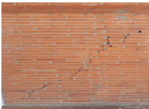
Figura N° 8. Falla por corte en el plano
