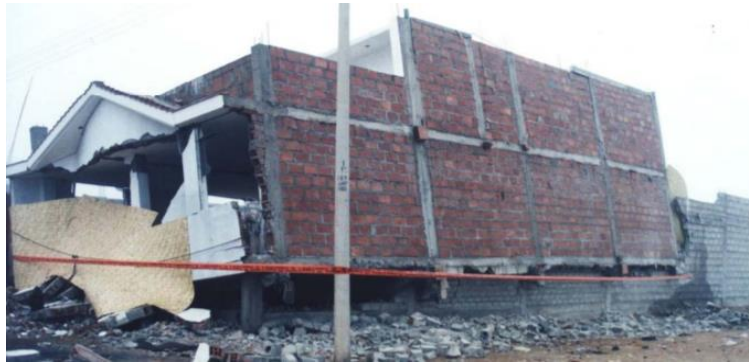
Figura N° 13. Consecuencia ante un sismo por escasa densidad de muros
