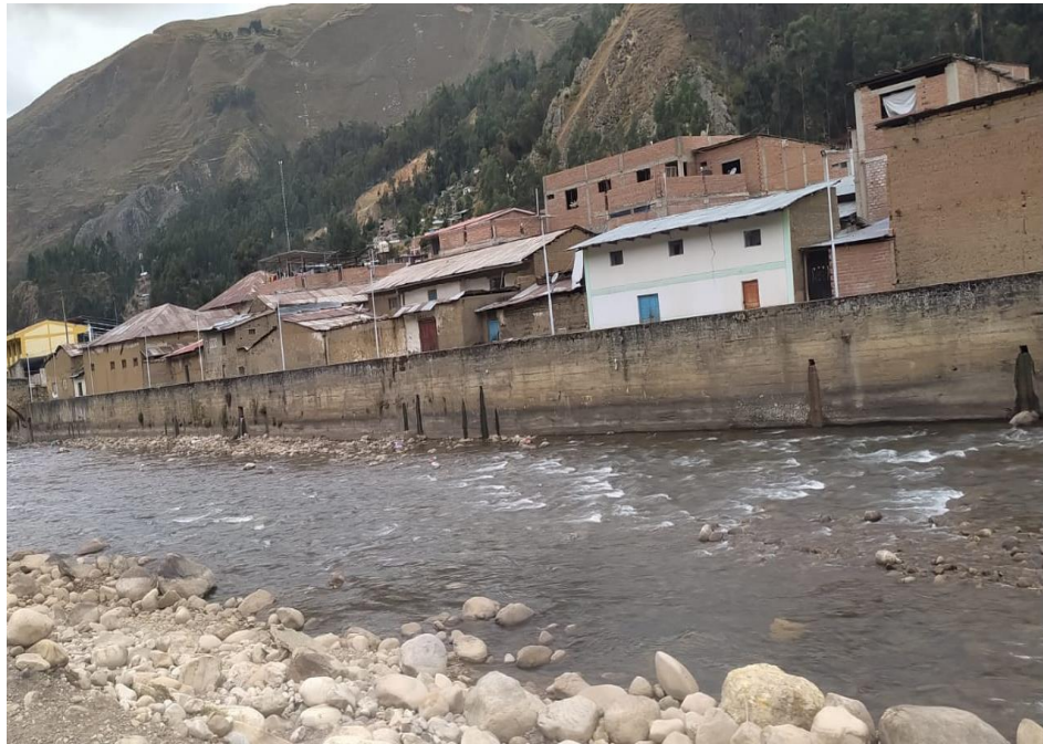
La margen derecha del río Vizcarra cuenta con muros de contención como protección ribereña.
