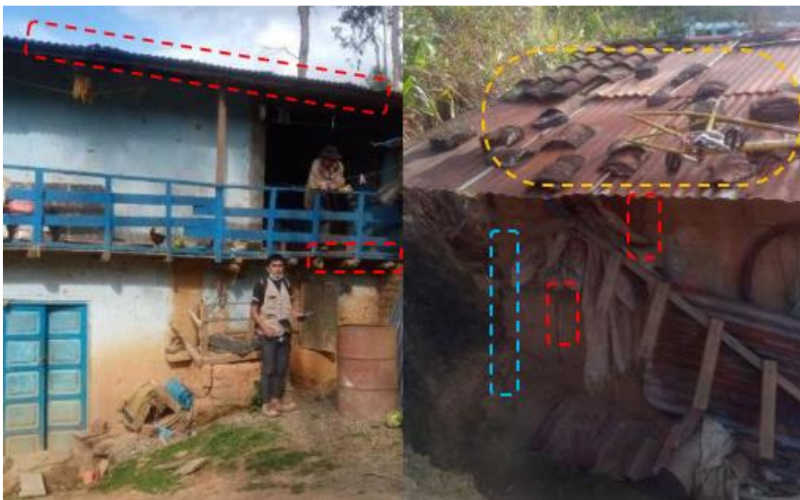
FOTOGRAFÍA N°02: Se observa la disgregación de las unidades de tapial, presencia de grietas en los muros, las coberturas en estado de deterioro y las vigas de maderas apolilladas. Todo ello debido a la antigüedad y otros agentes externos.
