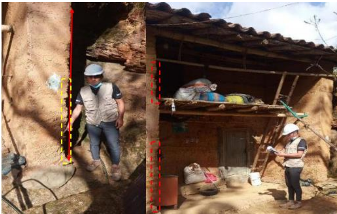
FOTOGRAFÍA N°01: Se aprecia disgregación de las unidades de tapial, principalmente este tipo de daños se observó en todas las viviendas evaluadas, ya que todos ellos no tienen una adecuada protección en sus muros.
