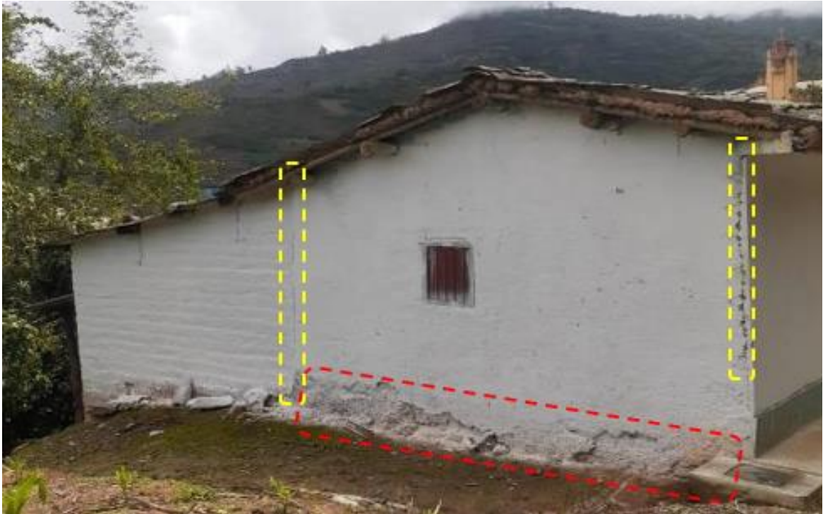
FOTOGRAFÍA N°03: Se observa eflorescencia en muros que son por efectos de humedad al no contar con sobrecimientos y recubrimientos. Asimismo, esta vivienda no tiene una adecuada junta sísmica.
