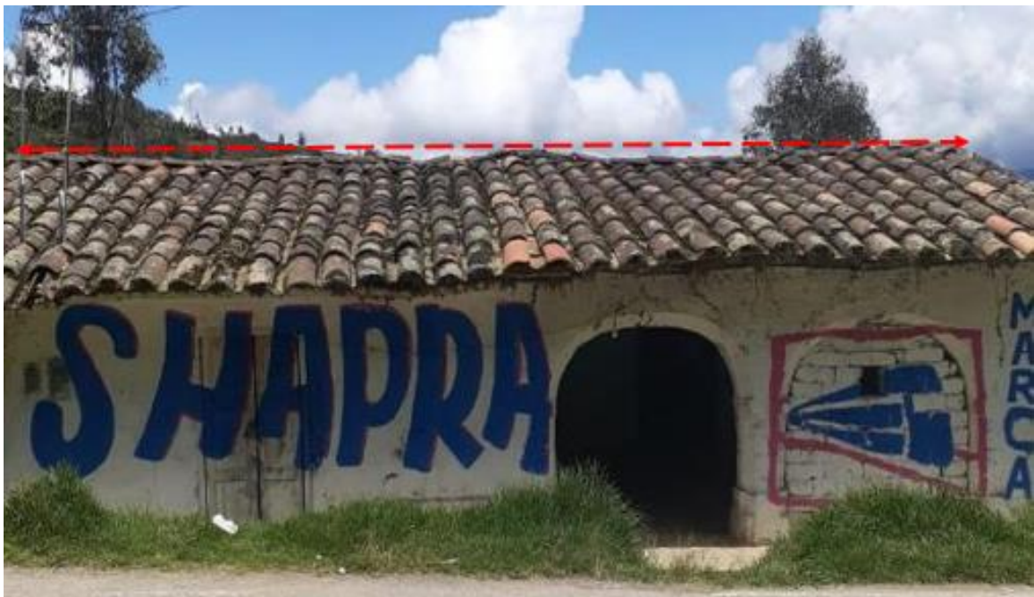
FOTOGRAFÍA N°06: Se aprecia hundimiento de la viga principal, tejas artesanales en estado de deterioro y la mano de obra fue deficiente.
