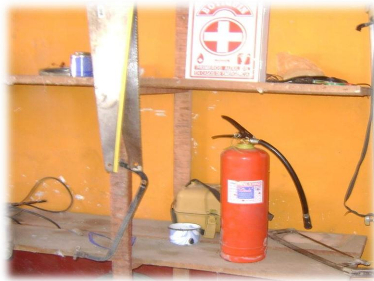
FOTO N° 15: IMPLEMENTACIÓN DEL EXTINTOR CONTRA INCENDIOS
