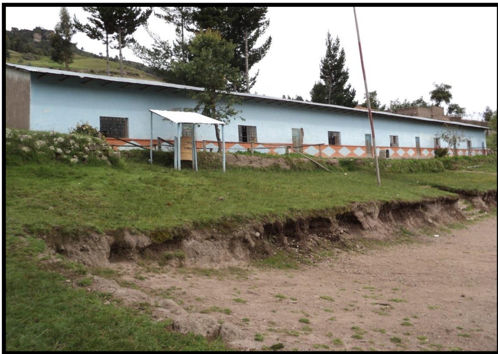
FOTOGRAFIA 9. Pérdida de la cobertura vegetal y plantas ornamentales en el área de construcción.
