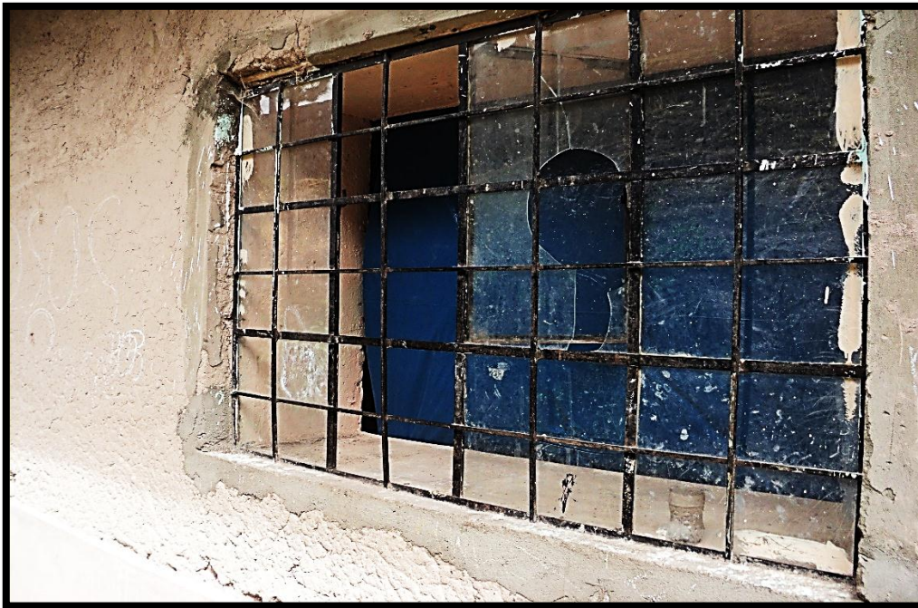
FOTOGRAFIA N° 12 Falta de mantenimiento de la infraestructura de la I. E. Integrado de Cascanga lo que evidencia mal aspecto y motiva a la construcción de nuevos ambientes.
