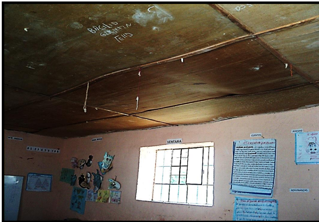
FOTOGRAFIA N° 10. Techo rustico de las aulas lo que ocasionara el desprendimiento de esta con consecuencias negativas para la salud de los estudiantes (contaminación de polvo y accidentes).
