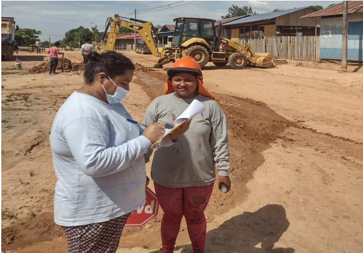
Foto tomada a los pobladores de Santa Rosa de Masisea – Ucayali y al personal administrativo y obreros de constructora FALIM E.I.R.L.
