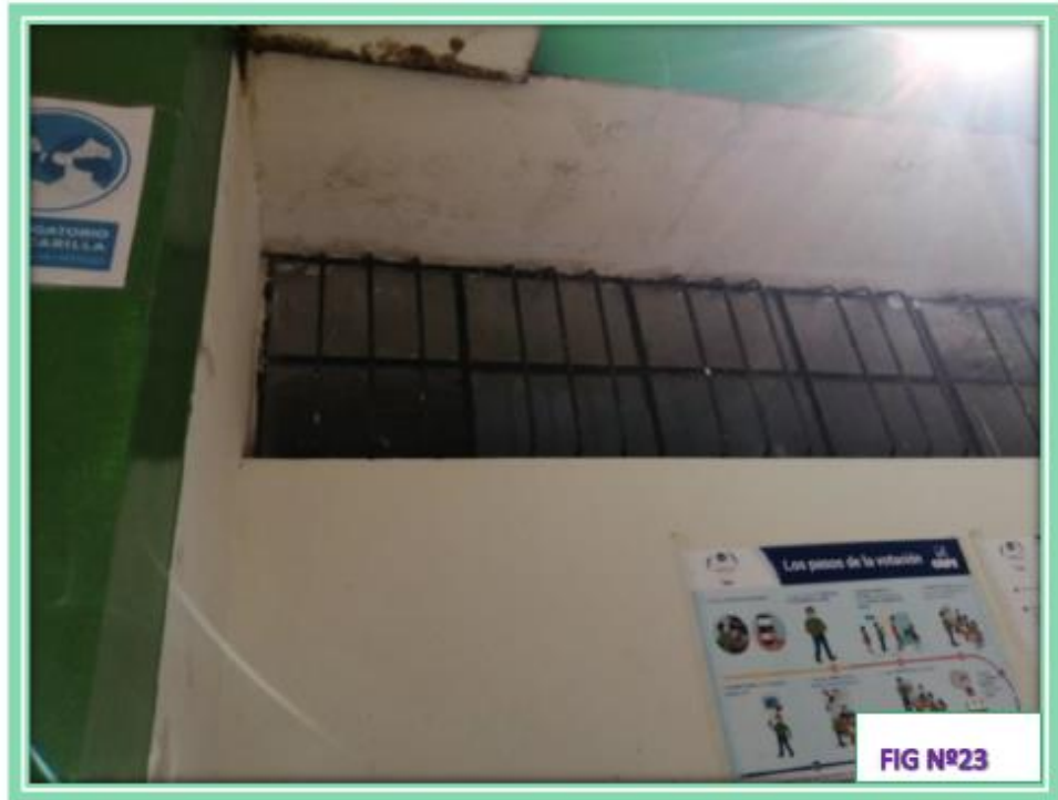
En la Fig. Nº23 se observa moho y hongos en las vigas
