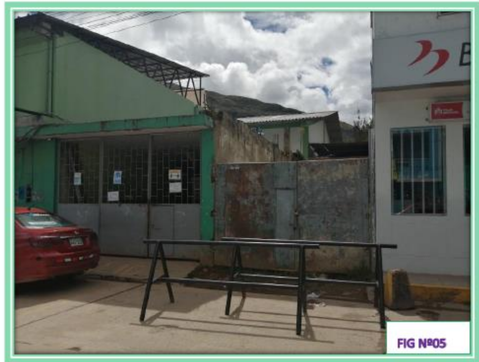
En la Fig. N°05 se observa las puertas metálicas del mercado en estado de corrosión
