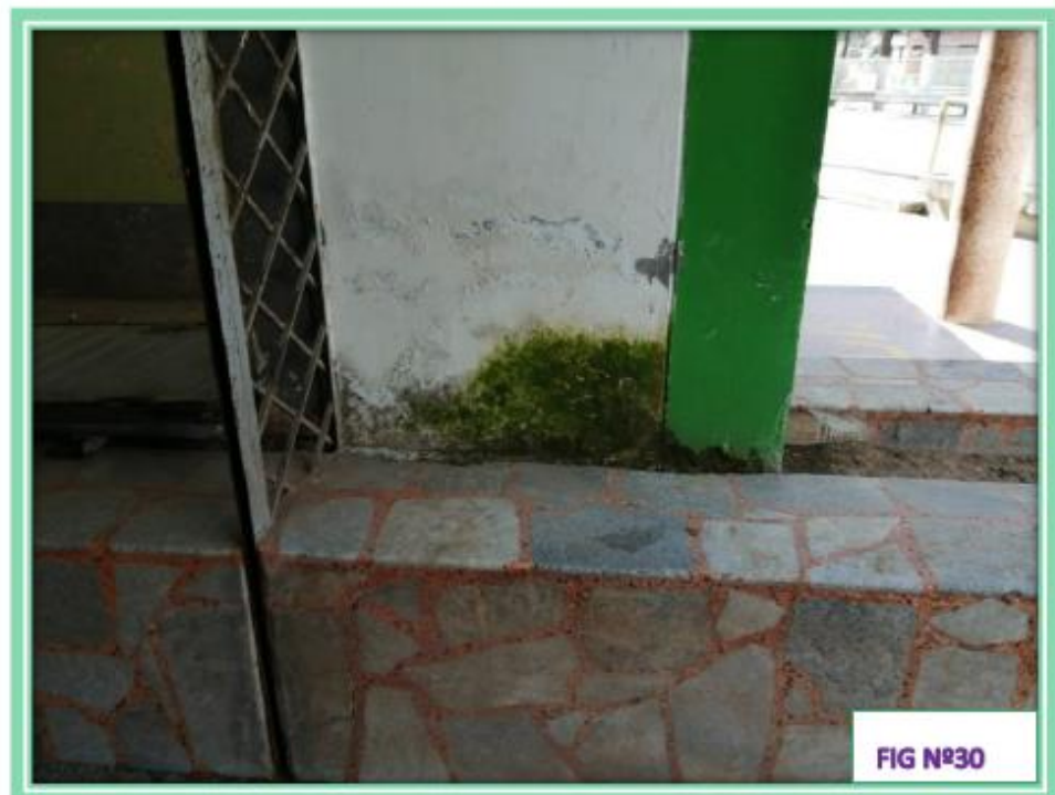
En la Fig. N°30 se observa ataques de sulfatos y humedad en columnas
