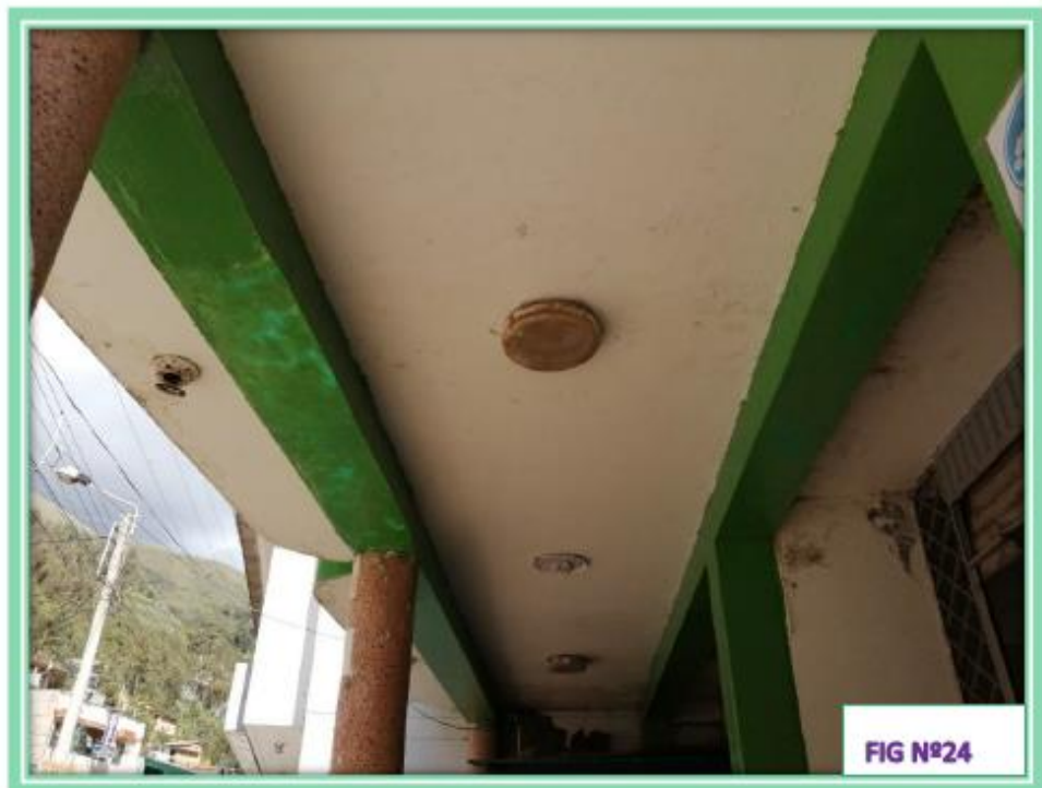
En la Fig. Nº24 se observa luminaria incompleta y en mal estado
