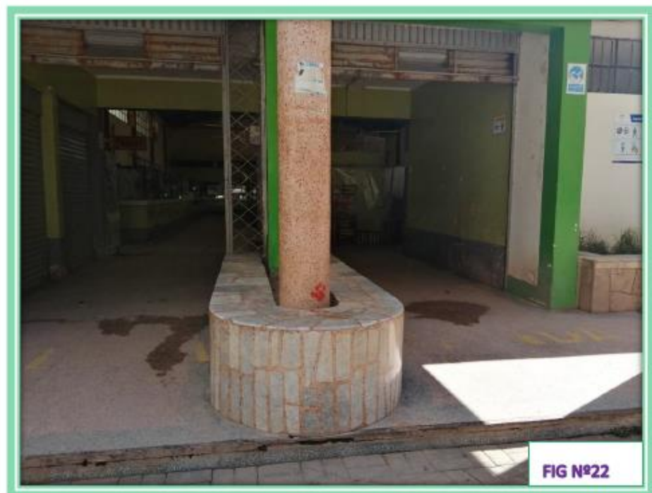
En la Fig. N°22 se observa detalle de banqueta de espera en piedra mármol
