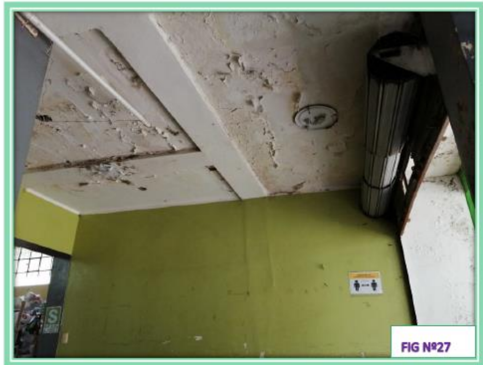
En la Fig. Nº27 se observa humedad en cielorraso
