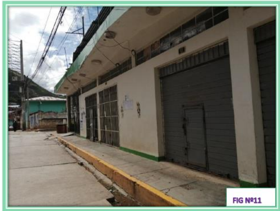
En la Fig. N°11 se observa las instalaciones de alumbrado empotrado en el voladizo
