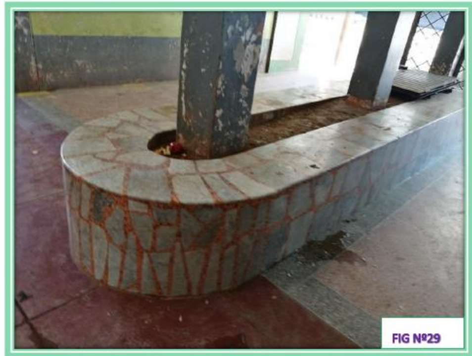
En la Fig. N°29 se observa debilitamiento en columnas por sulfatación
