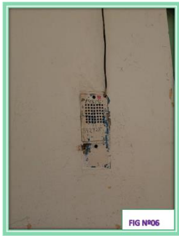
En la Fig. N°06 se observa la caja de luz metálico y su cableado
