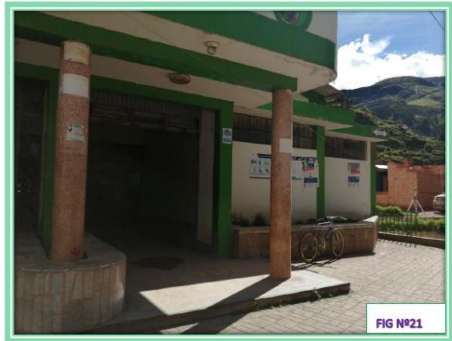
En la Fig. N°21 se observa espaciamento de las columnas circulares que sujetan al volado
