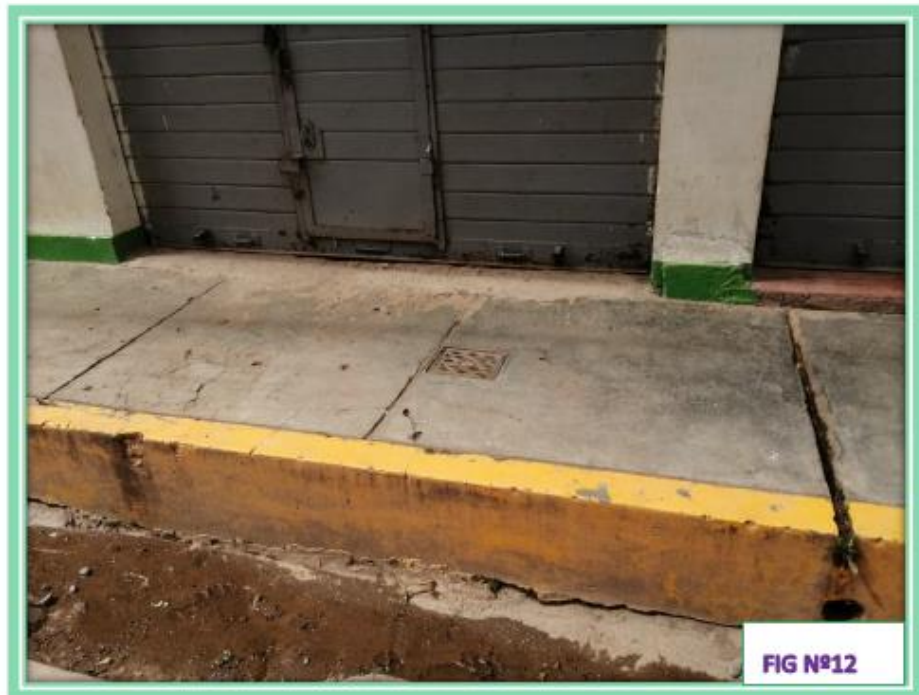
En la Fig. N°12 se observa la caja con tapa metálica para agua
