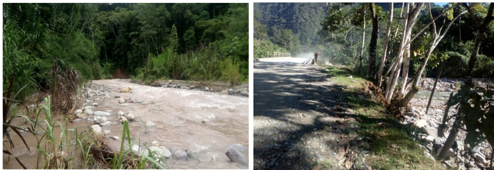
Nota: La imagen muestra la carretera que conecta al centro poblado de Bella se encuentra en peligro de colapso.
