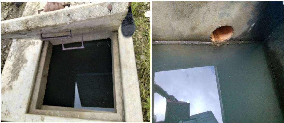
Primer tratamiento: tanque septico
