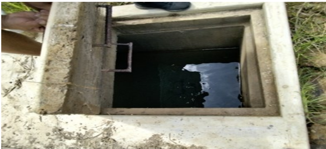
Primer tratamiento: tanque séptico
