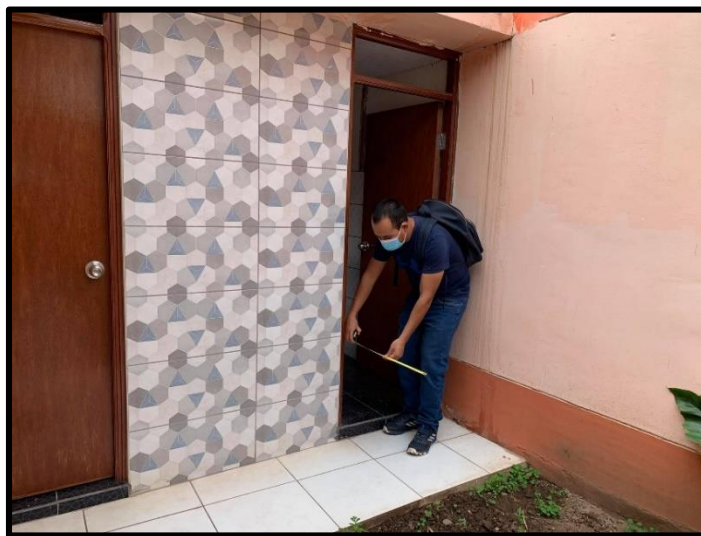
Circulación angosta en el ingreso de los servicios higiénicos.
