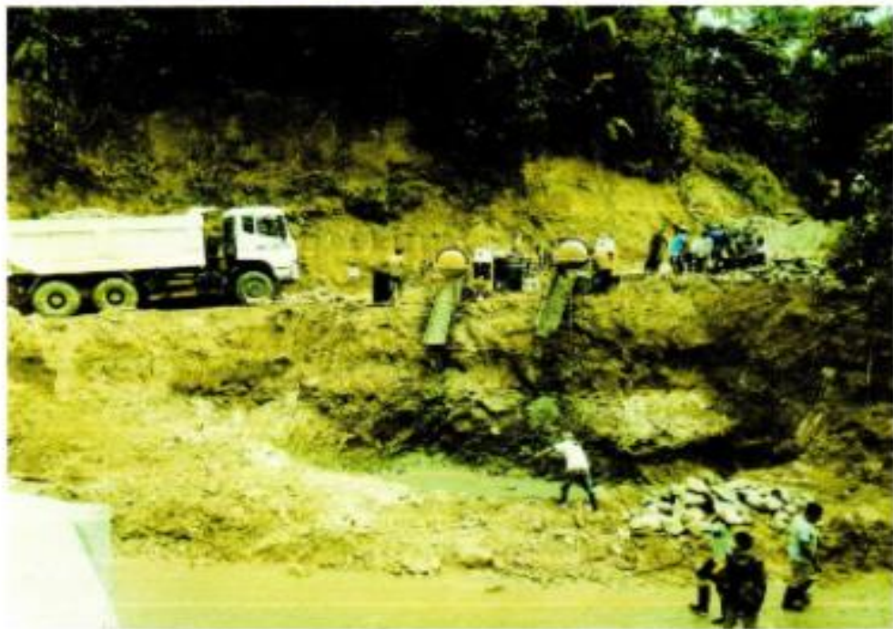
FOTOGRAFÍA N° 06 Y 07- Trabajos de vaciado de la zapata derecha y del lado derecho.
