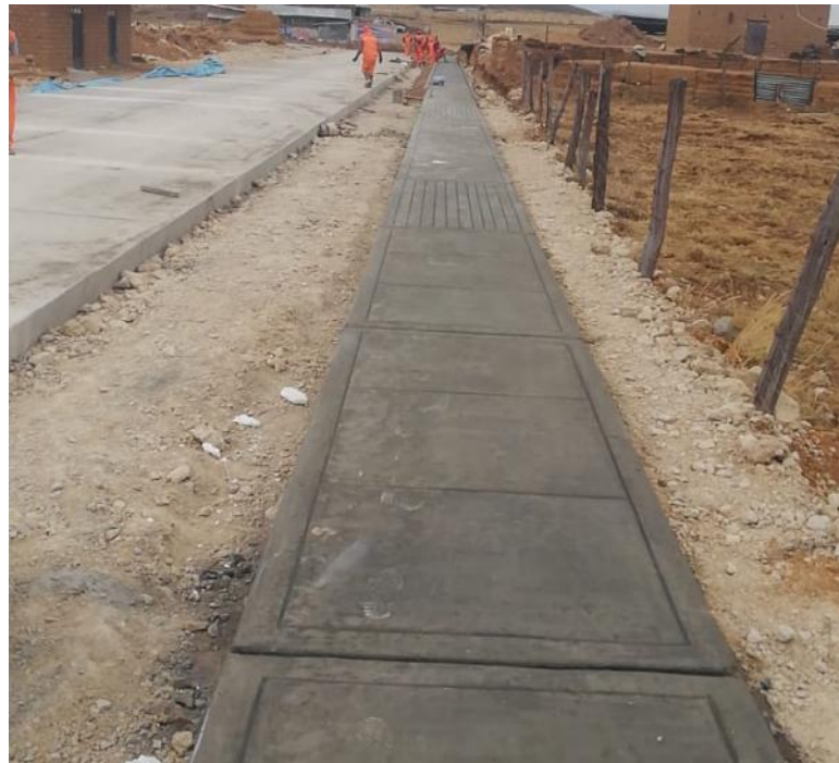
Se observa del acabado de la vereda con su bruñido y juntas según los planos
