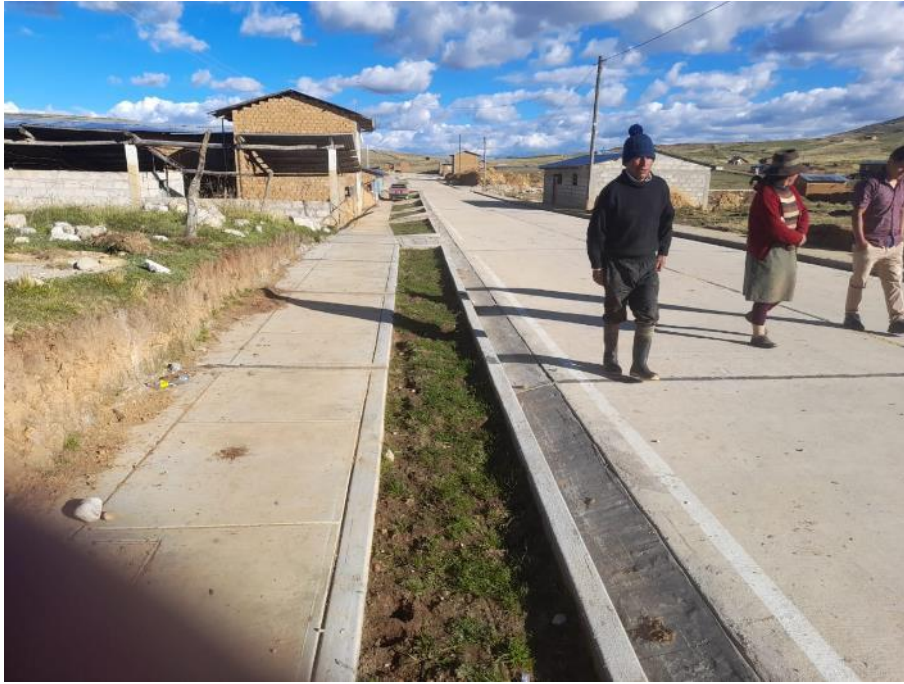
Se observan las calles con los trabajos ya culminados de la construcción de pavimentación
