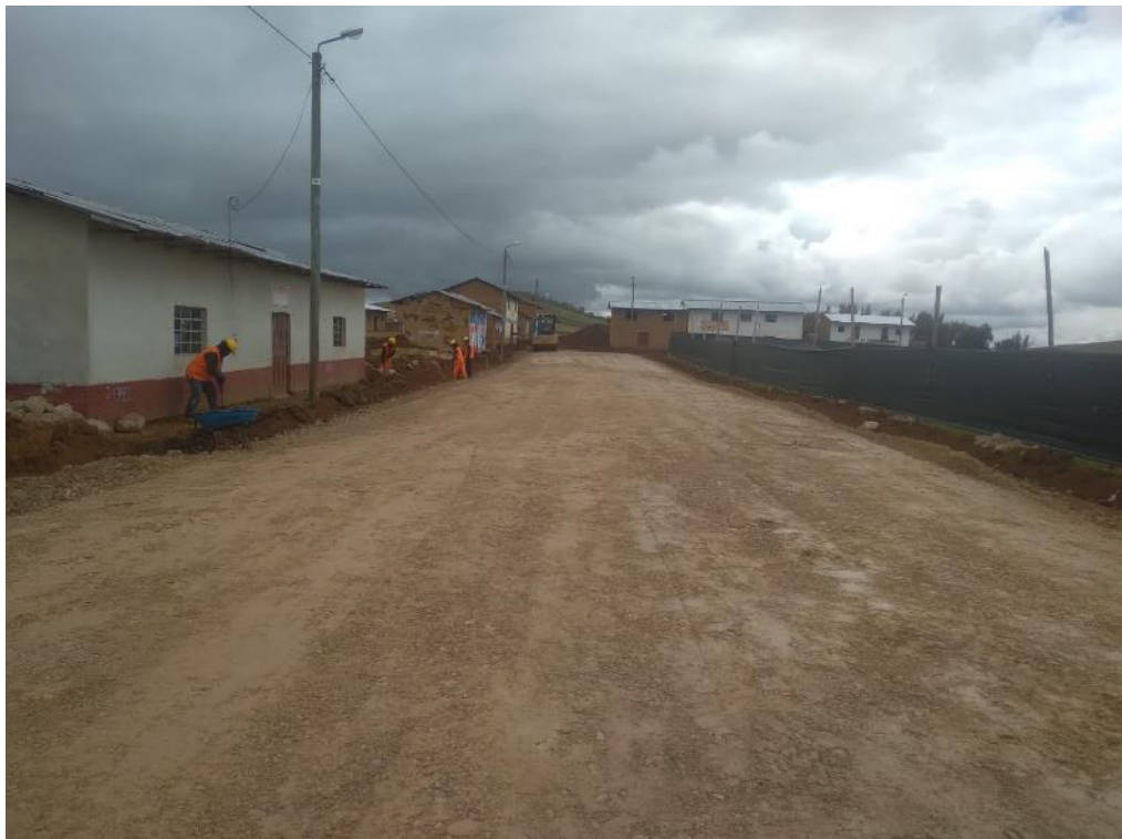
En la fotografía se observa el compactado de la base de afirmado
