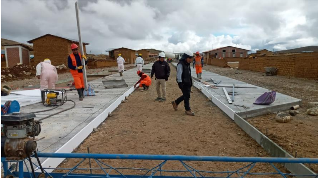
Se realizan los trabajos de colocación de juntas con tecknoport entre los paños del pavimento
