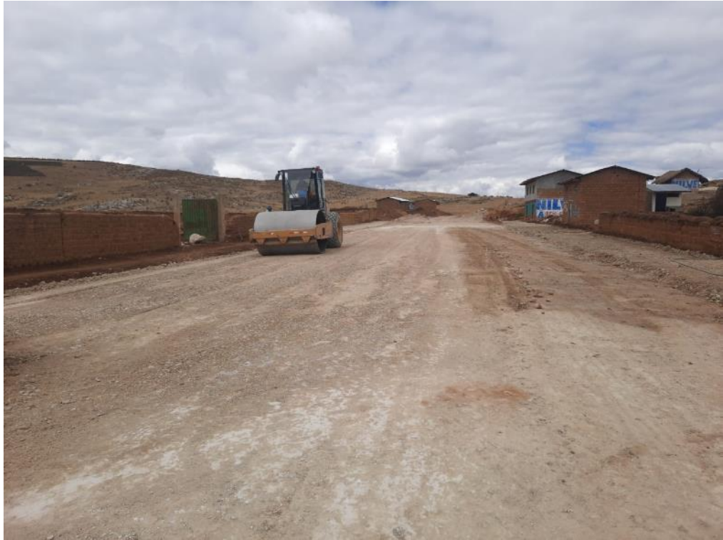
Se realizan los trabajos de compactado de la superficie de la base de afirmado
