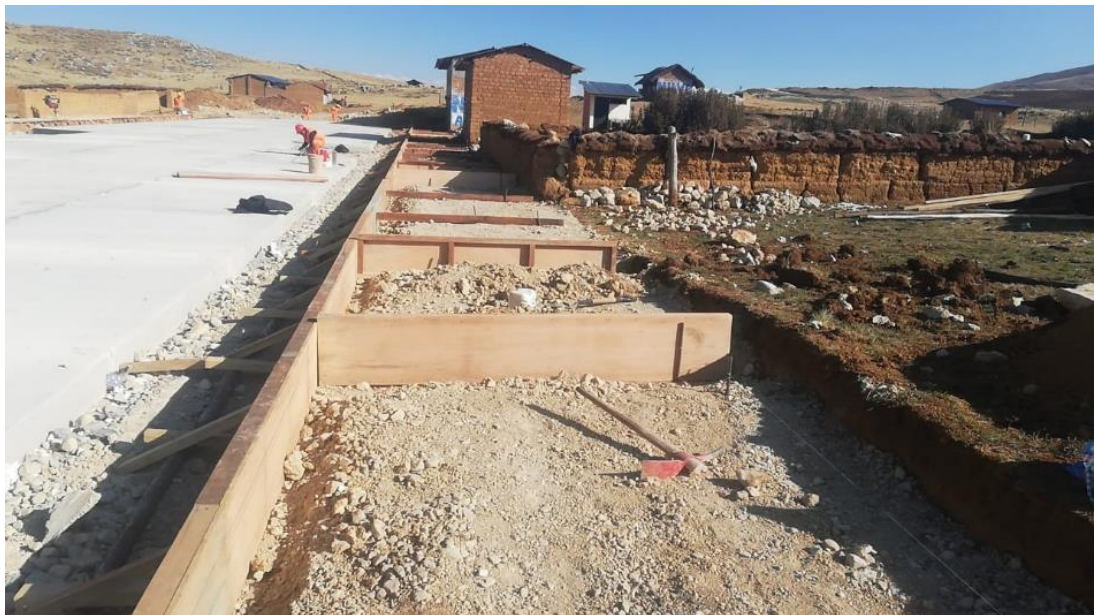
Se observa el encofrado de veredas y colocación del afirmado para veredas
