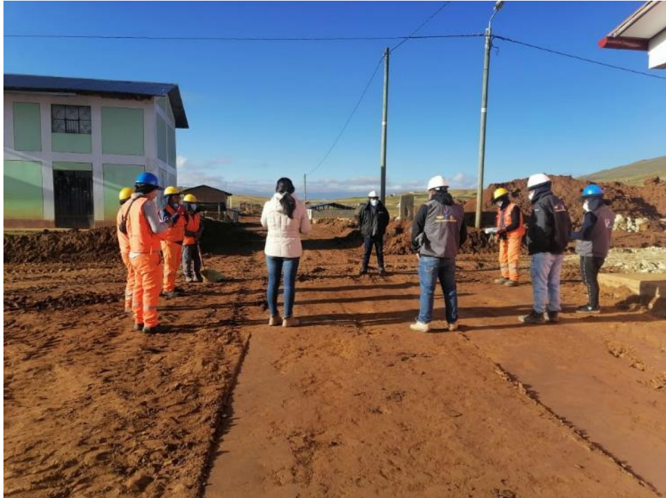
En la fotografía se observa la charla diaria realizada por el personal de ssoma y equipo técnico.
