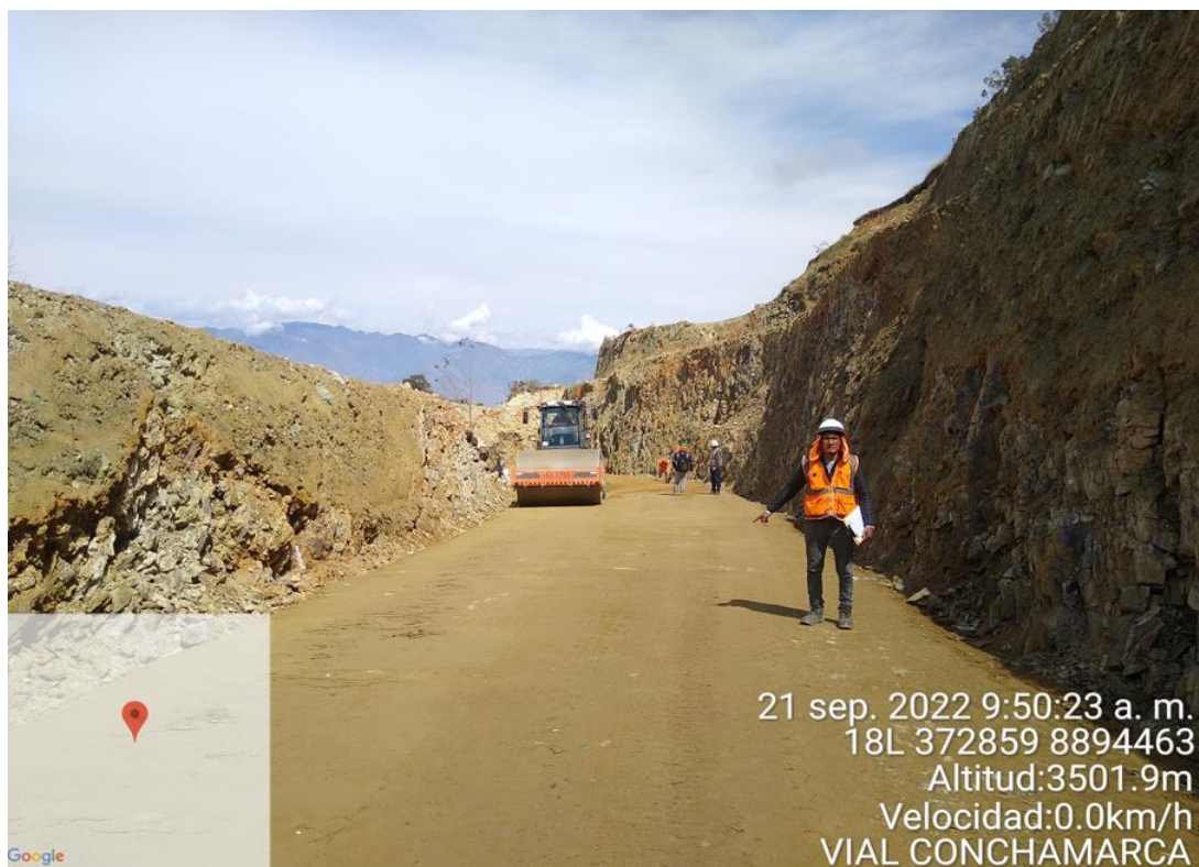
Verificando la compactación en el tramo de prueba para luego realizar el control de compactación adecuado
