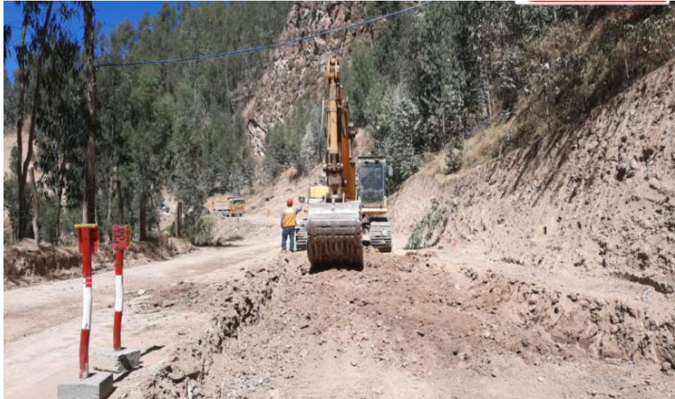
Excavación de terreno natural para la realización de mejoramiento de suelos a nivel de subrasante.
