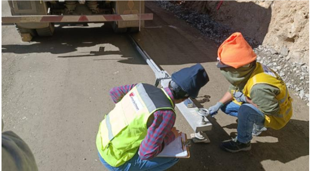
Ensayo Deflectométrico en Sub base Granular con uso de la Viga Benkelman.
