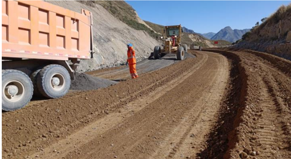
Conformación de la segunda capa de subrasante, batido con material fino para el control de humedad in-situ.
