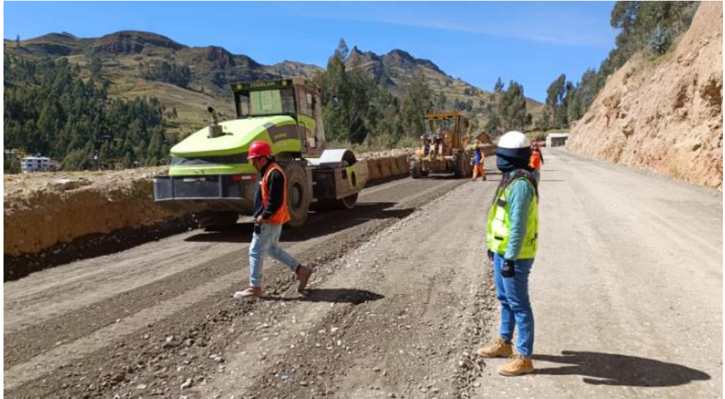
Control de compactación y correcto batido del material de sub base granular in-situ.
