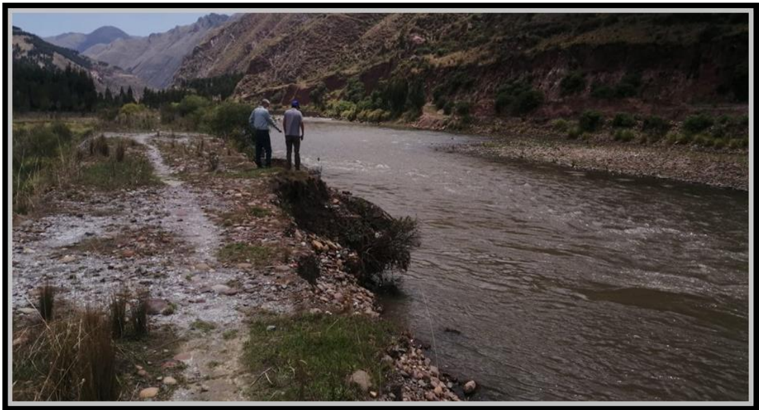
Espigones a punto de colapsar margen derecha del rio Vilcanota.
