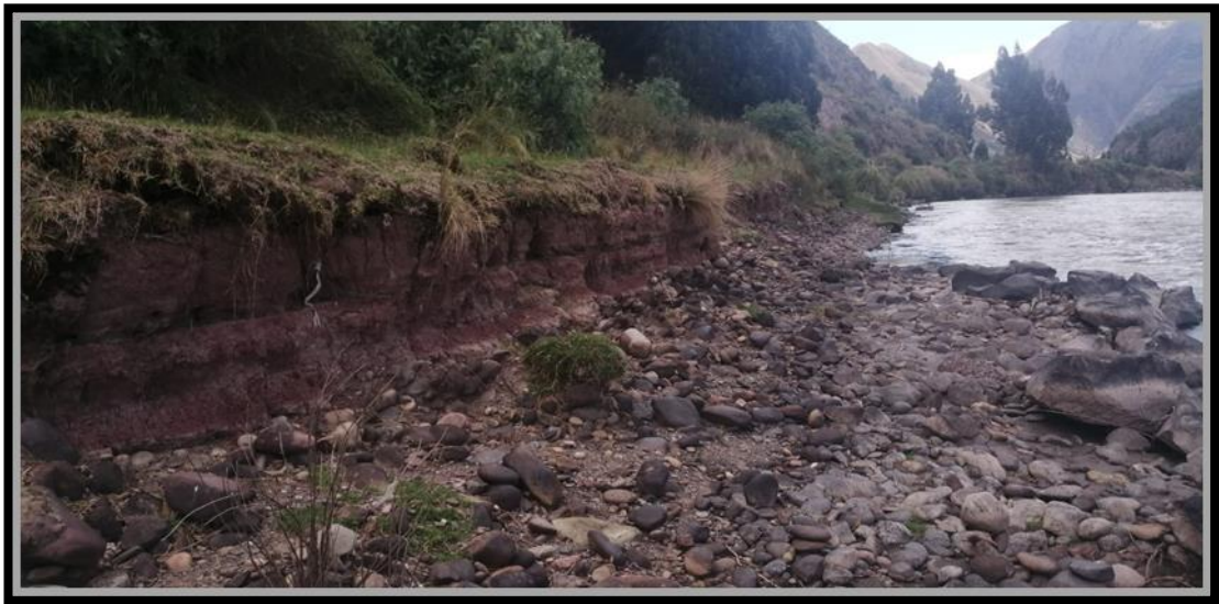
Deterioro de la infraestructura existente.
