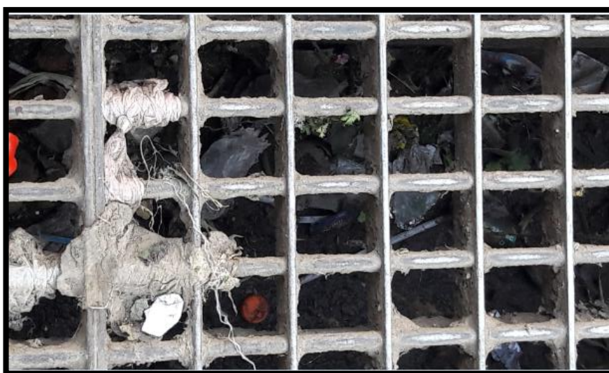
Ilustración 2: Presencia de acumulación de agua y residuos sólidos Huánuco y Leoncio Prado
