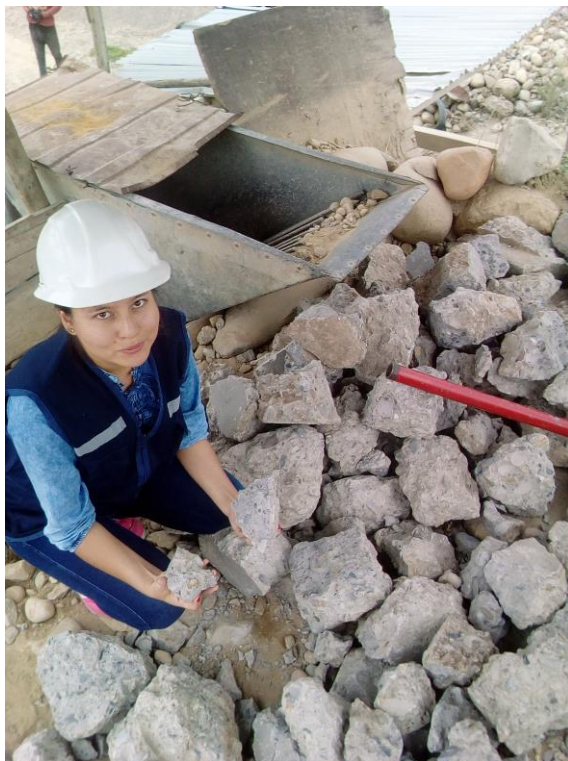
Foto 02. Residuos demolidos de pavimento rígido reciclado puestos en el ingreso de alimentación de la máquina trituradora de mandíbula
