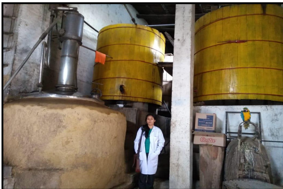
Instalaciones del proceso de destilación y almacenamiento de alcohol
