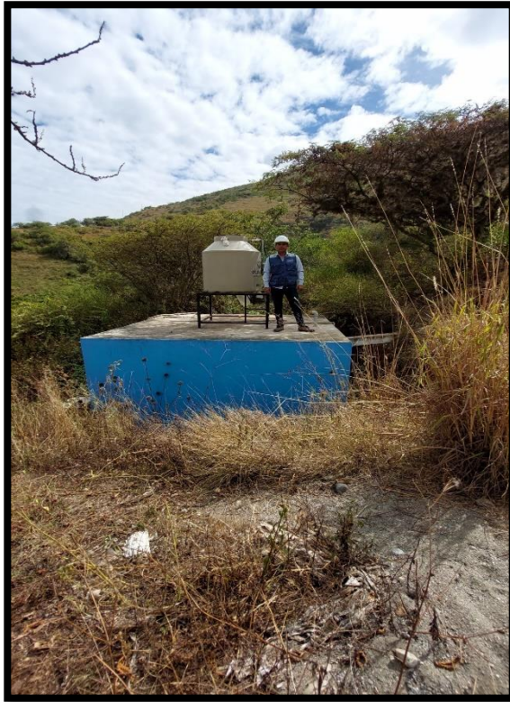
El reservorio tiene una capacidad de almacenamiento de 30 m 3 .
