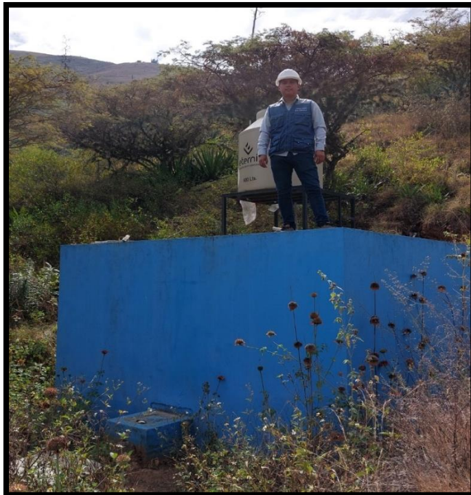
El reservorio tiene la forma rectangular con las medidas de 4.00*3.00*2.50 metros. Nuestra propuesta es proyectar un reservorio circular con una capacidad de 75 m 3 .
