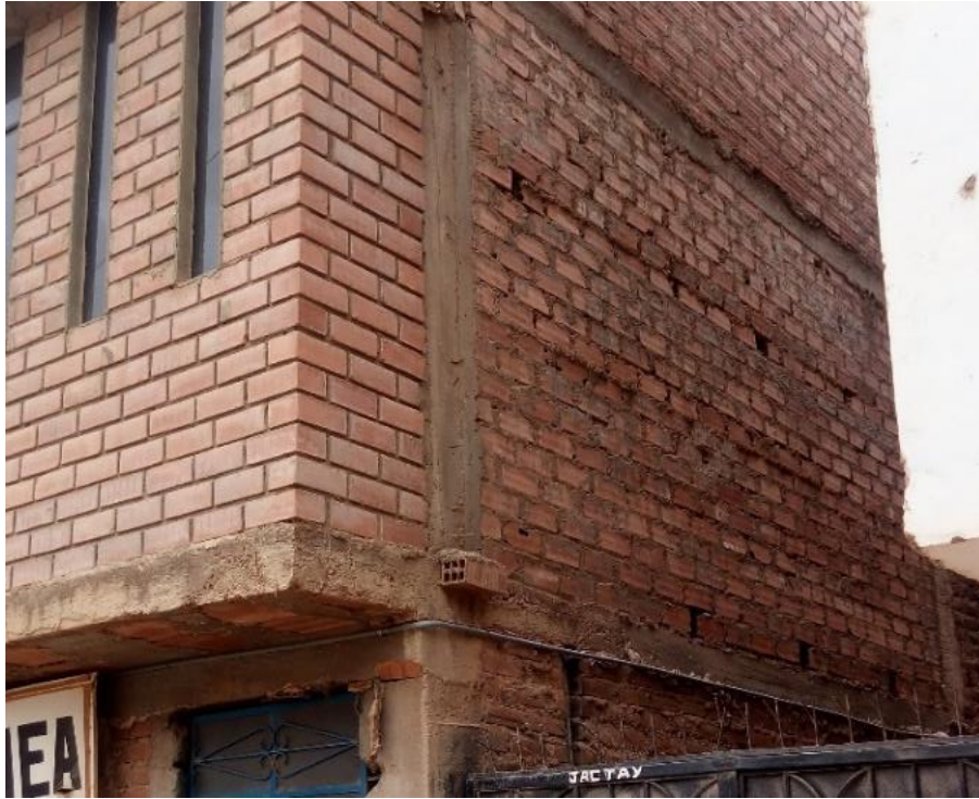
FOTOGRAFIA N° 15: Se puede apreciar que el muro de ladrillo exterior del lado derecho de la vivienda no se encuentra alineado y presenta cierta inclinación.
