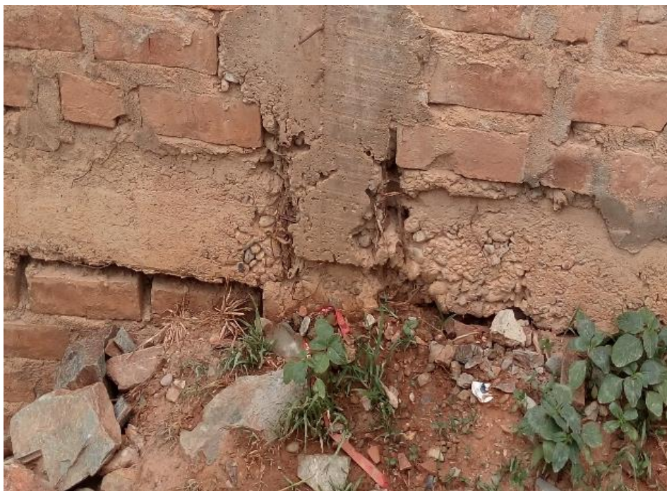
FOTOGRAFIA N° 09: Se puede apreciar que la armadura de columna y estribos están expuestas a la intemperie.
