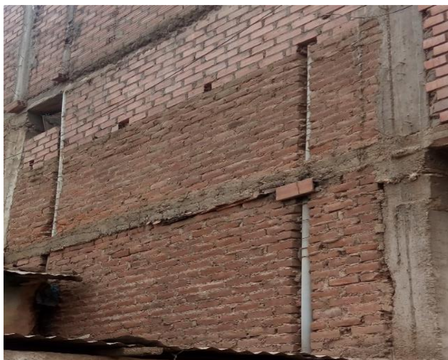
FOTOGRAFIA N° 14: Se puede apreciar que el muro de ladrillo exterior del lado izquierdo de la vivienda presenta ladrillos de distintas calidades y no se encuentran alineadas. También se pudo observar las instalaciones sanitarias expuestas a la intemperie.
