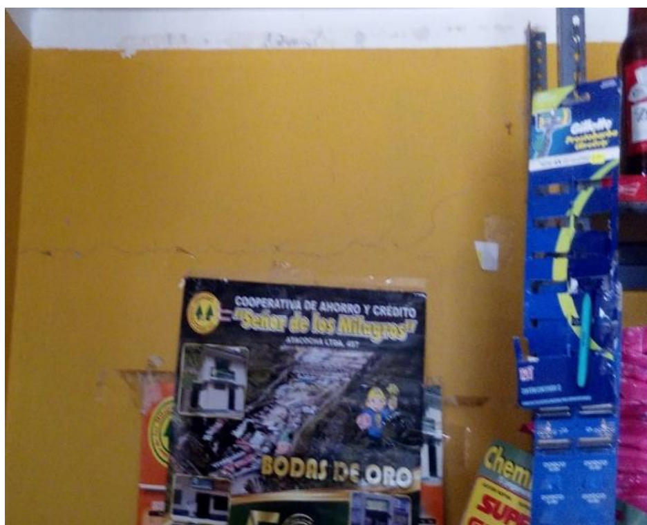
FOTOGRAFIA N° 10: Se puede apreciar una fisura en el muro de 1.50 metros aproximadamente.
