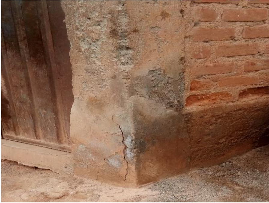
FOTOGRAFIA N° 11: Se puede apreciar la existencia de una fisura de 0.30 metros en la parte baja de una columna esquinera lado derecho. También se puede ver que los muros de la primera hilera están dañados por la erosión.
