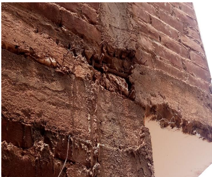
FOTOGRAFIA N° 22: Se puede apreciar la columna esquinera del segundo piso parte inferior presenta armadura expuesta a la intemperie.
