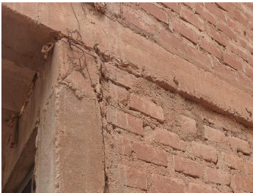
FOTOGRAFIA N° 13: Se puede apreciar la mala conexión entre muro y losa aligerada. También se pudo observar que los muros terminan al ras y no de manera dentada.
