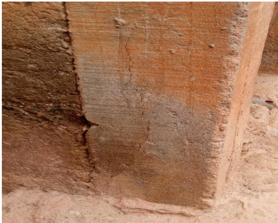
FOTOGRAFIA N° 12: Se puede apreciar la existencia de una fisura de 0.45 metros en la parte baja de una columna esquinera lado izquierda.
