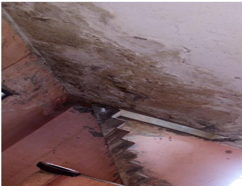
FOTOGRAFIA N° 03: Se puede apreciar fisuras en la losa aligerada y la filtración de agua de lluvia.
