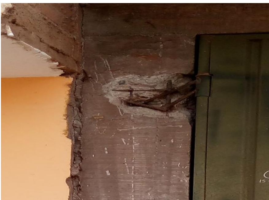
FOTOGRAFIA N° 20: Se puede apreciar columna esquinera lado izquierdo de la vivienda presenta daños por la instalación de puerta metálica, donde la armadura se encuentra expuesta.
