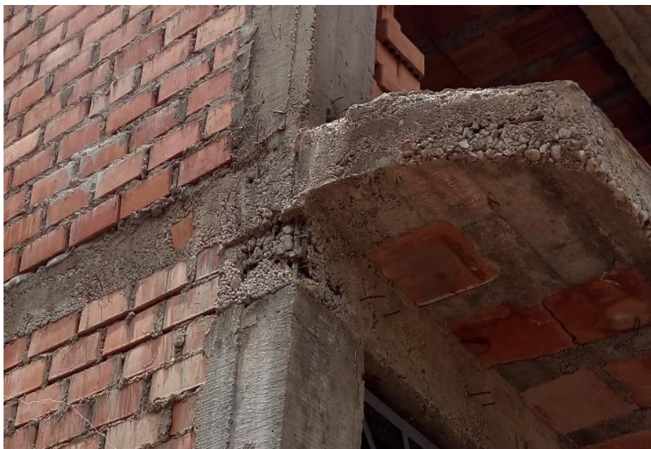
FOTOGRAFIA N° 17: Se puede apreciar la columna esquinera de la vivienda armadura expuesta a causa de la cangrejera.
