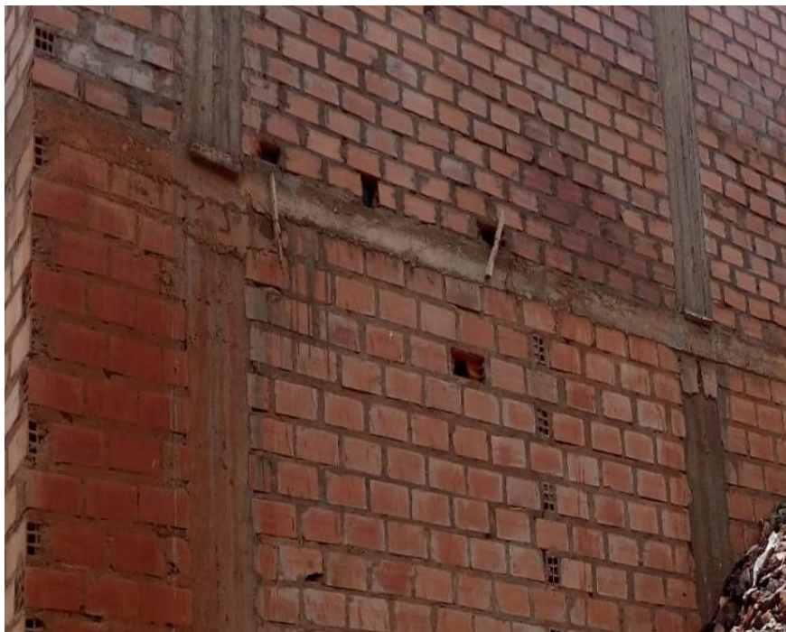
FOTOGRAFIA N° 16: Se puede apreciar el muro del lado derecho de la vivienda presenta ladrillos rotos y juntas verticales mayor a 20 mm.
