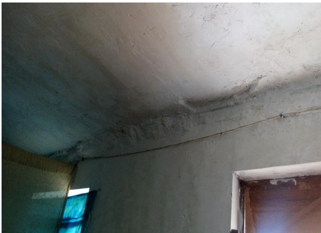
FOTOGRAFIA N° 02: Se puede apreciar la mal unión entre muro y losa aligerada y las instalaciones eléctricas no se encuentran empotradas en los muros.
