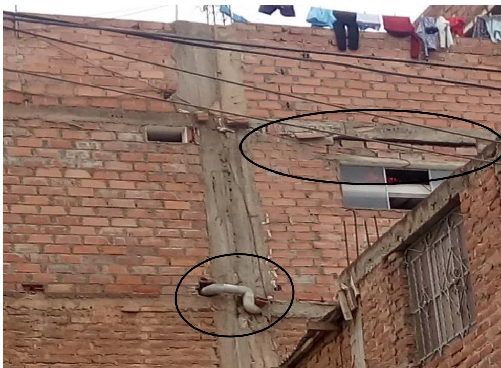
FOTOGRAFIA N° 05: Se puede apreciar que el dintel está cediendo por el peso de los ladrillos. También se puede observar que la tubería de desagüe esta fuera de la vivienda expuesta a la intemperie.
