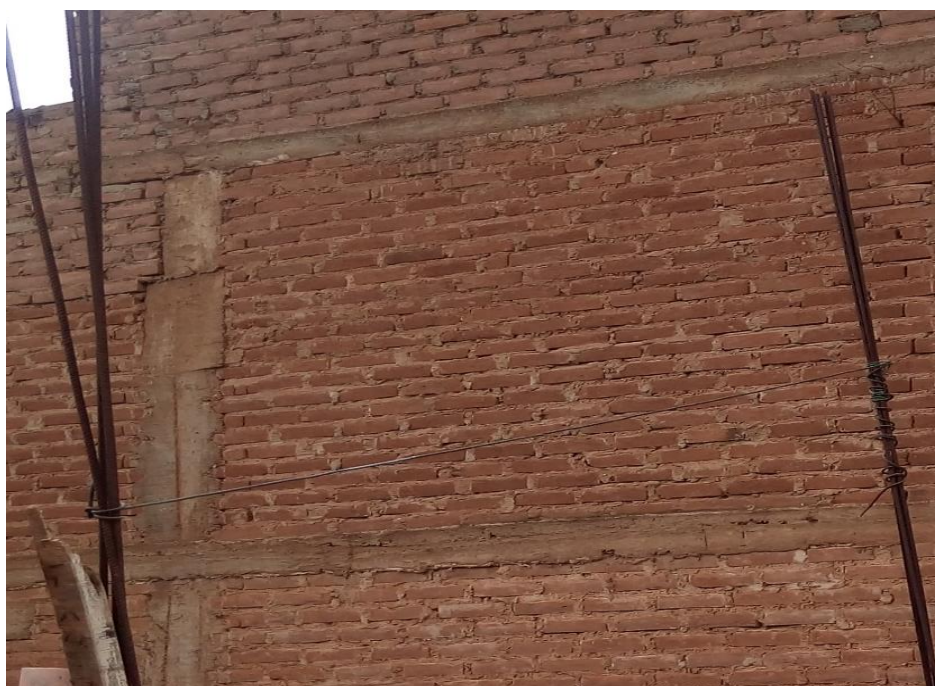
FOTOGRAFIA N° 04: Se puede apreciar que la columna del 2do Piso presenta diferente sección y el asentado de los ladrillos no están alineados.
