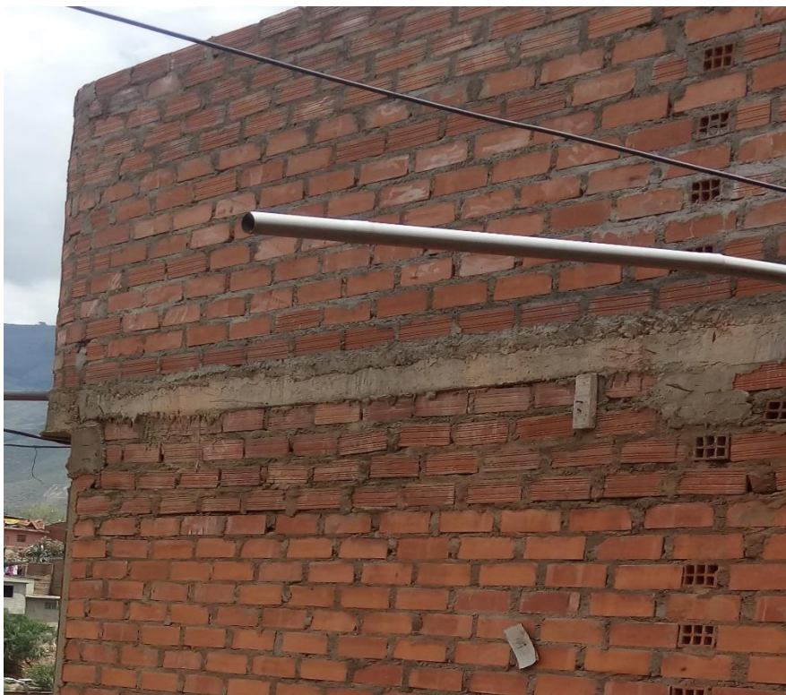
FOTOGRAFIA N° 19: Se puede apreciar el asentado del muro no se encuentra nivelado y juntas horizontales sin mortero.
