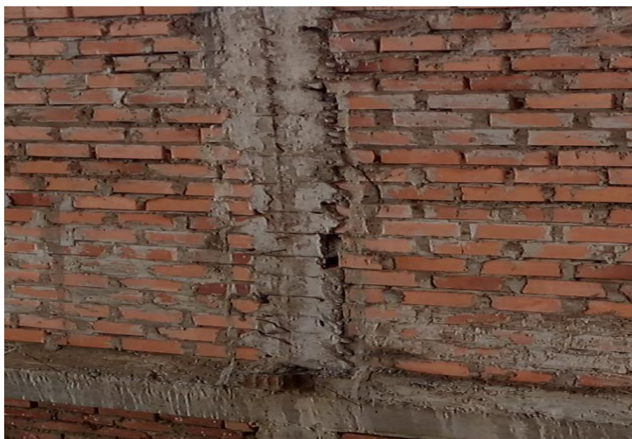
FOTOGRAFIA N° 24: Se puede apreciar la columna con estribos expuesto a la intemperie y con cangrejerías.
