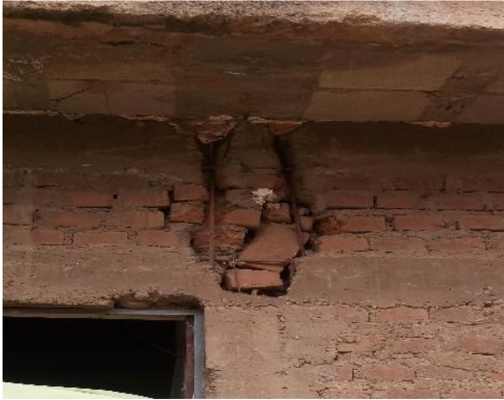
FOTOGRAFIA N° 07: Se puede apreciar que la columna no es continua hasta la viga, solo la armadura se encuentra empalmada a la viga.
