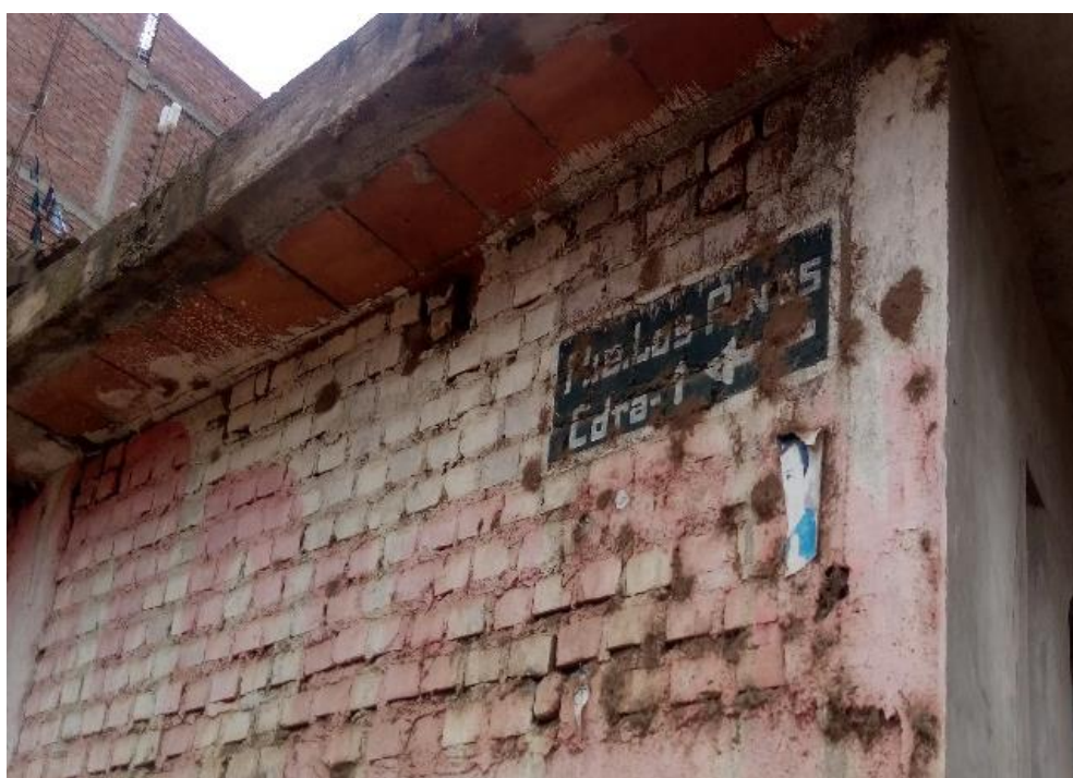
FOTOGRAFIA N° 06: Se puede apreciar la mala conexión entre el muro y la losa aligerada.
