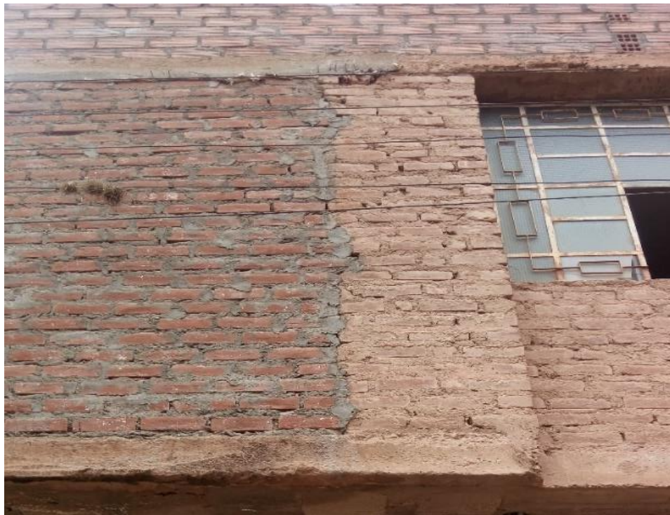
FOTOGRAFIA N° 08: Se puede apreciar que el muro de ladrillos no tiene un aparejo adecuado y se encuentran mal alineadas.
