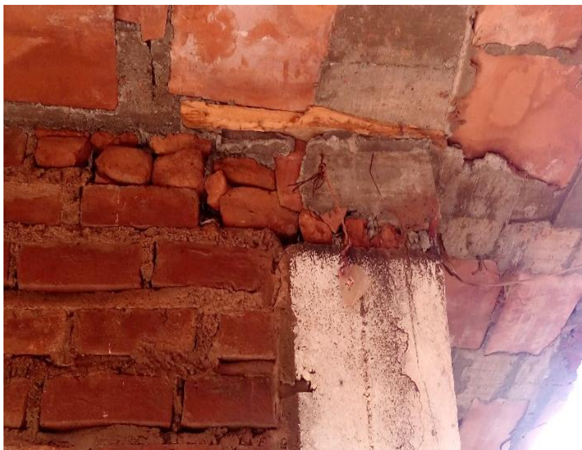
FOTOGRAFIA N° 21: Se puede apreciar que la columna del primer piso fue relleno con ladrillo, existe armadura expuesta y también la mala conexión entre muro y losa aligerada.
