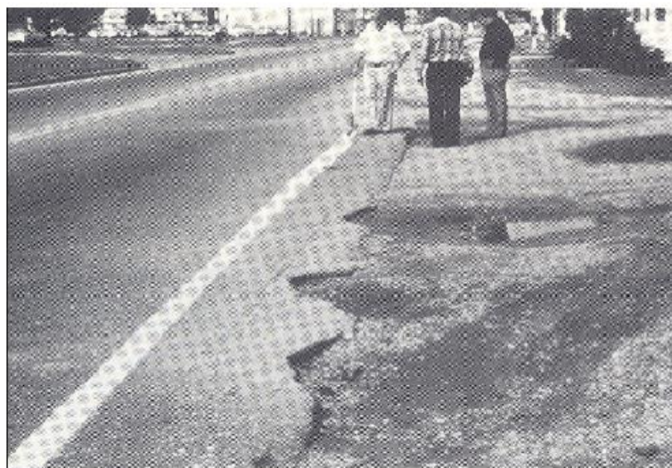
Nivel de severidad H (High:alto)
