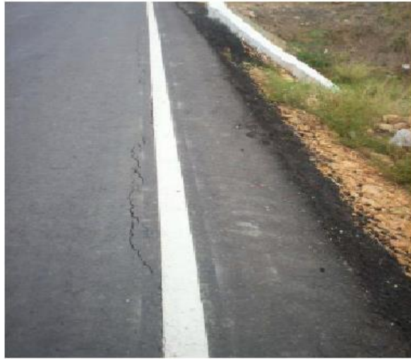
Nivel de severidad L (Low:bajo)
