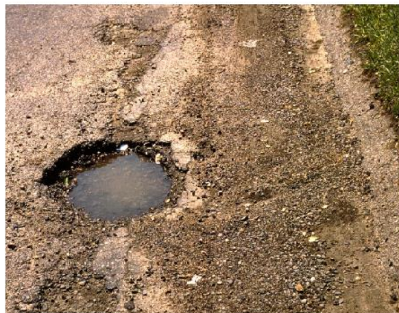
Nivel de severidad H (High:alto)
