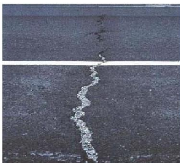
Nivel de severidad H (High:alto)
