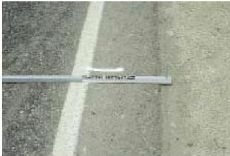
Nivel de severidad L (Low:bajo)
