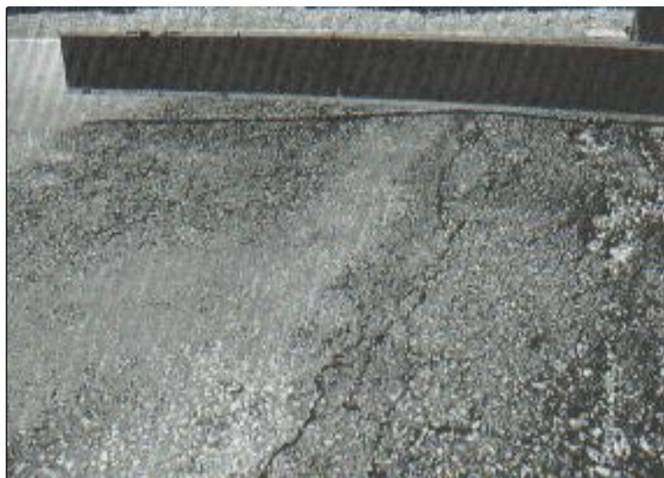
Nivel de severidad H (High:alto)
