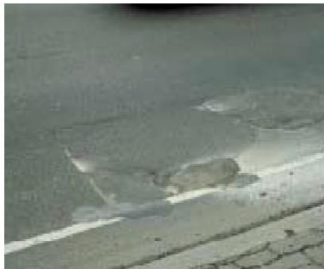
Nivel de severidad H (High:alto)
