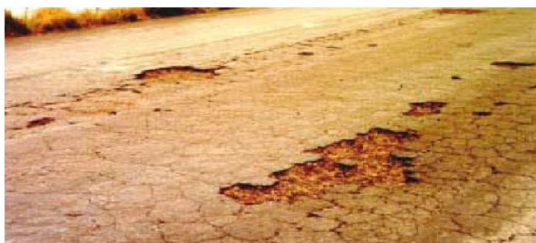
Nivel de severidad H (High:alto)
