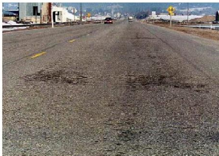
Nivel de severidad H (High:alto)
