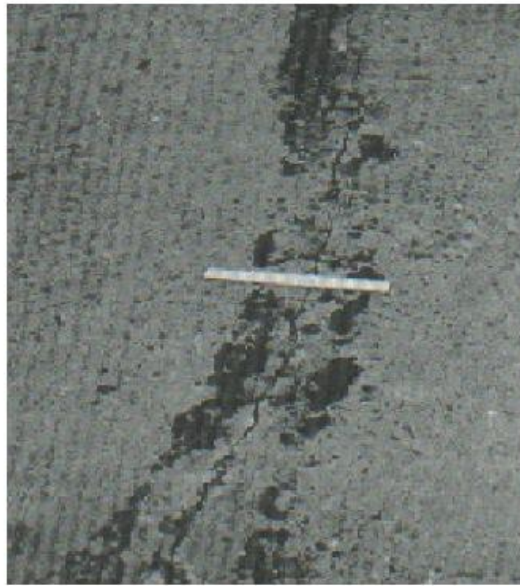
Nivel de severidad L (Low:bajo)
