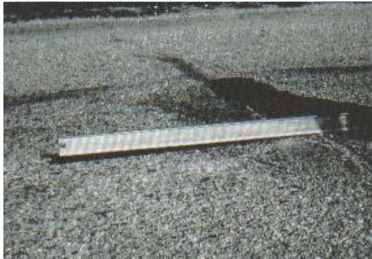
Nivel de severidad L (Low:bajo)
