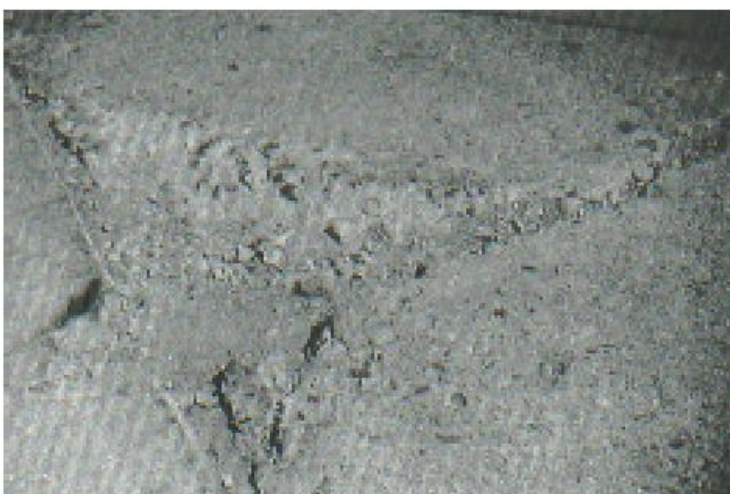
Nivel de severidad H (High:alto)
