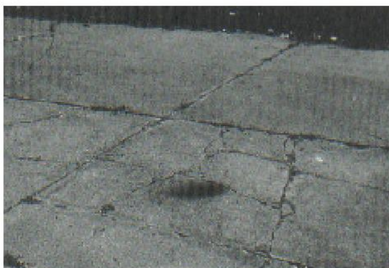
Nivel de severidad H (High:alto)
