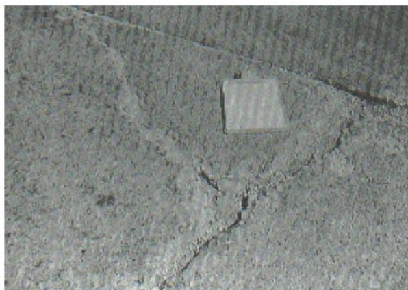
Nivel de severidad H (High:alto)
