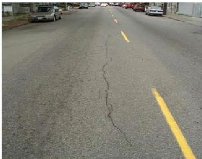
Nivel de severidad L (Low:bajo)
