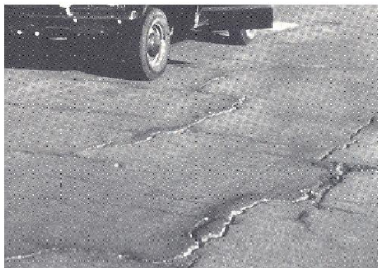
Nivel de severidad H (High:alto)
