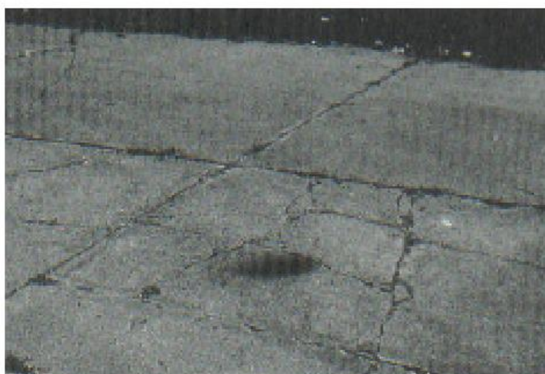
Nivel de severidad H (High:alto)
