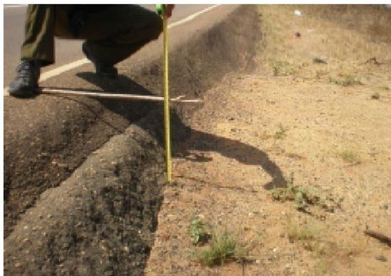
Nivel de severidad H (High:alto)
