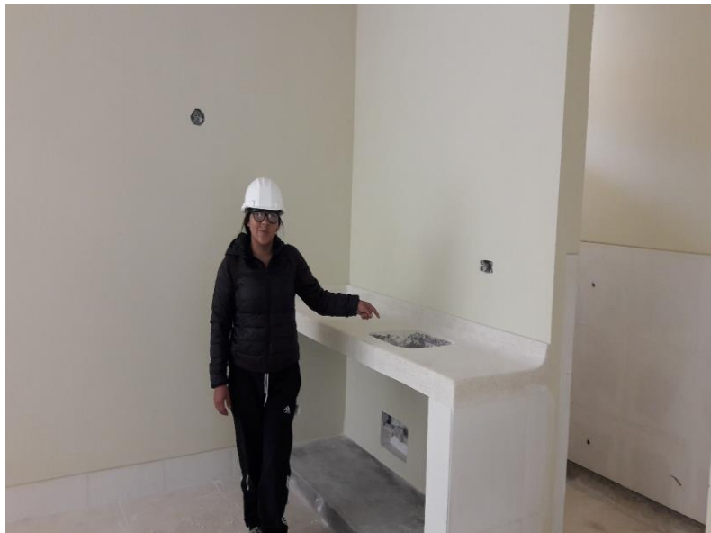
FOTO 01: En la foto se observa lavadero multiusos de granito y marmolina color crema
