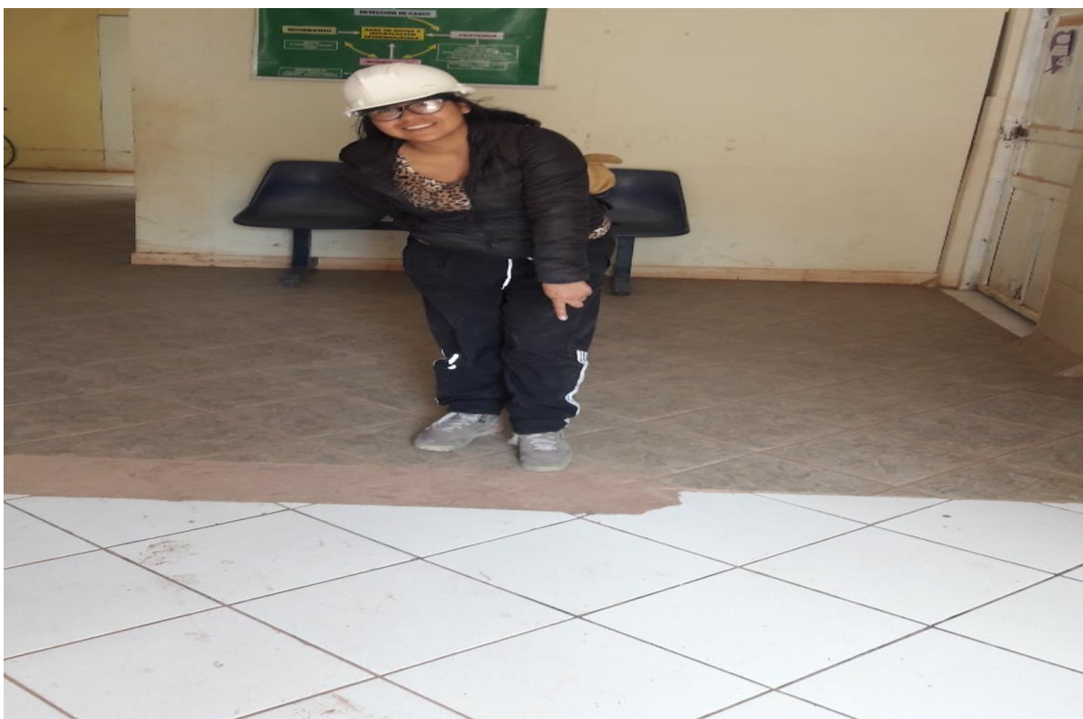
FOTO 11: en la toma se observa piso deteriorado
