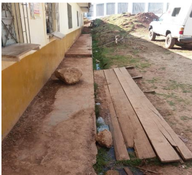
Vereda deteriorados en los alrededores del modulo
