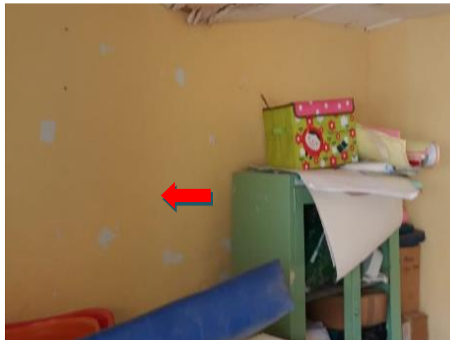
Muros interiores falta revocar
