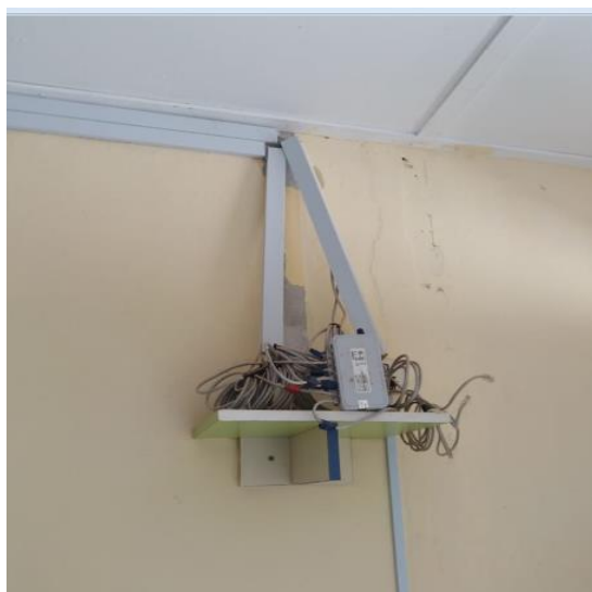
Falta de tablero de distribución
