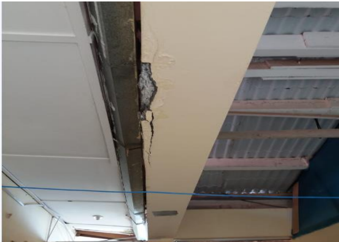
FOTO 15: en la foto se observa presencia de humedad en los muros de adobe
