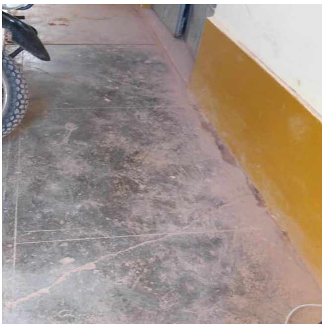
Veredas con presencia de rajaduras
