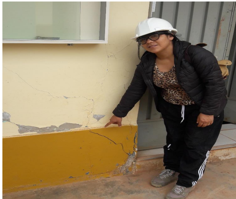
FOTO 05: En esta toma se observa que las paredes del módulo de contingencia presenta fisuras en la pared.
