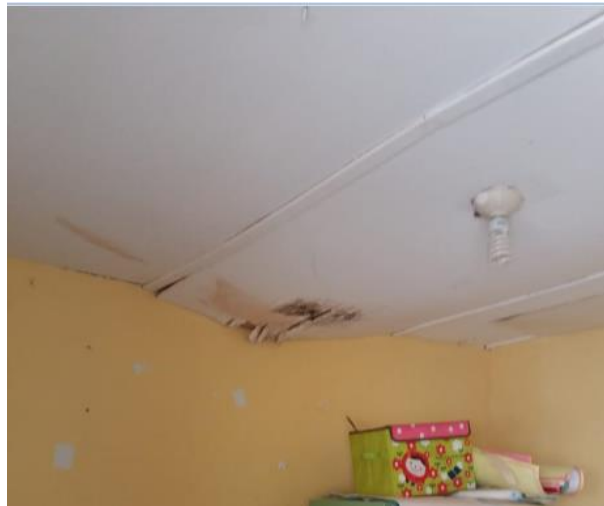
Cielo raso presenta deterioro
