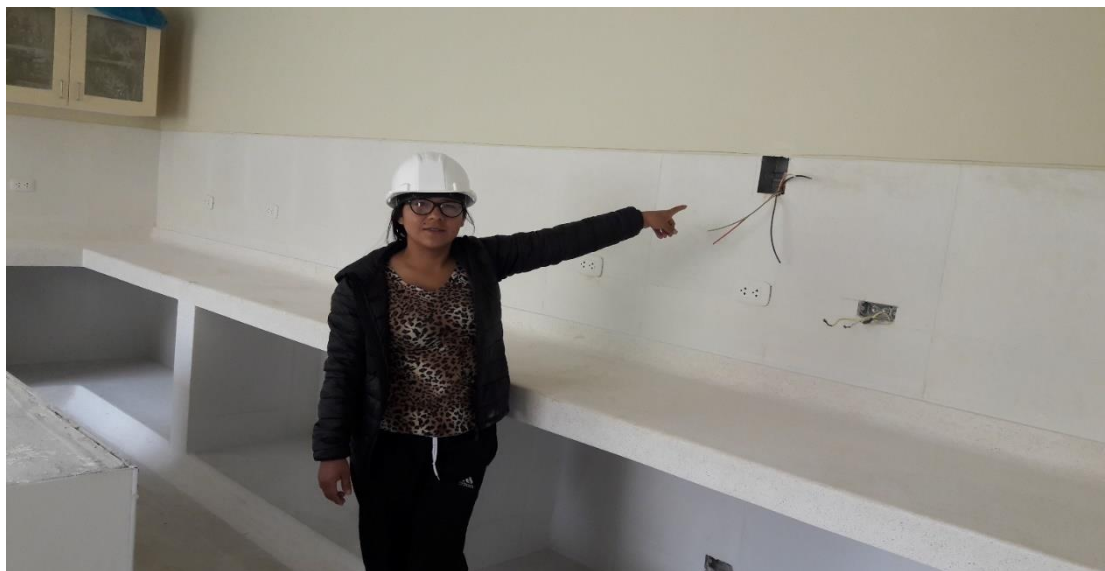
FOTO 01: en las foto se observa las cajas de los tomacorrientes serán del tipo que serán bipolar doble universal.
