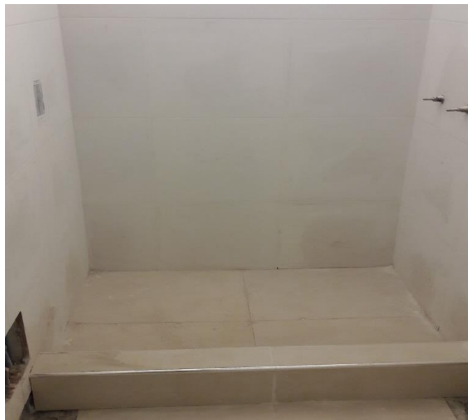
FOTO 03: En la foto se observa la Duchas de dos llaves para agua fría y caliente con grifería mezcladora cromada.
