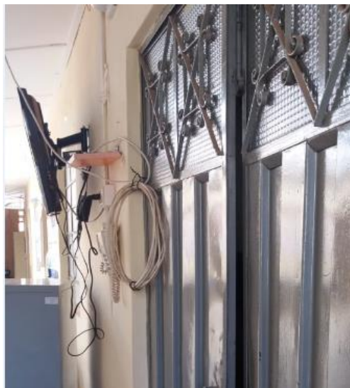
Instalaciones de equipo y cableado sin protección
