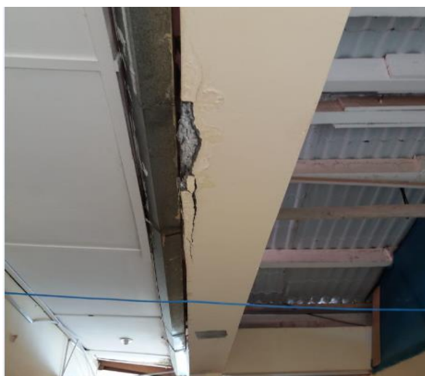
Tarrajeo deteriorado en la viga
