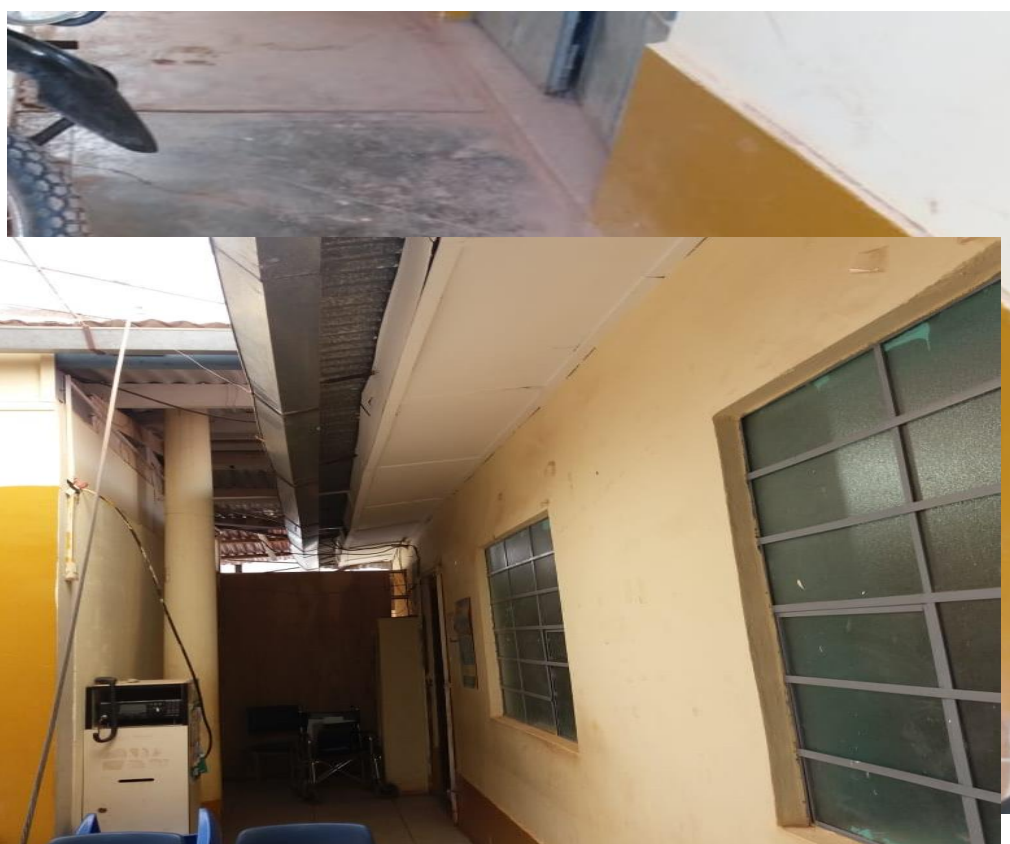
FOTO 19: Vereda deteriorados en los alrededores del módulo de contingencia
