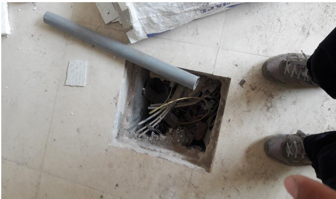
FOTO 03: En la toma se aprecia las instalaciones eléctricas subterráneas.
