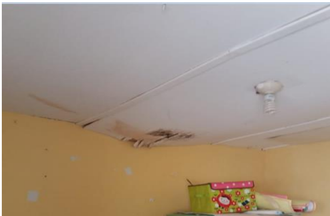
FOTO 17: Cielo raso presenta deterioro por presencia de humedad
