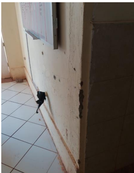
Pintura en interior está deteriorado.
