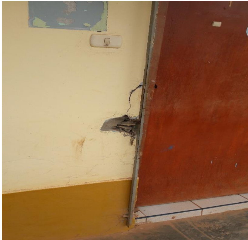
FOTO 06: En la foto que observa el estado deteriorado en la que se encuentra la pared del modulo de contingencia.
