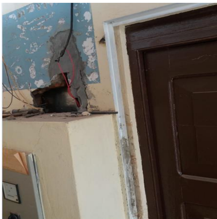
FOTO 12: se observa los Cables expuestos en el tablero de distribución.
