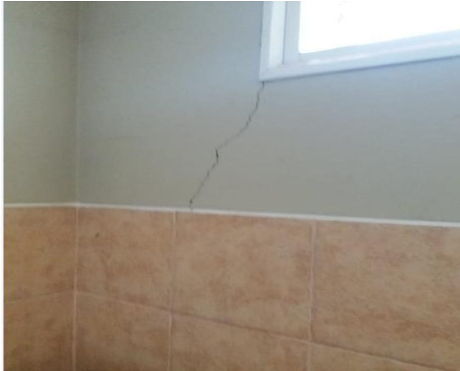
FOTO 12: En la foto se puede apreciar que el muro de ladrillo presenta fisura.
