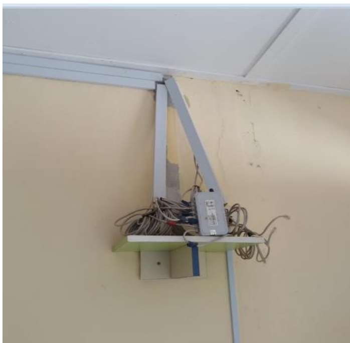
FOTO 11: se aprecia las instalaciones del sistema de internet.
