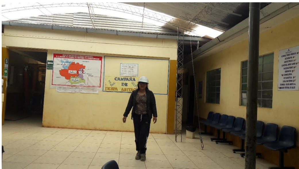
FOTO 07: En la toma se puede apreciar que la estructura metálica de la cobertura se encuentra deteriorado-ambiente sala de espera.
