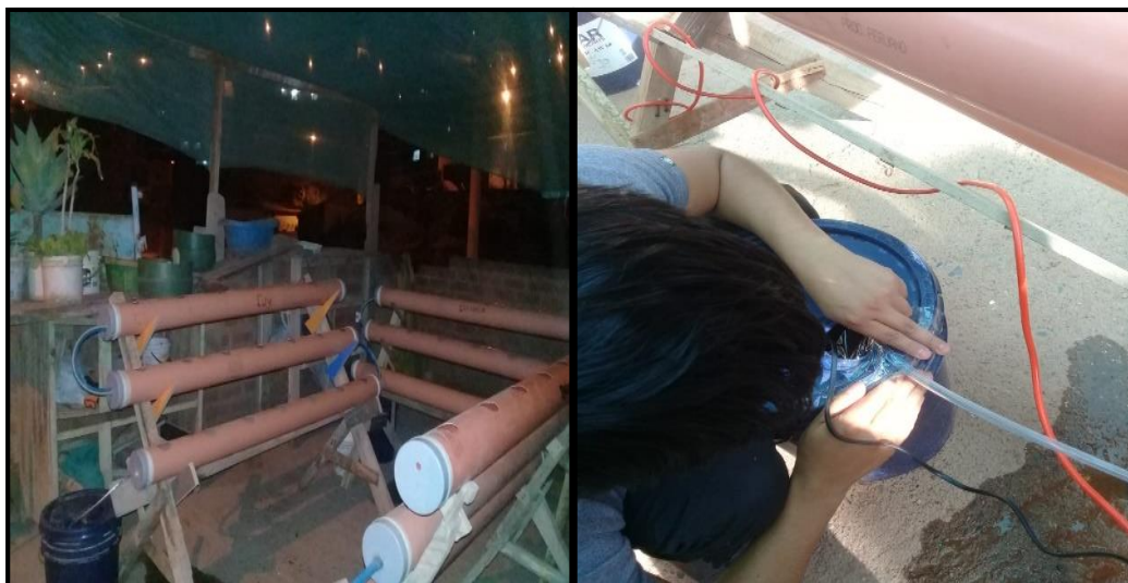
Figura 5: Instalación del sistema NFT.
