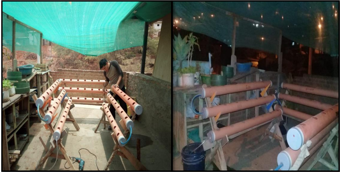
Fotografía 6: Instalación del sistema hidropónico técnica NFT.
