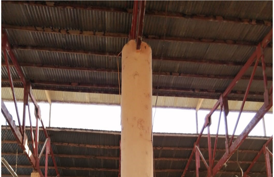
FOTO N°01- EVALUACION DEL PESO ADICIONAL A LA ESTRUCTURA DEL MERCADO ANTIGUO.
