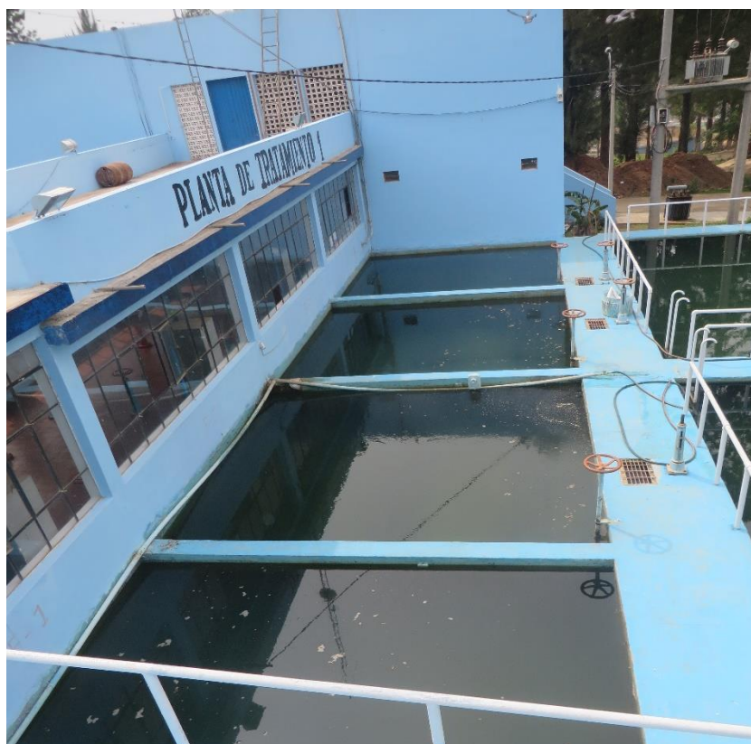
Filtros rápidos de la Planta de Tratamiento N°01
