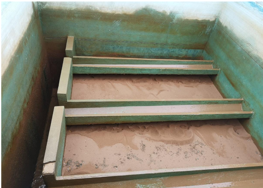
Lodos de los filtros rápidos.
