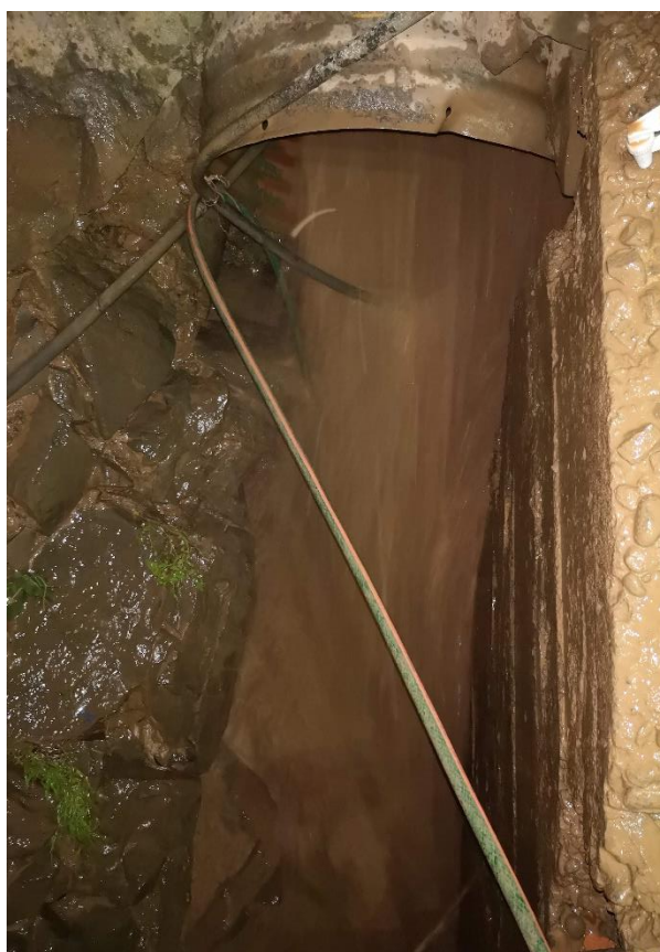
Punto de vertimiento de la Planta de Tratamiento de Cabritopampa de la EPS Seda Huánuco
