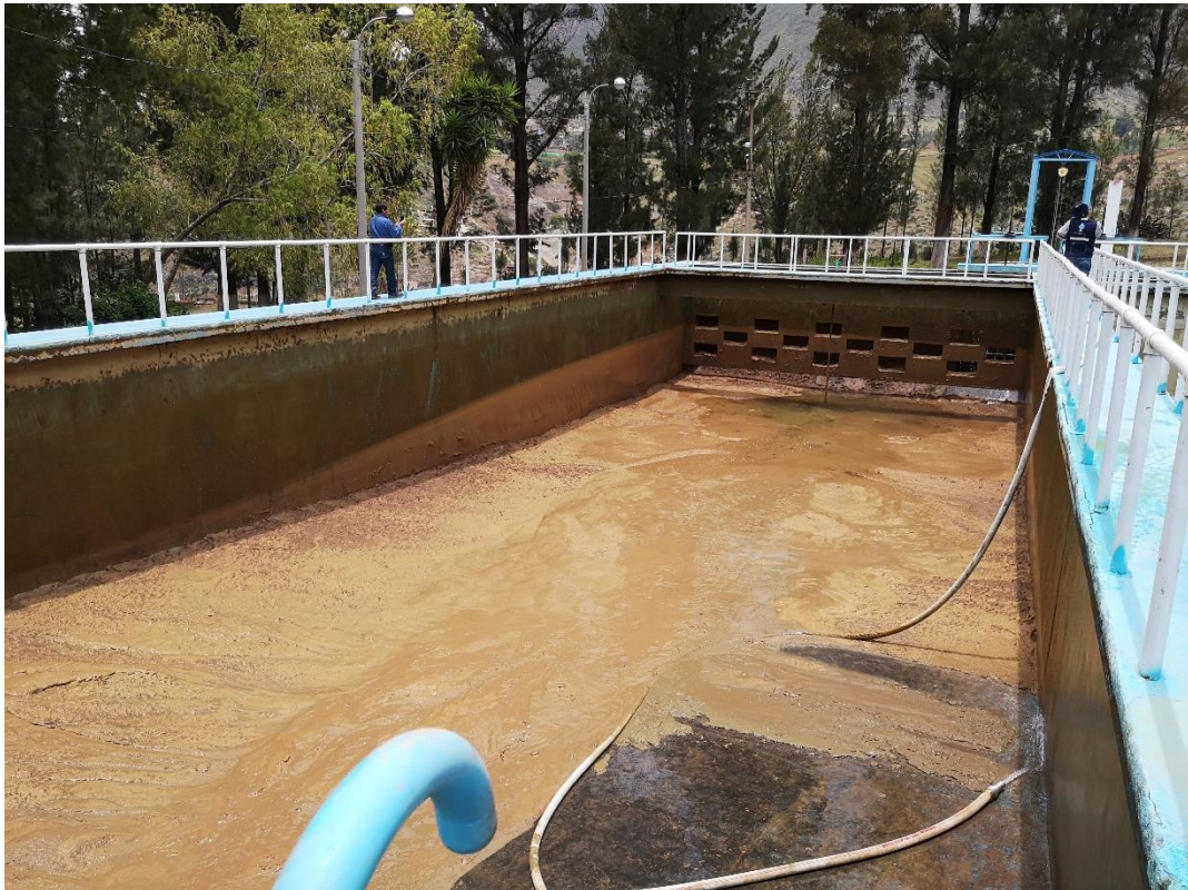
Decantador N°02 con lodos residuales de la Planta de Tratamiento N°01
