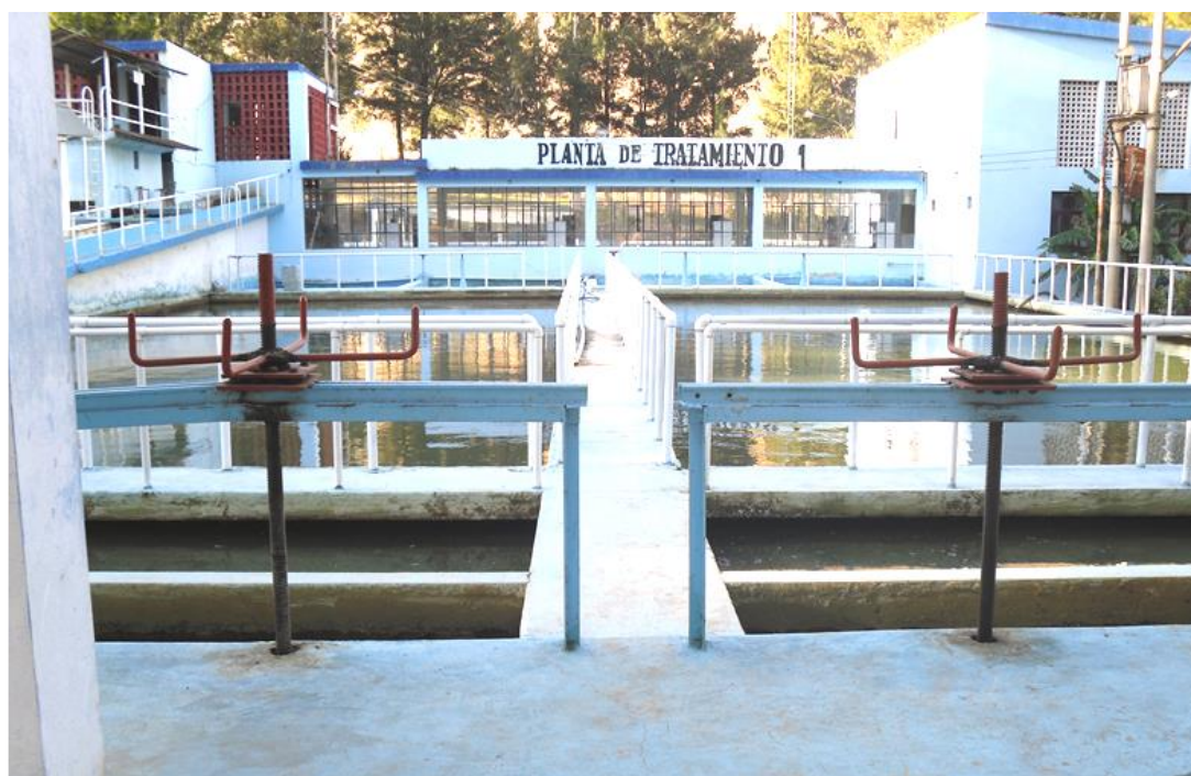
Planta de Tratamiento de agua potable N°01, cuenta con dosificador de coagulante, mezcla rápida, 02 decantadores y 04 filtros.
