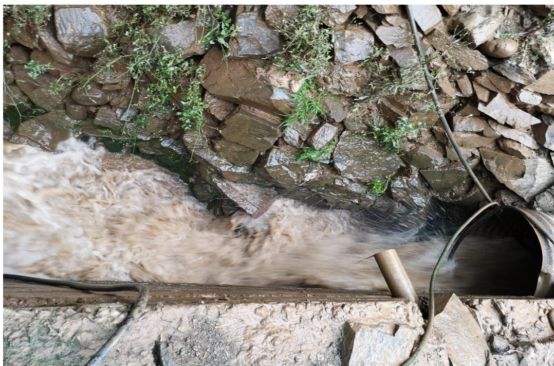
Punto de descarga de la Planta de Tratamiento de Agua Potable Cabritopampa
