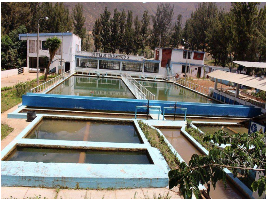
Planta de Tratamiento de agua potable N°02, cuenta con dosificador de coagulante, mezcla rápida, 02 decantadores y 04 filtros.
