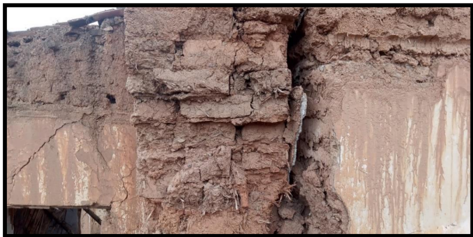
Figura 24 Imagen de parte del muro desprendidos y agrietados.
