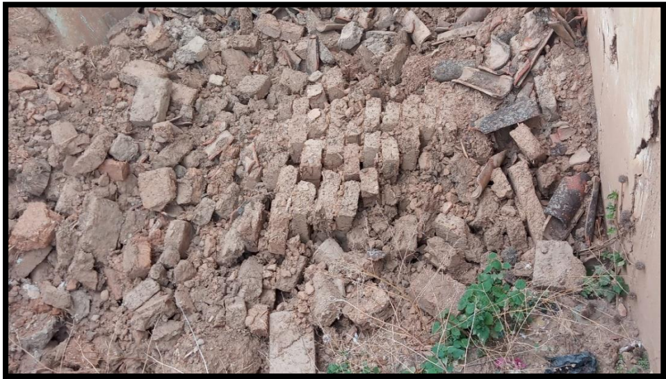
Figura 27 Imagen que evidencia la perdida y erosión de los adobes.
