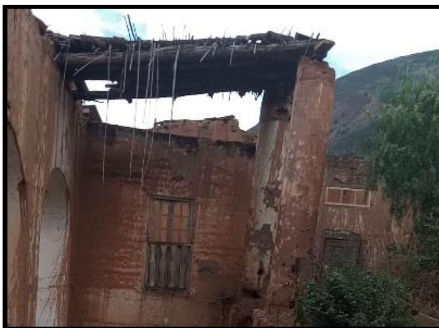
Figura 26 Imagen que evidencia la pérdida de la cubierta.
