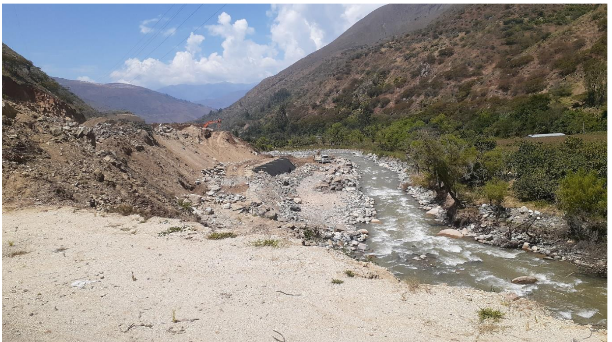
En esta imagen se aprecia el material excedente de la carretera a la orilla del rio.
