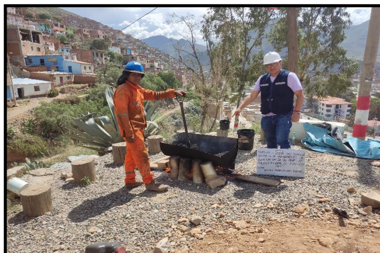
Se observa el calentamiento del asfalto para el sellado de juntas de dilatación
