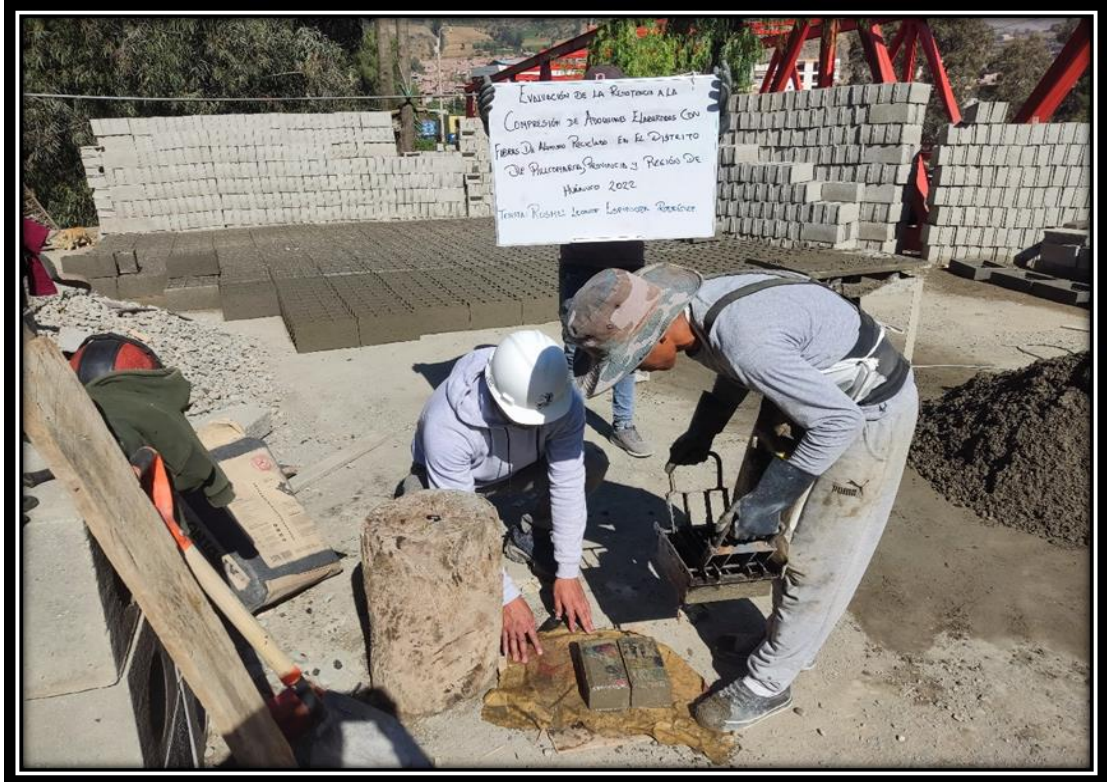
SE OBSERVA EL MOLDE DEL ADOQUINADO
