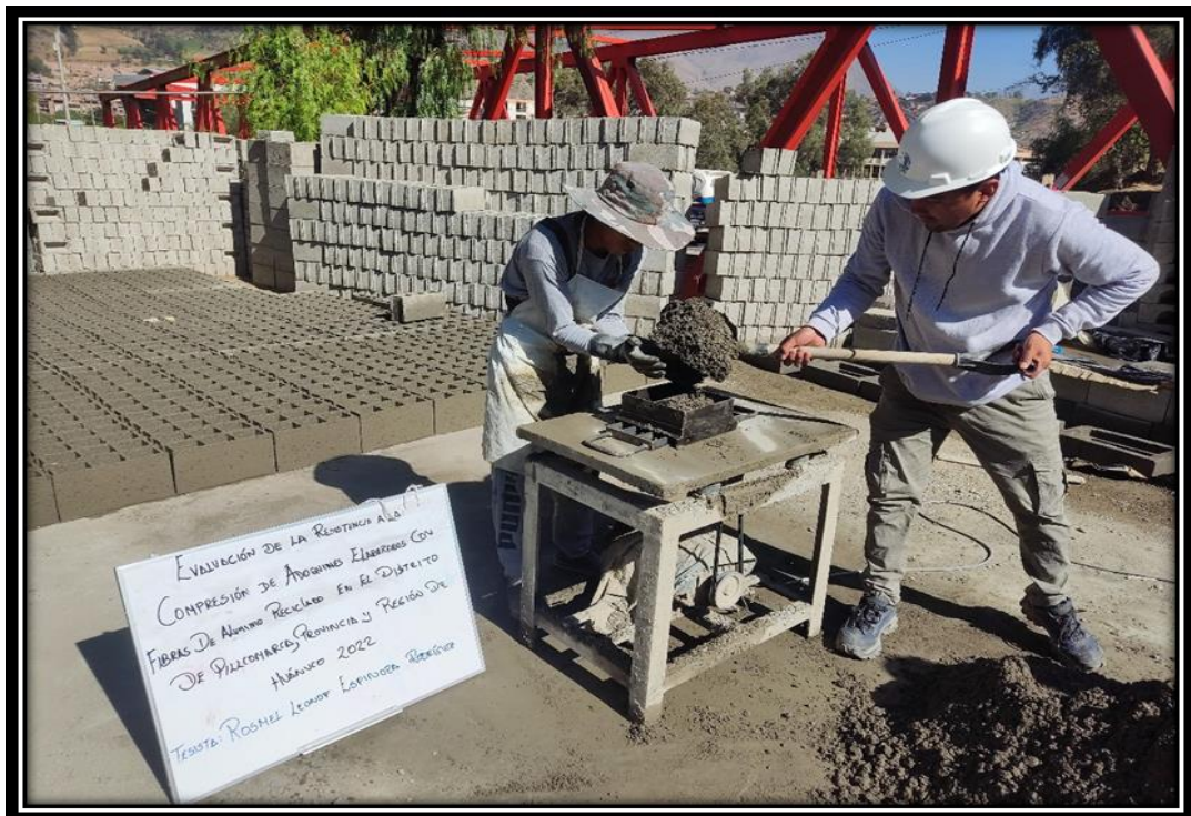
SE OBSERVA EL DISEÑO DE MEZCLA DEL AGREGADO CON EL ALUMINIO RECICLADO
